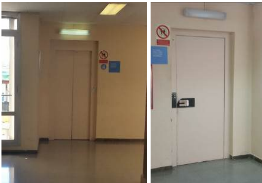
Vista frontal dels ascensors, amb RAE 61341-B (esquerra) i 61342-B (dreta)
