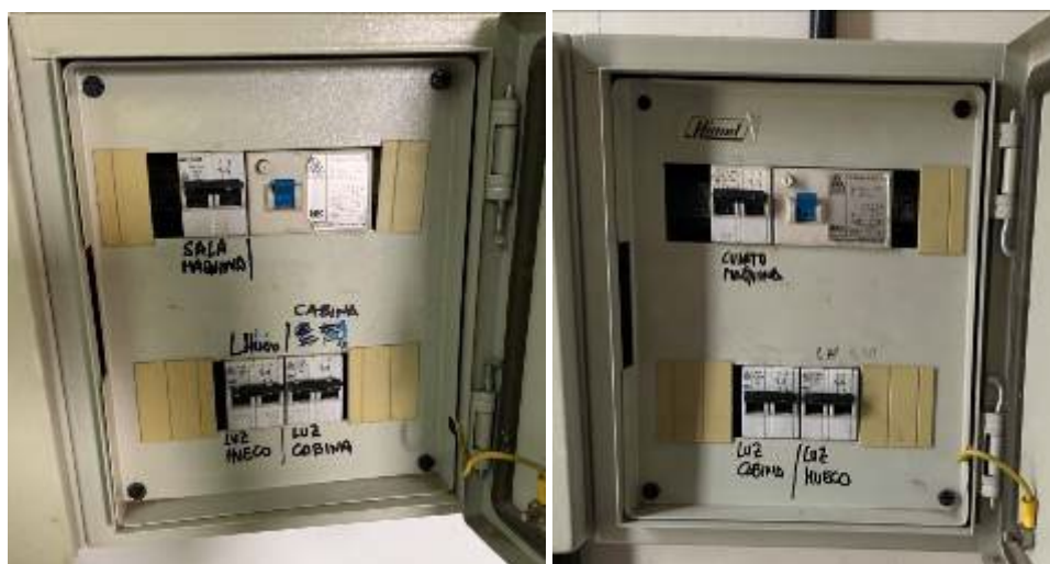
Quadre elèctric de la sala de màquines, amb RAE 61341-B (esquerra) i 61342-B (dreta)
