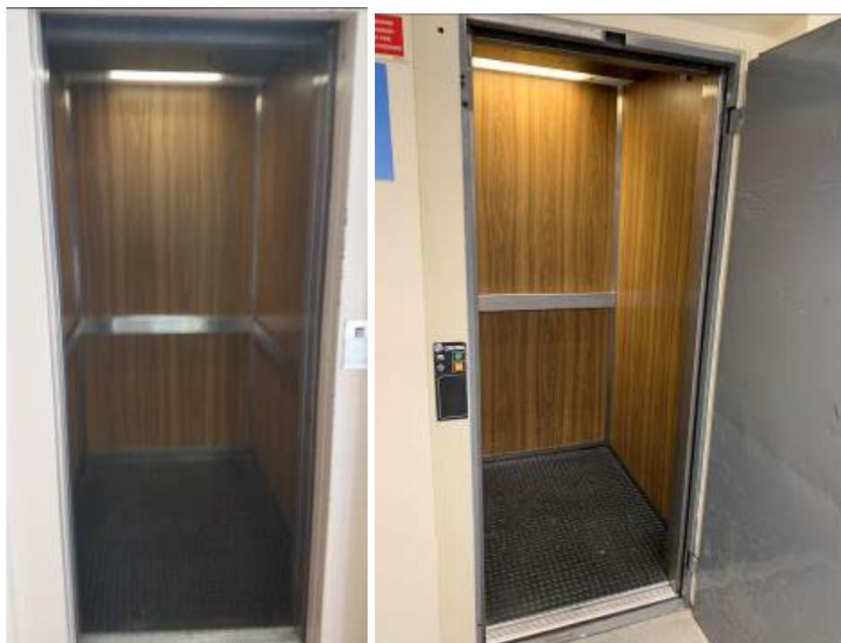
Vista interior de la cabina, amb RAE 61341-B (esquerra) i 61342-B (dreta)
