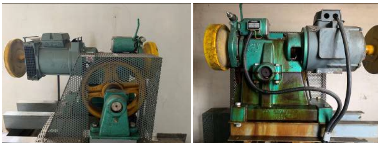
Detall dels grups tractors amb reductors actuals, amb RAE 61341-B (esquerra) i 61342-B (dreta)
