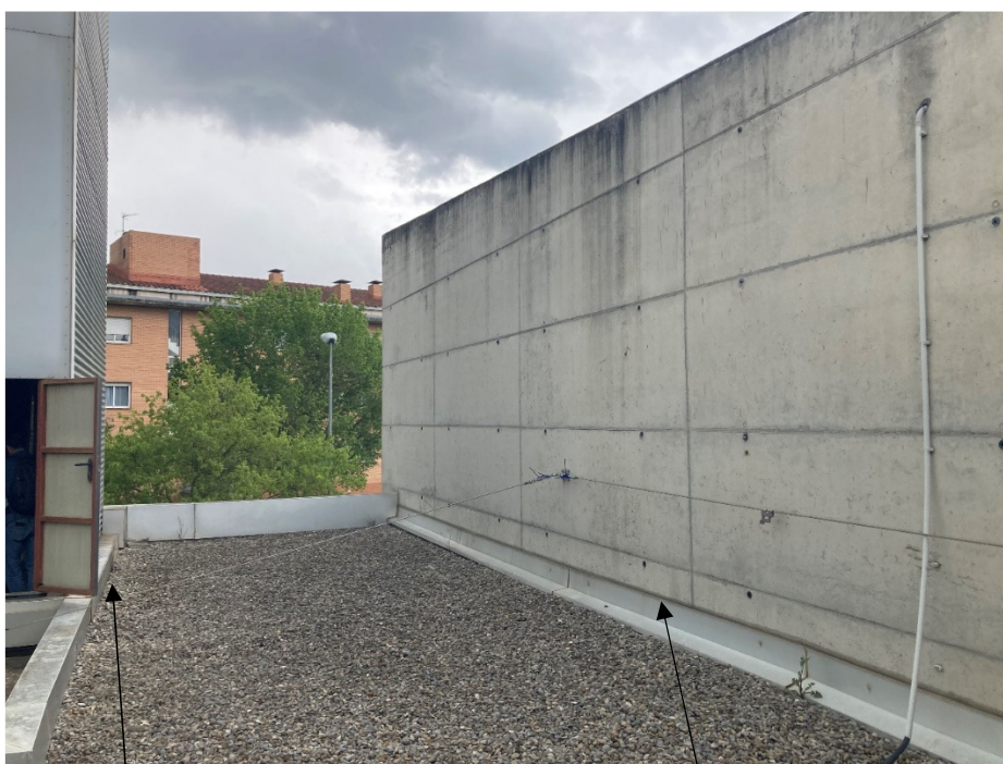
Foto 6. Detall coberta plana ubicació inversors i quadres CC+CA
