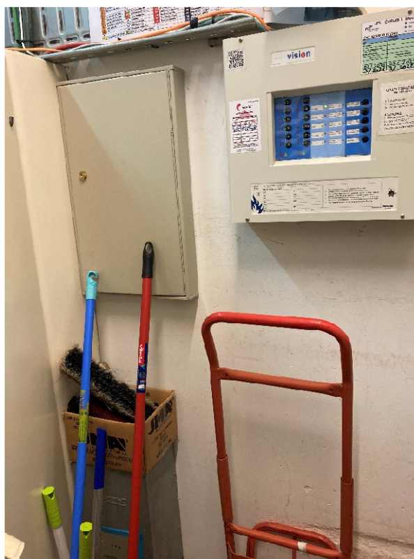
Foto 13. Detall ubicació caixa doble aïllament allotjament equips monitorització
