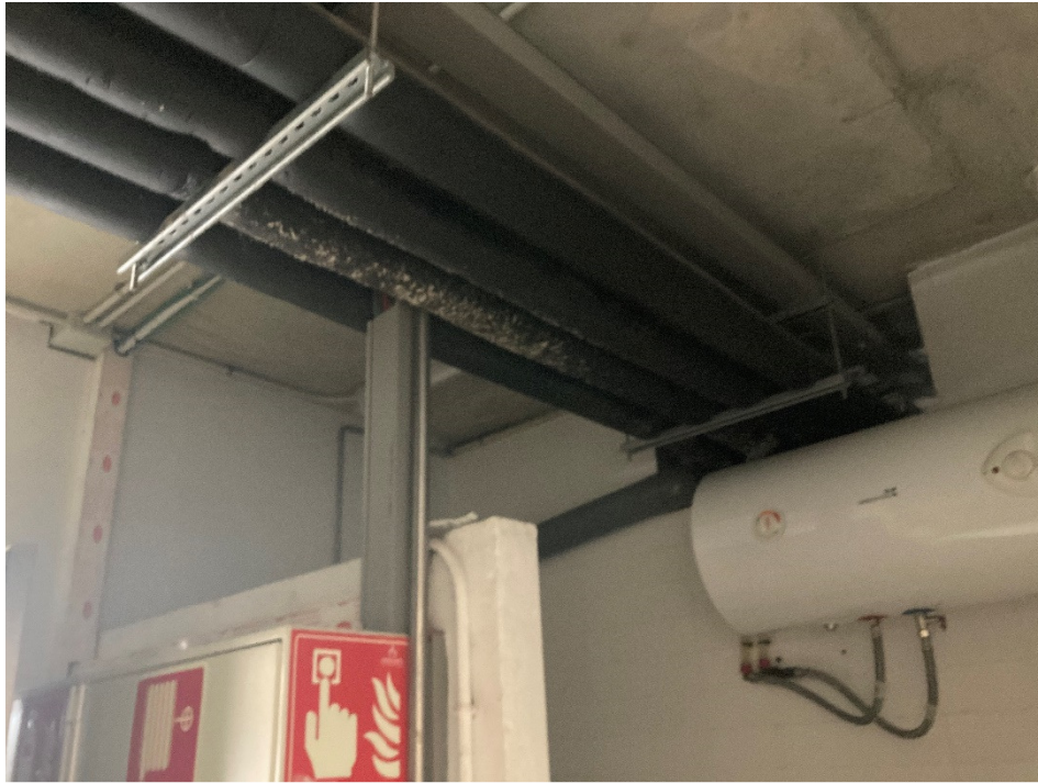
Foto 9. Detall entrada conductes i canalitzacions des del cancell magatzem cuina
