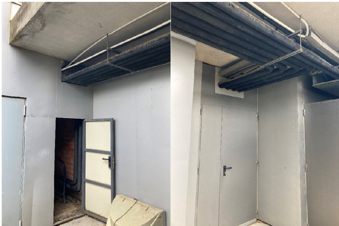
Foto 8. Detall sortida conductes des de cos xemeneia i d'entrada a l'interior edifici (cancell magatzem cuina) pel passadís exterior
