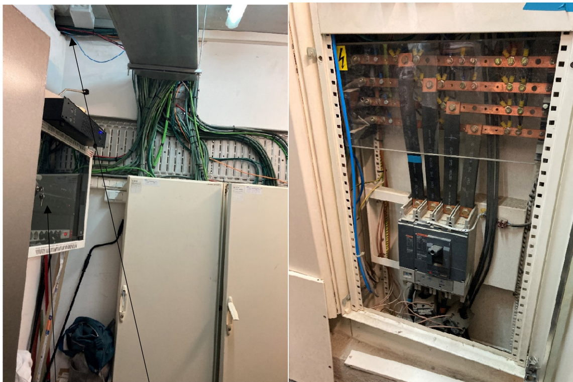
Foto 12. Detalls quadre elèctric general
