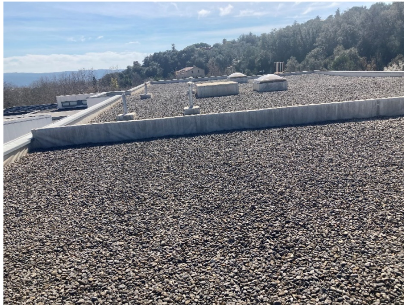
Foto 1. Tram sud de coberta ubicació panells solars
