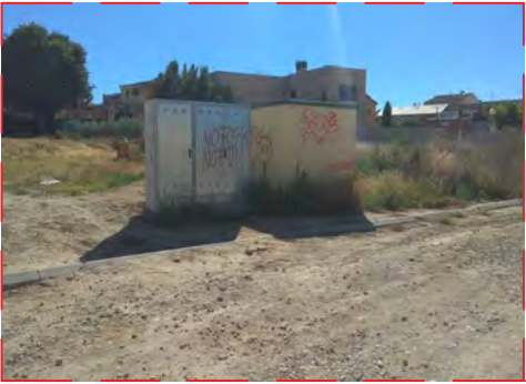
Quadre parcel·la escoles amb TRAFO
