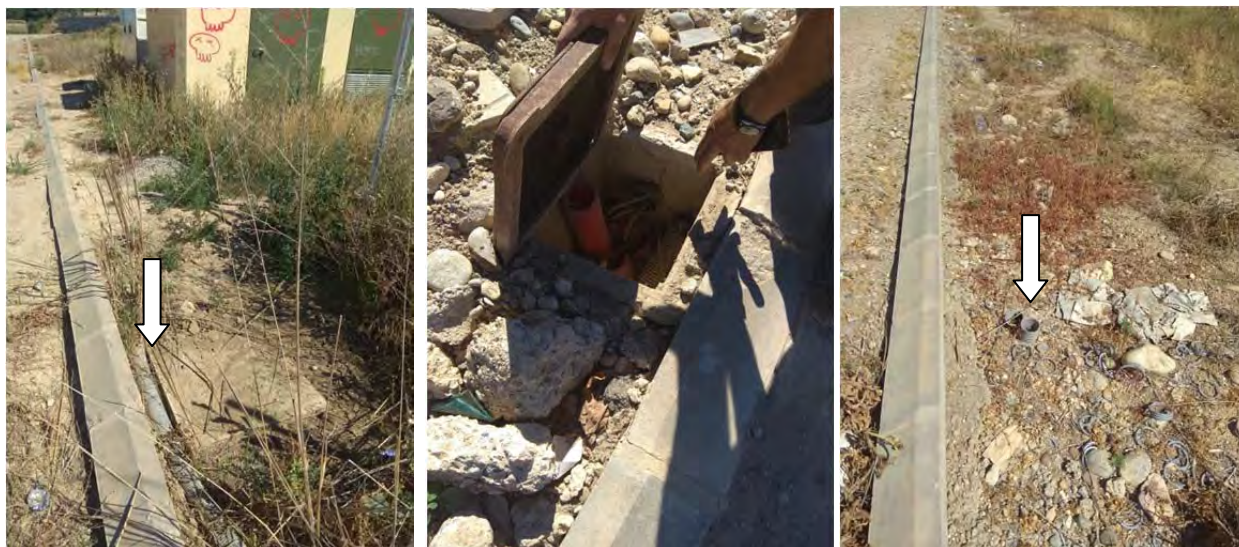
Imatges de diferents punts on s'observa l'existència d'una canonada de reserva per enllumenat al C. Sindicat
