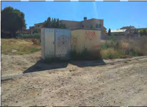
Quadre parcel·la escoles amb TRAFO
