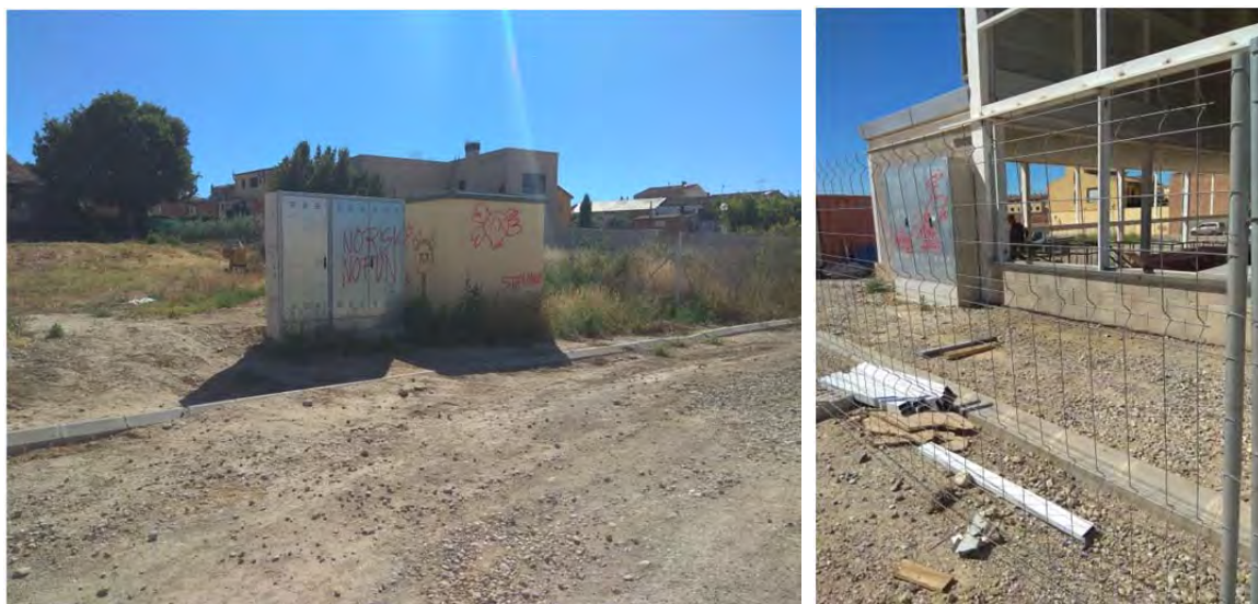
Vista quadre parcel·la escoles amb TRAFO (esquerra) i quadre pavelló poliesportiu (dreta)
