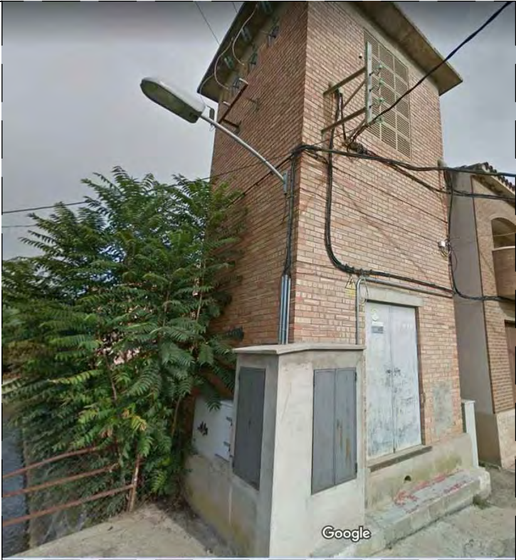
Imatge Estació transformadora (transformador WB610)
