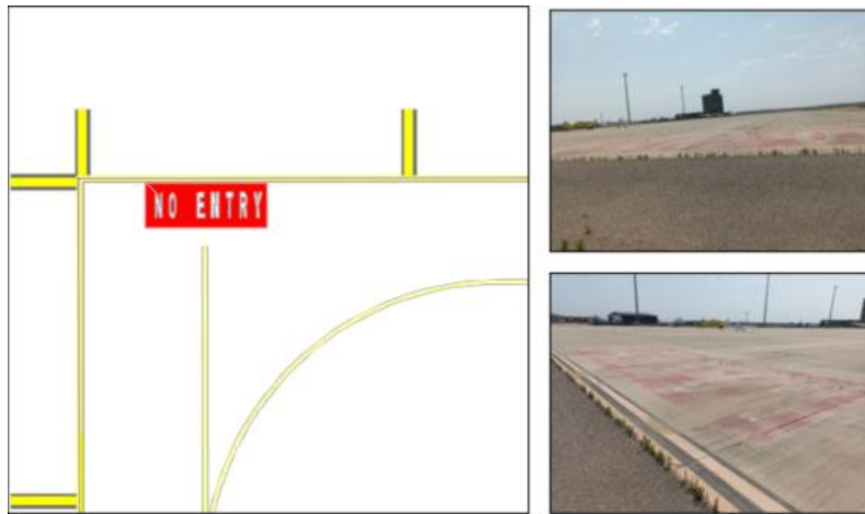
Imatge 9. Estat actual "NO ENTRY" a repintar
