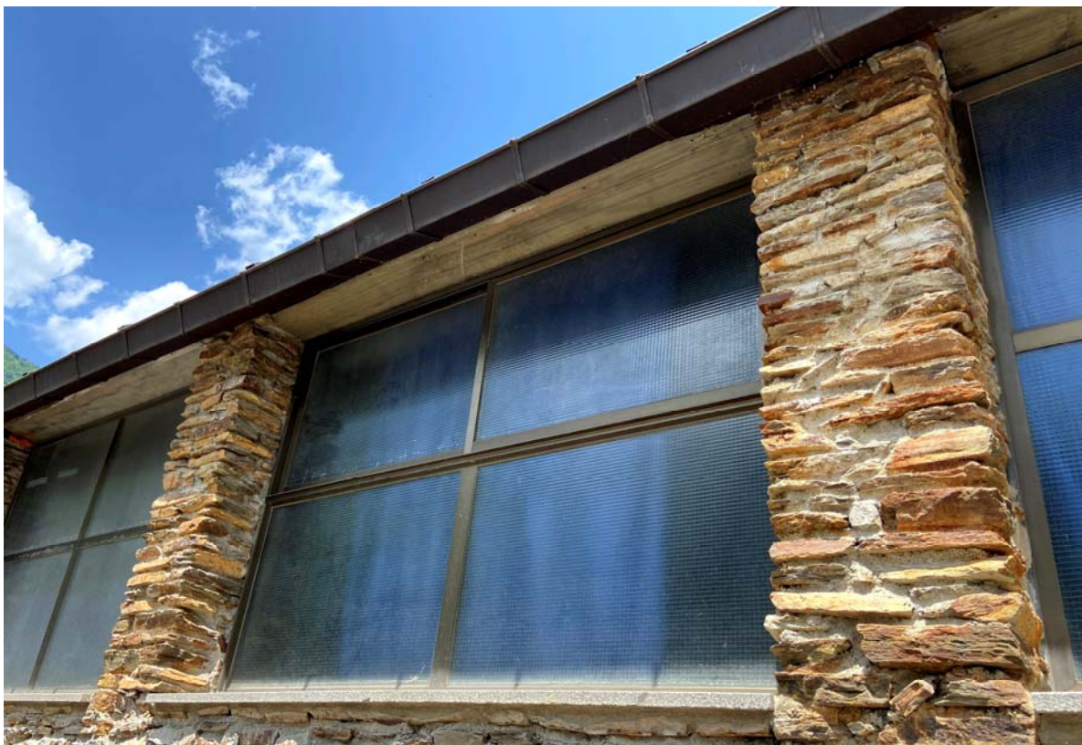
Imatge 07. Estat dels tancaments (finestres) des de l'exterior.
