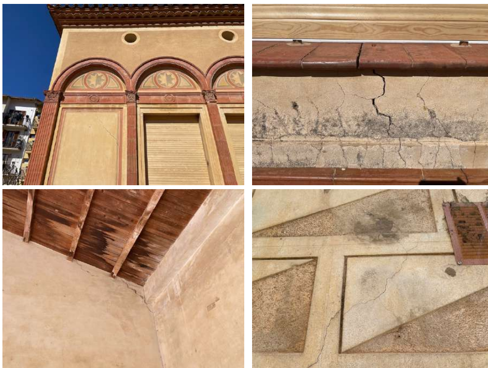
Fotografies detall de les fissures i esquerdes
