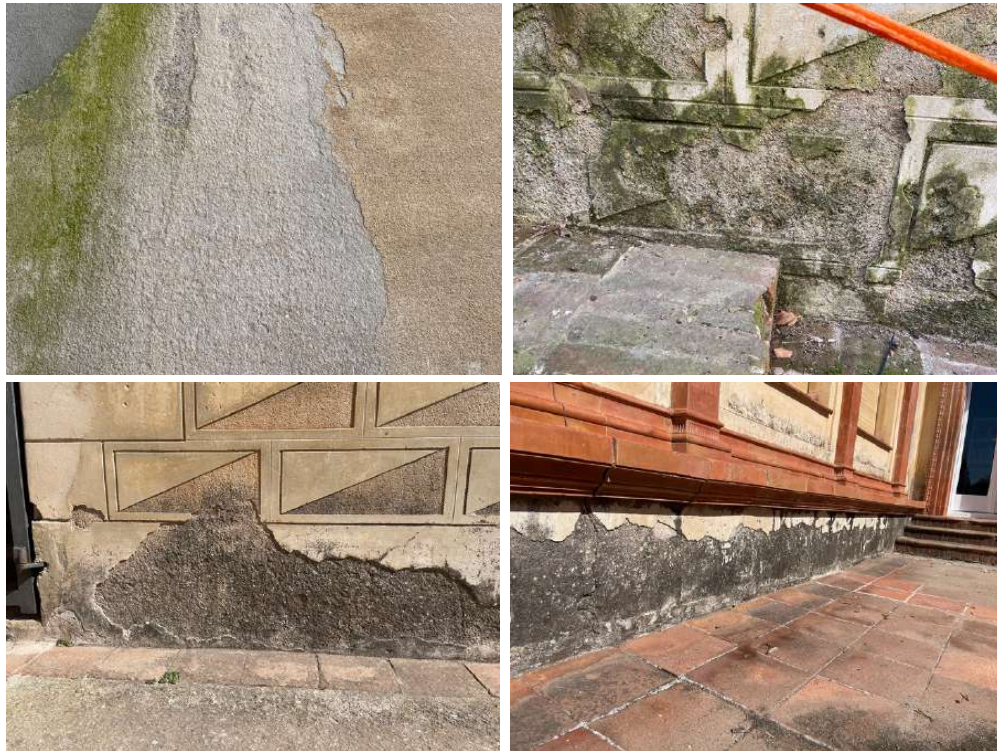
Fotografies detall de la disgregació del revestiment
