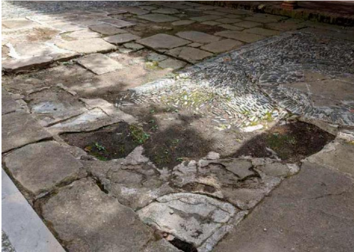
5. Paviment enllosat i empedrat en mal estat
