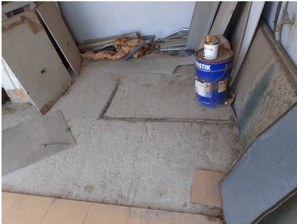
Imatge 12. Zona sense paviments i sense impermeabilitzar.
