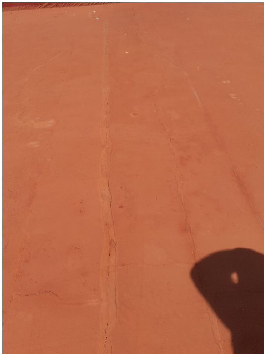
Imatge 8. Capes desadherides i fissurades
