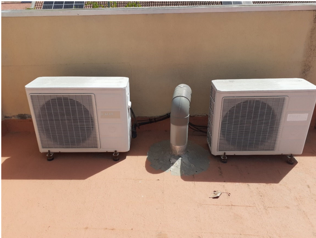
Imatge 16. Màquines recolzades directament sobre coberta
