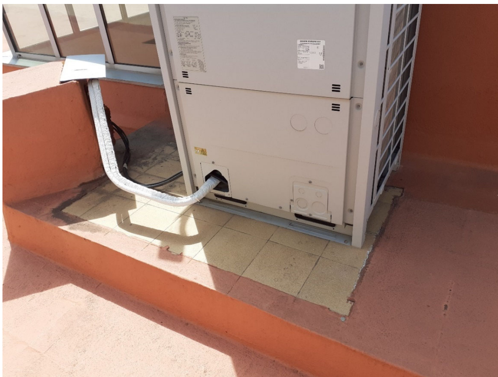
Imatge 10. Bancada sense impermeabilitzar
