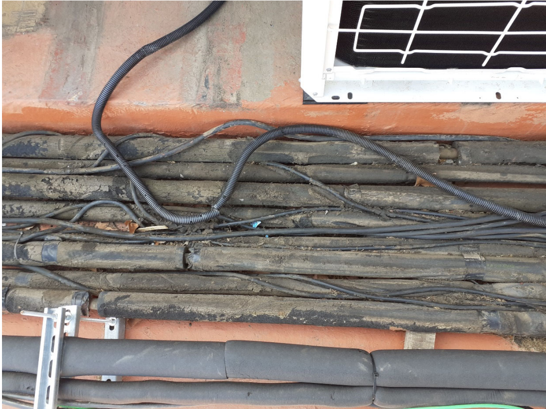
Imatge 14. Tubs frigorífics per terra amb aïllant deteriorat
