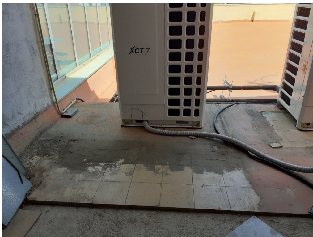
Imatge 11. Bancada sense impermeabilitzar
