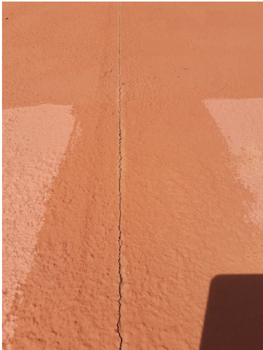
Imatge 4. Capa fissurada
