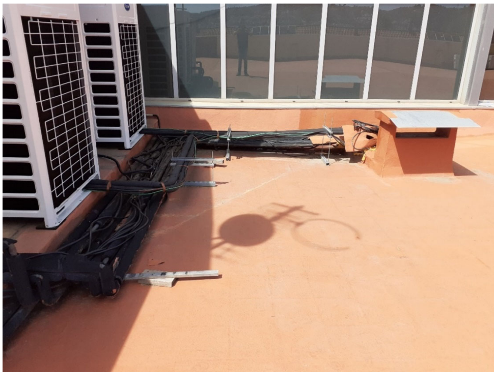
Imatge 13. Màquines recolzades directament a la bancada i tubs frigorífics a terra amb aïllant deteriorat
