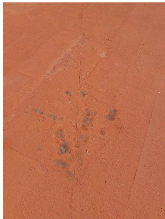
Imatge 9. Capes desadherides i fissurades
