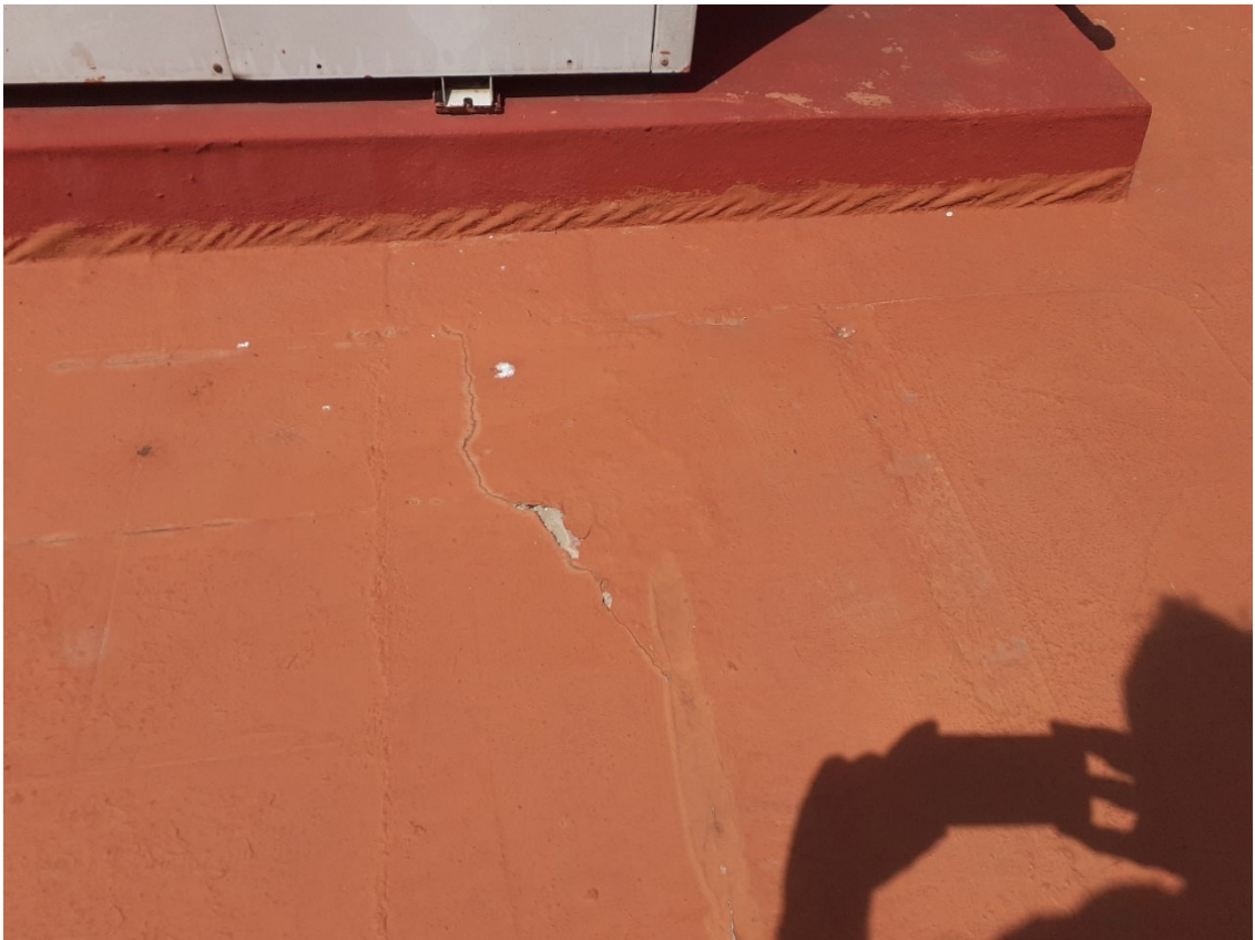
Imatge 7. Capes desadherides i fissurades
