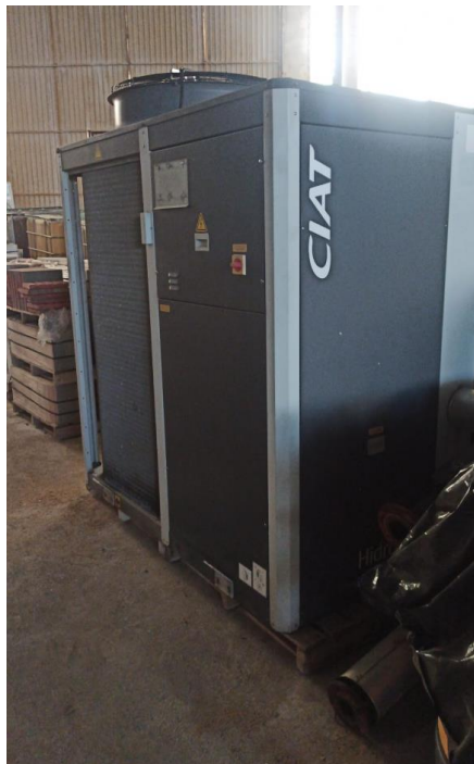
Refredadora existent avariada CIAT Hidropack
