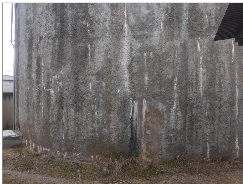
Figura 6. Vista filtracions parets dipòsit capçalera
