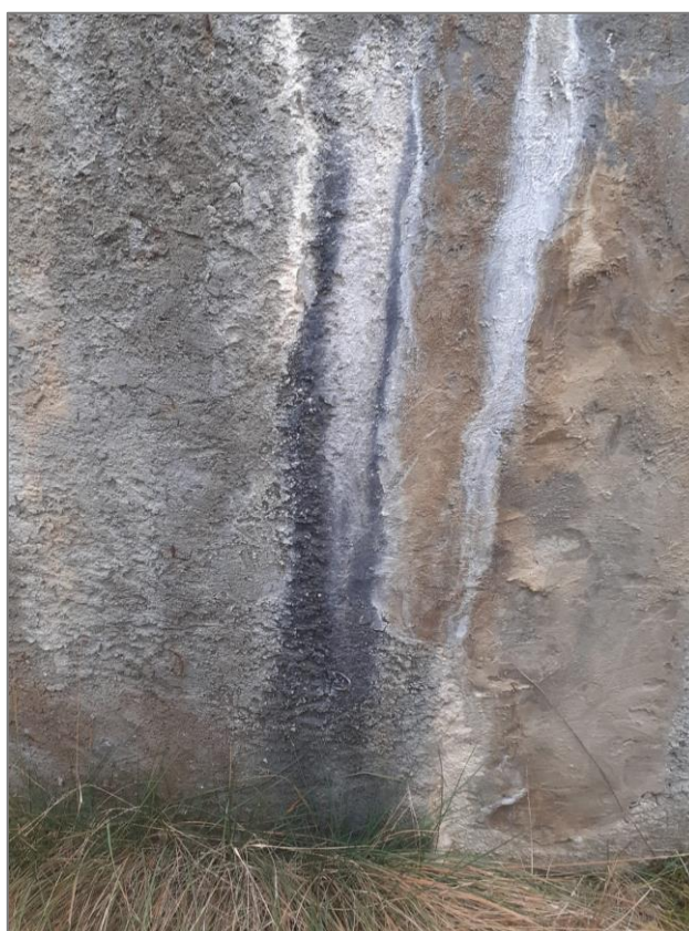
Figura 8. Vista filtracions paret exterior dipòsit capçalera
