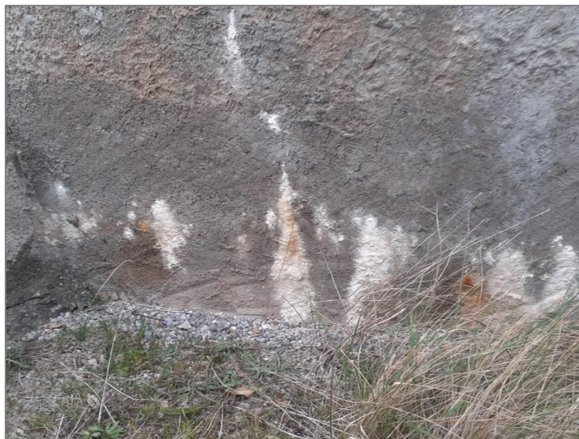
Figura 7. Vista filtracions part inferior dipòsit capçalera
