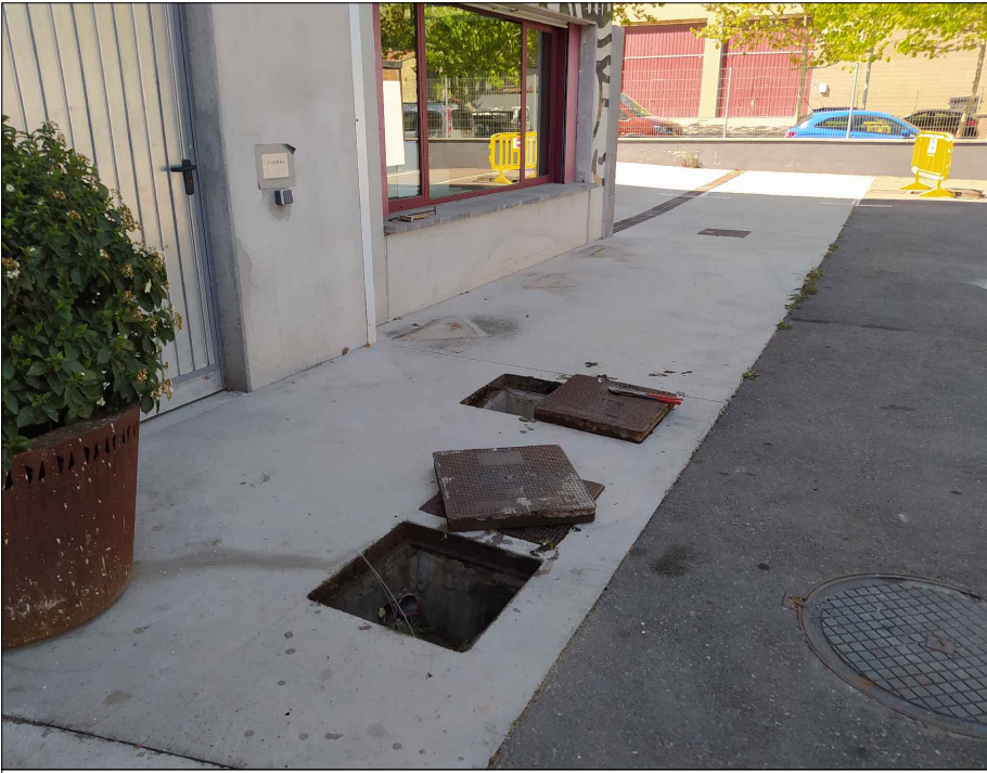
Imatge 5 - Arquetes existents
