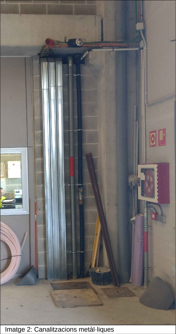
Imatge 2: Canalitzacions metàl·liques
