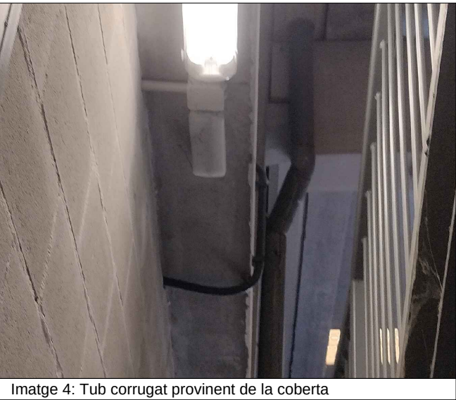
Imatge 4: Tub corrugat provinent de la coberta
