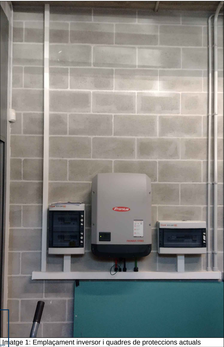
Imatge 1: Emplaçament inversor i quadres de proteccions actuals
