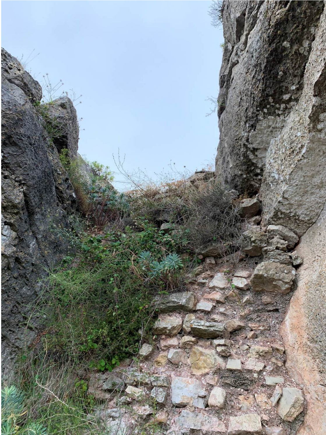
Tram de muralla sud que es troba en mal estat.
