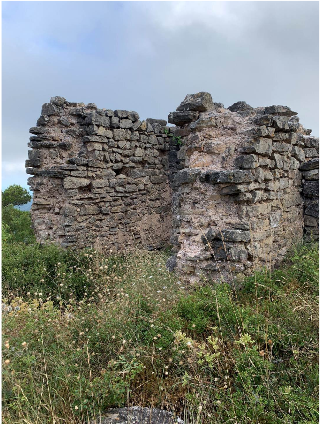
Torre oest a consolidar.
