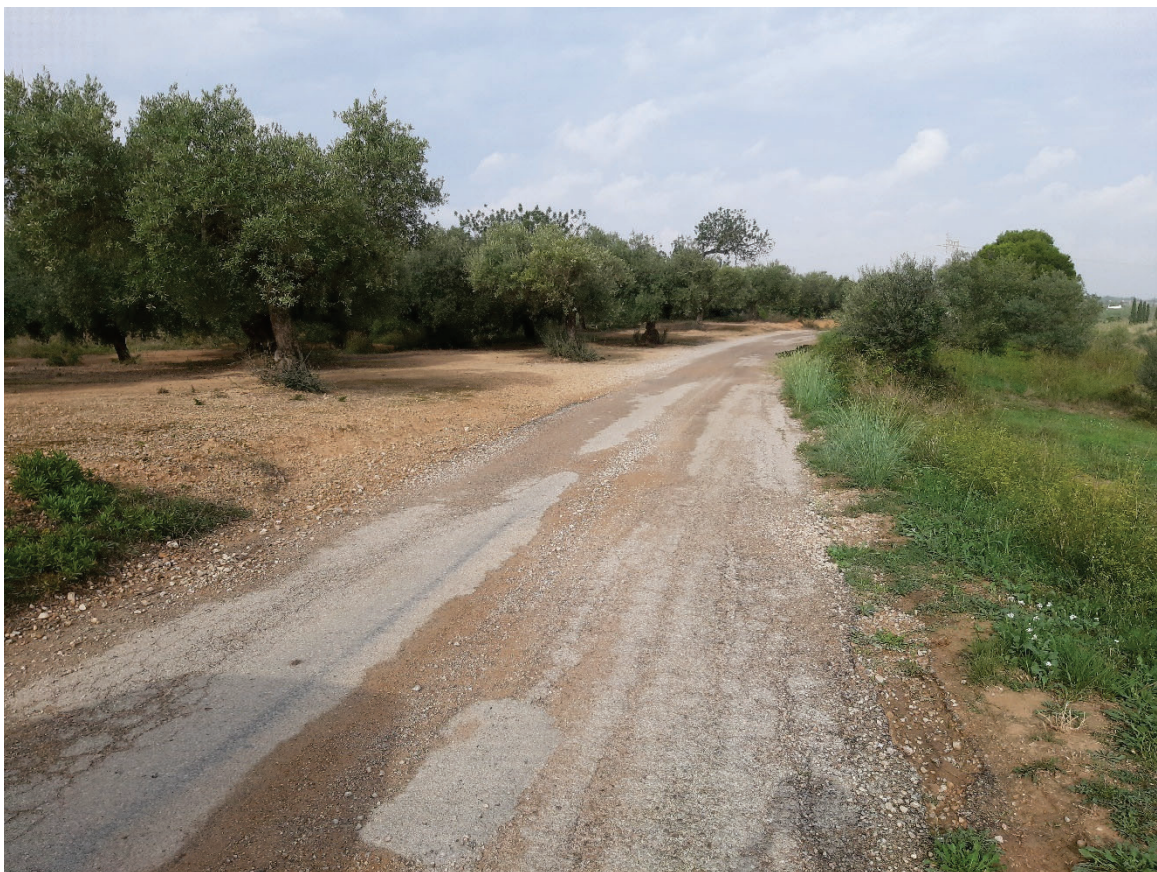
Foto 3 i 4. Vista general del camí. Ferm en mal estat general.
