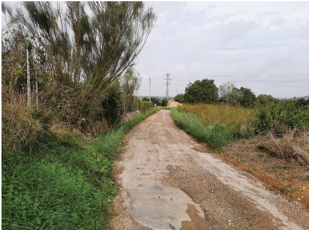
Foto 11. Neteja de vores necessària. Pavimentació en mal estat. Aigua recollida a la cuneta ha de desaiugar superficialment per aquest tram de camí.
