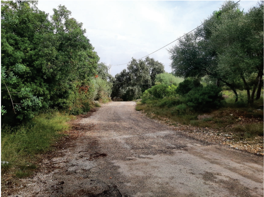
Foto 15. Paviment desgranat. Final Tram 1.
