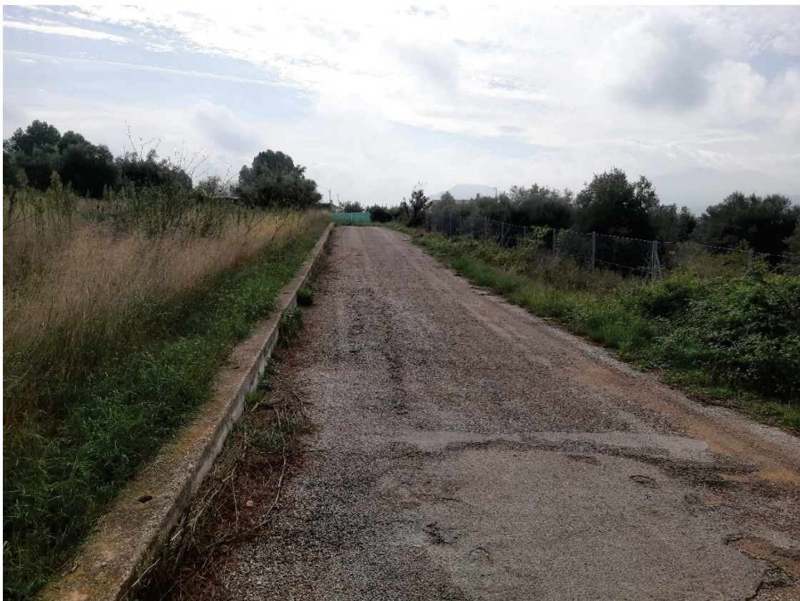
Foto 20. Paviment desgranat i amb sots
