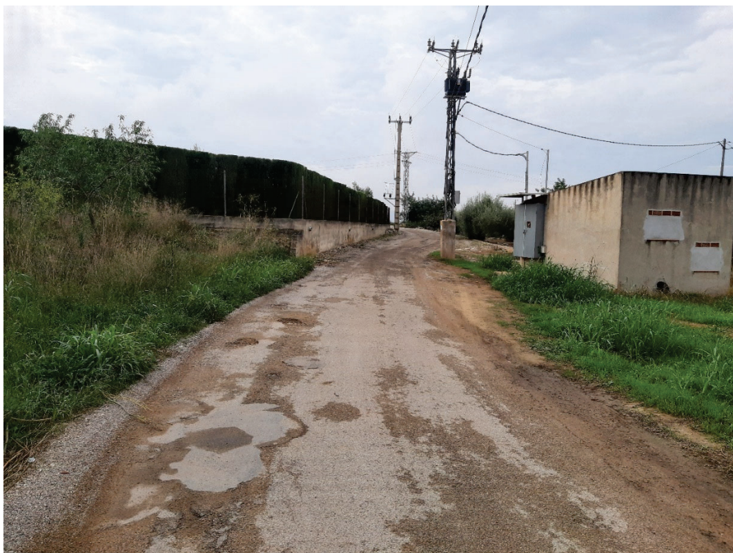
Foto 26. Paviment desgranat i amb sots
