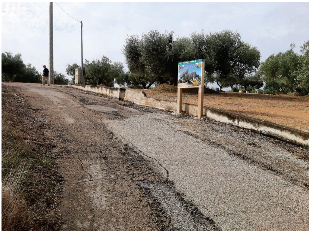
Foto 12. Paviment desgranat. Tram inicial de camí.
