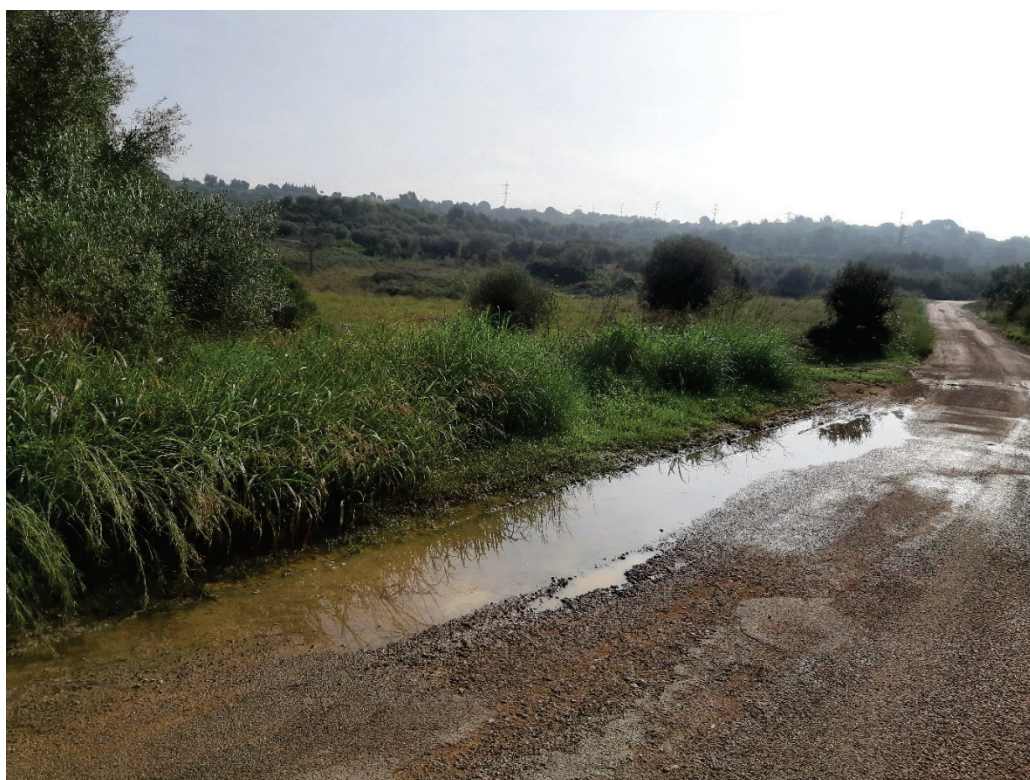
Foto 2. Punt d'acumulació d'aigua. Desgranats superficials.
