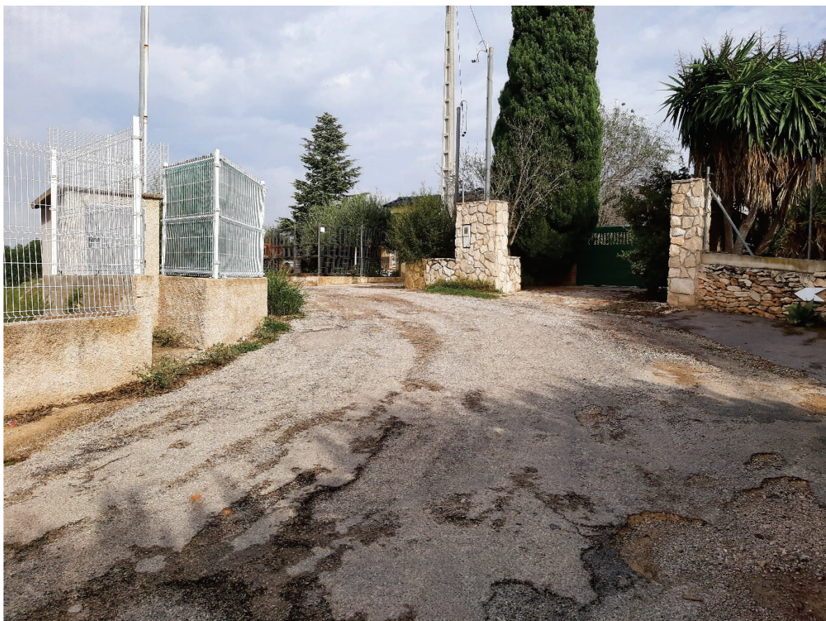
Foto 24. Paviment desgranat amb sots entre entradors d'habitatges.
