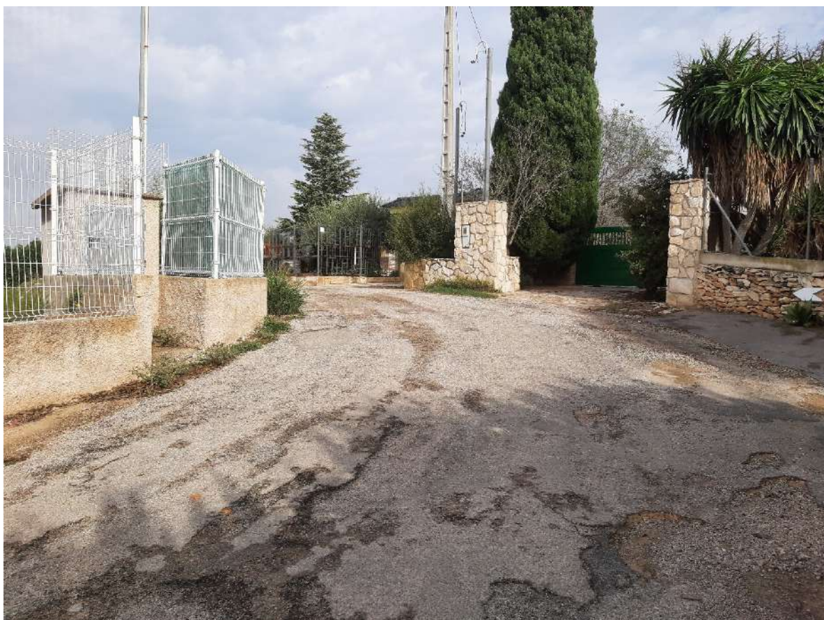
Foto 24. Paviment desgranat amb sots entre entradors d'habitatges.
