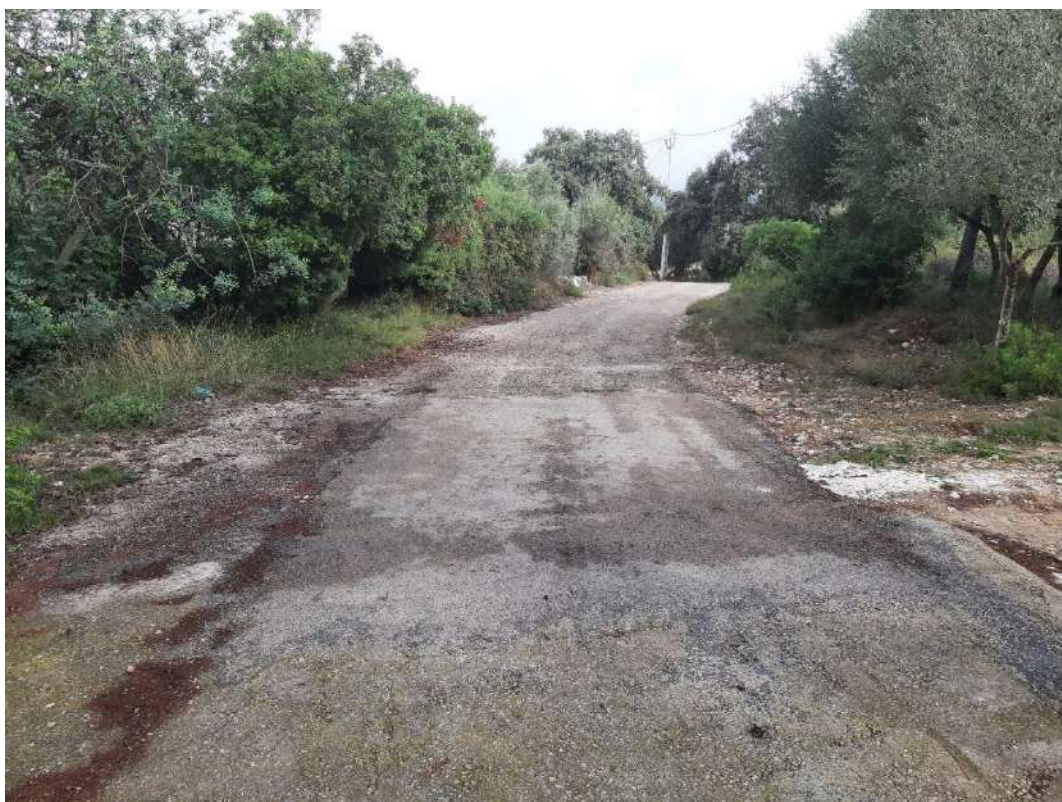
Foto 13 i 14. Paviment desgranat. Diferents trams.
