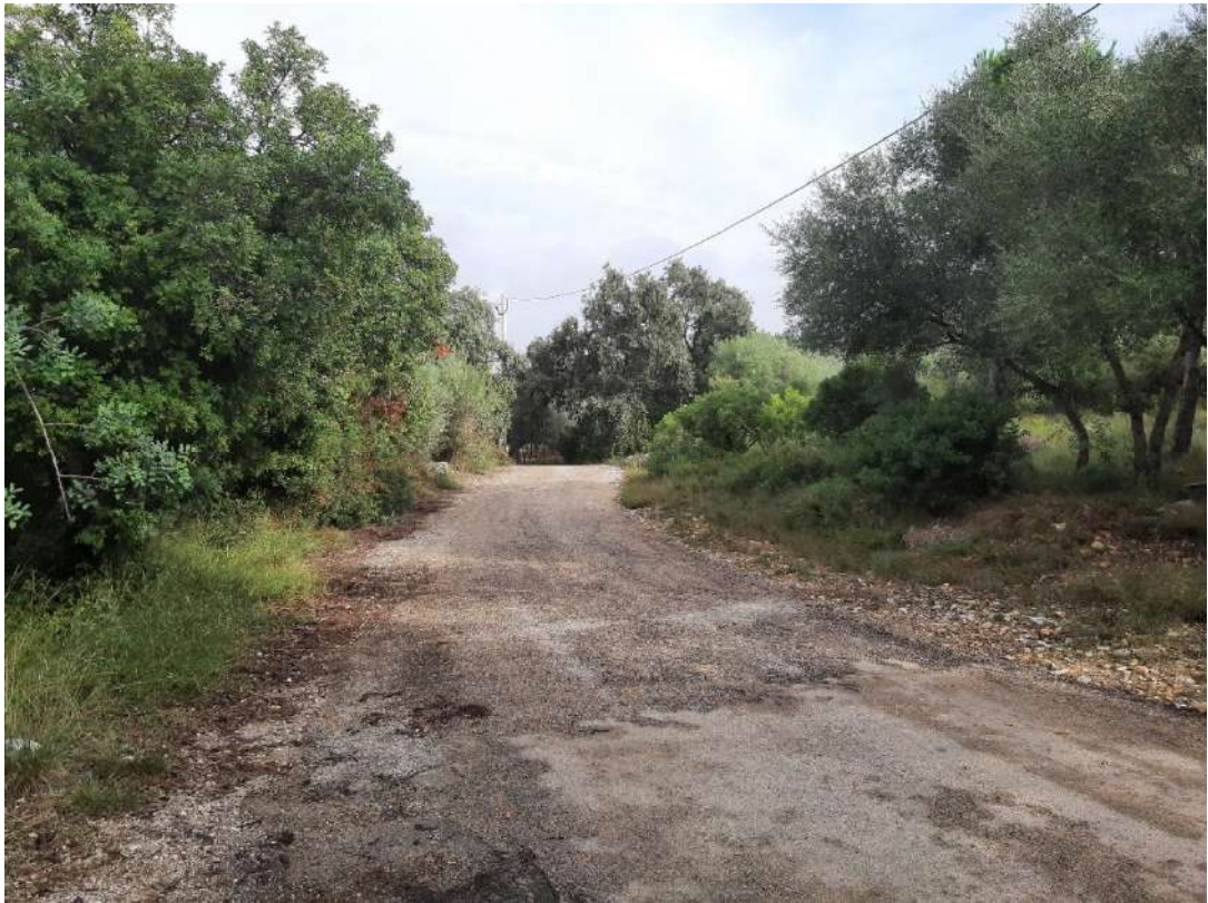
Foto 15. Paviment desgranat. Final Tram 1.
