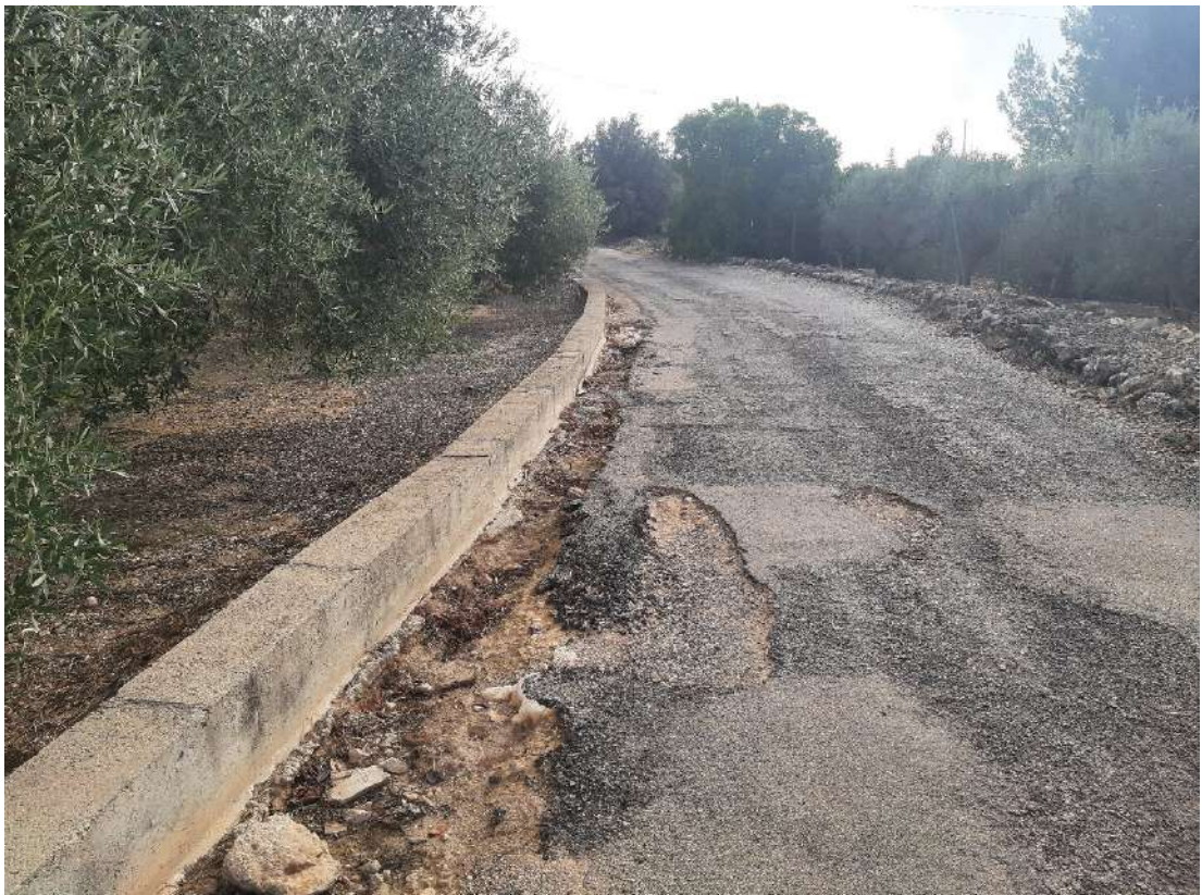
Foto 16. Manca de cuneta per canalitzar aigües. Pavimentació en mal estat.
