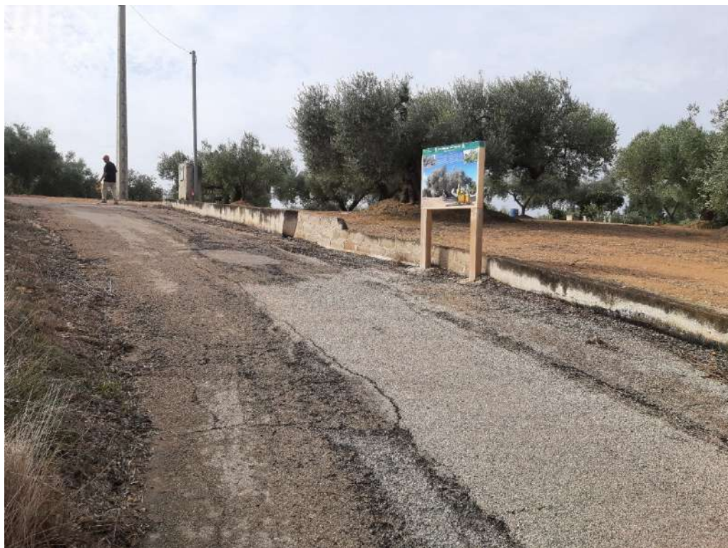
Foto 12. Paviment desgranat. Tram inicial de camí.
