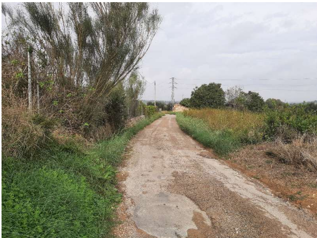
Foto 11. Neteja de vores necessària. Pavimentació en mal estat. Aigua recollida a la cuneta ha de desaiuar superficialment per aquest tram de camí.
