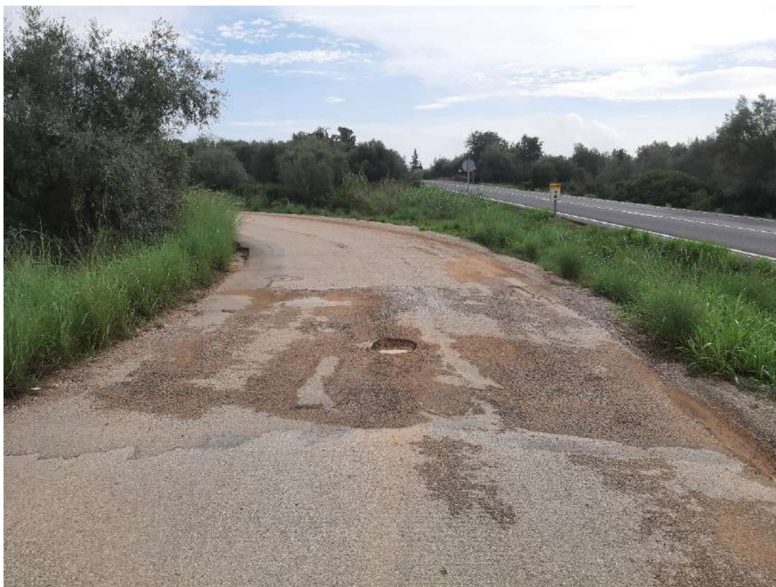
Foto 27. Tram entre paviment de mescla bituminosa a reparar.
