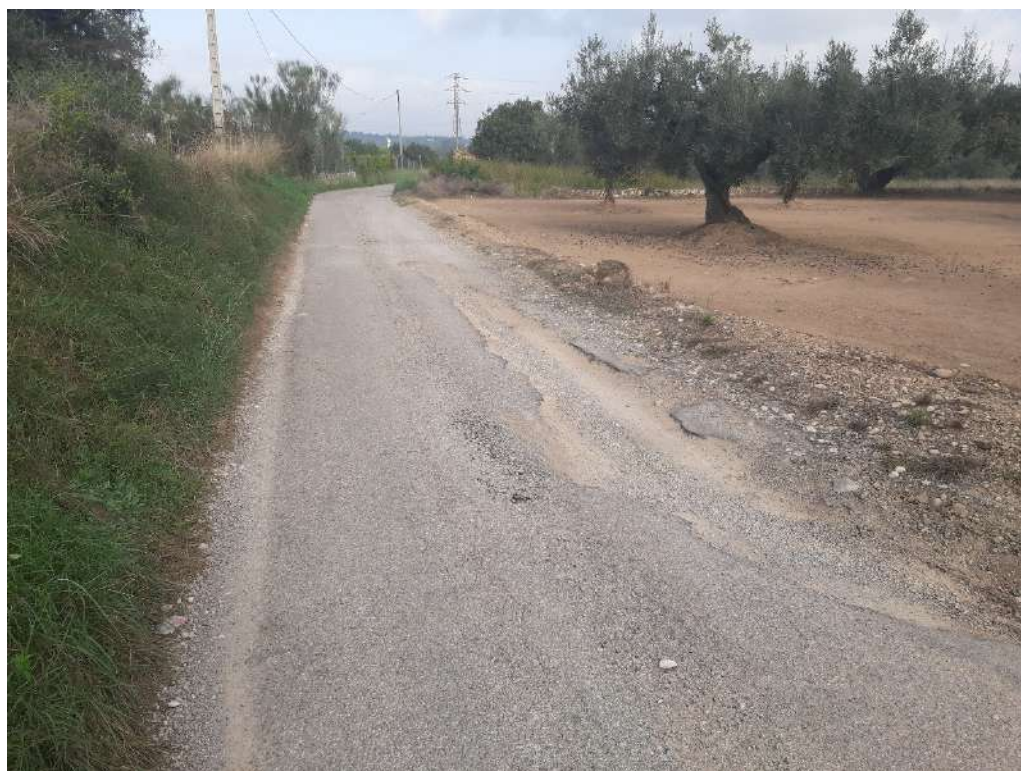
Foto 10. Punt d'acumulació d'aigua. Cuneta in situ a construir.
