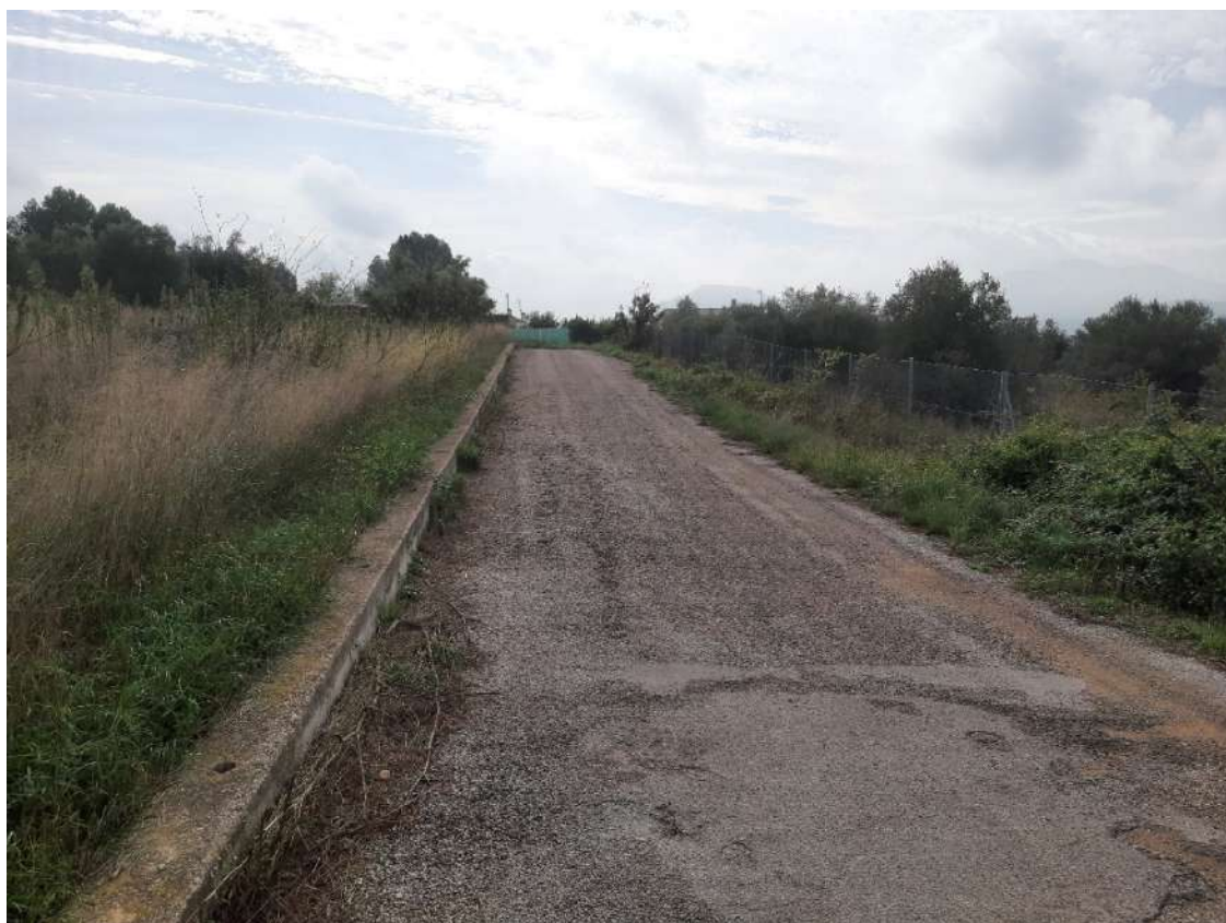
Foto 20. Paviment desgranat i amb sots
