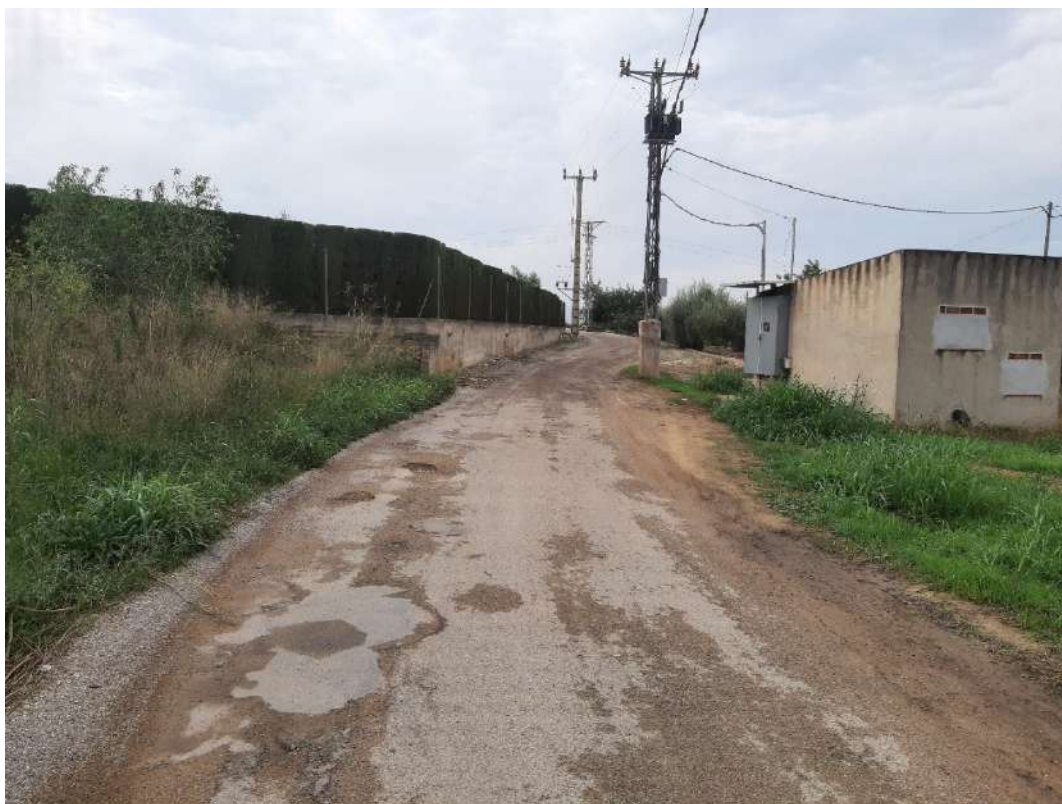
Foto 26. Paviment desgranat i amb sots
