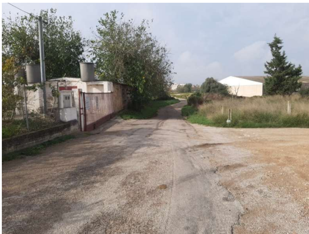
Foto 5 i 6. Zona accés granges. Paviment desgranat
