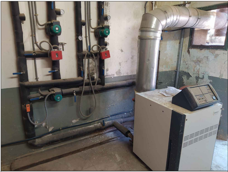
Imatge 1.- Sala caldera estat actual
