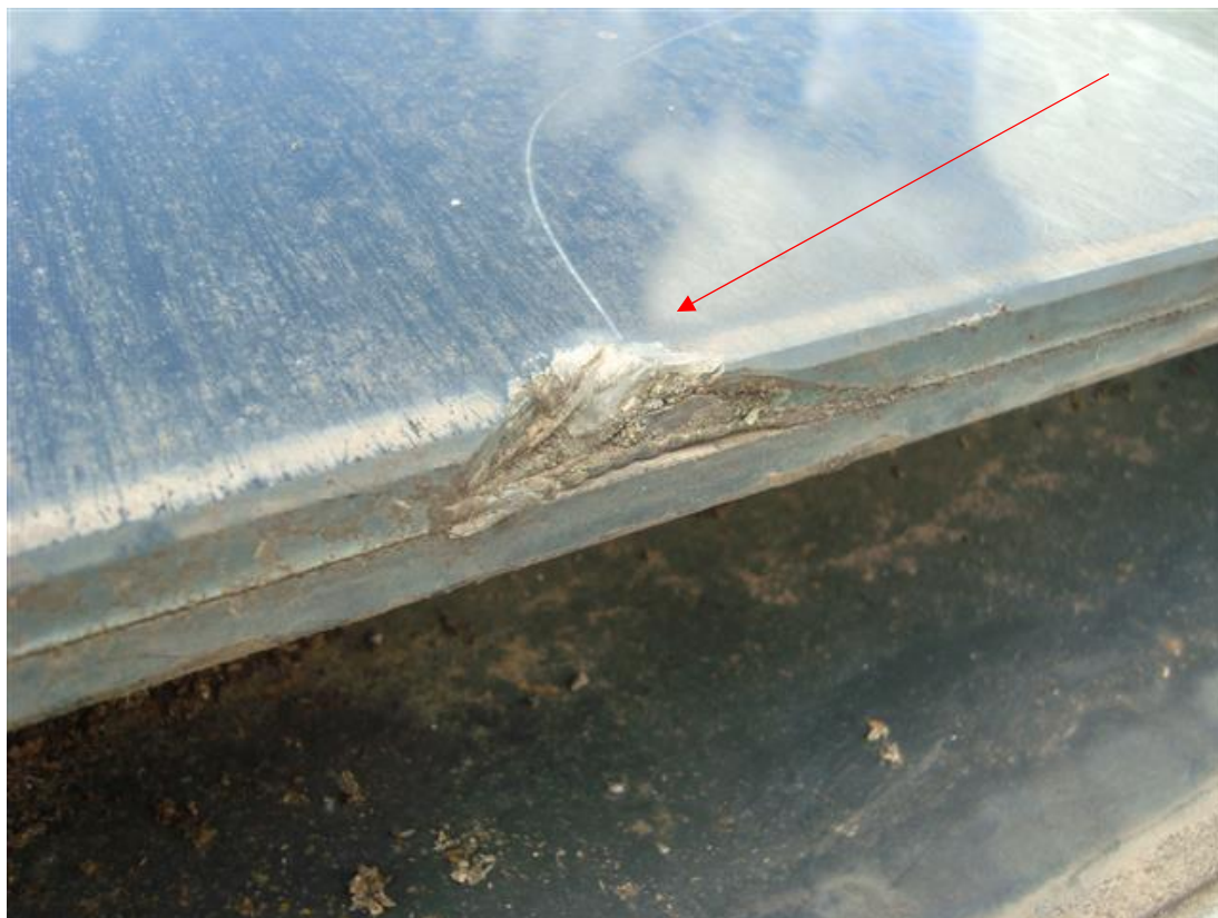
Detalle rotura b en borde inferior con indicación de un golpe de montaje
