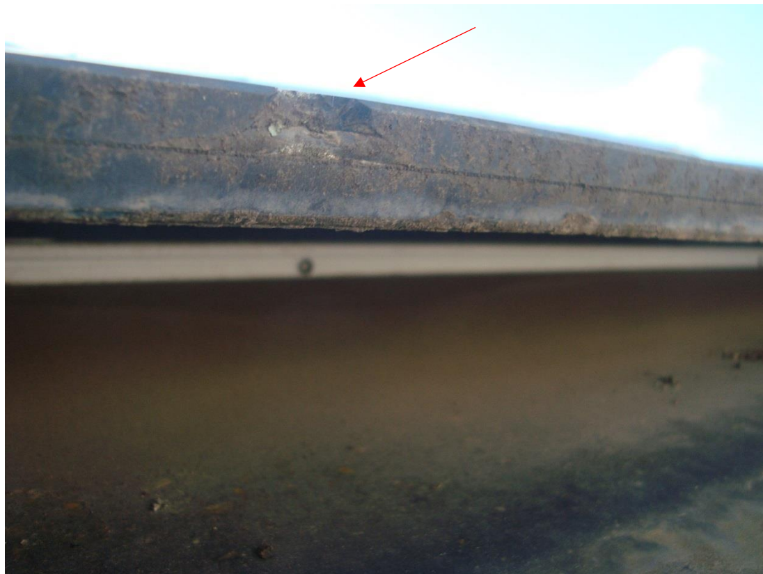
Golpe b en borde inferior sin inicio de fisura
