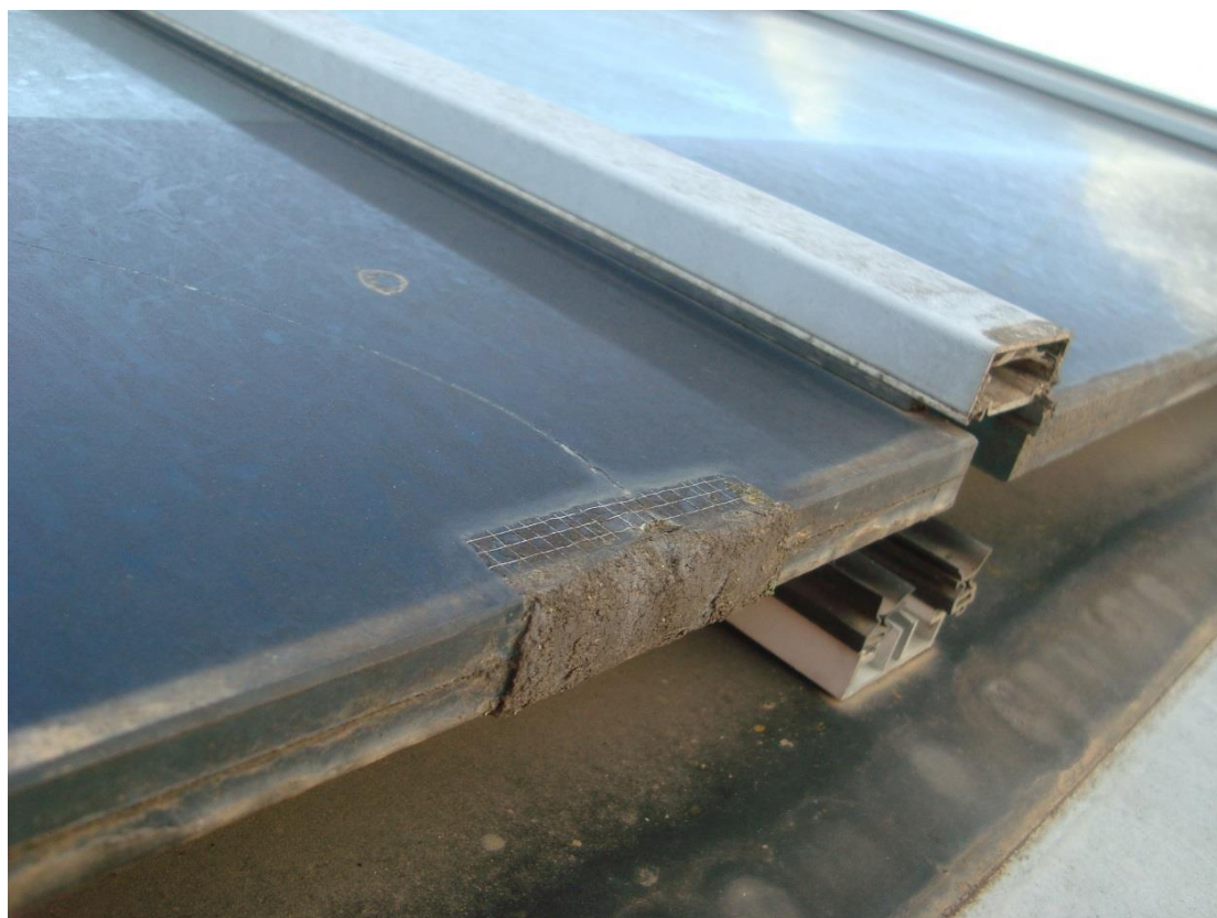
Golpe a en borde inferior, protegido por cinta durante el montaje y que es el causante de la fisura
