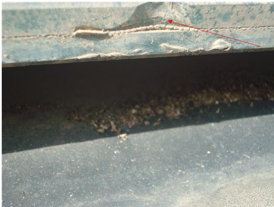
Borde con marca de un golpe durante la fase de montaje, causante del inicio de la rotura
