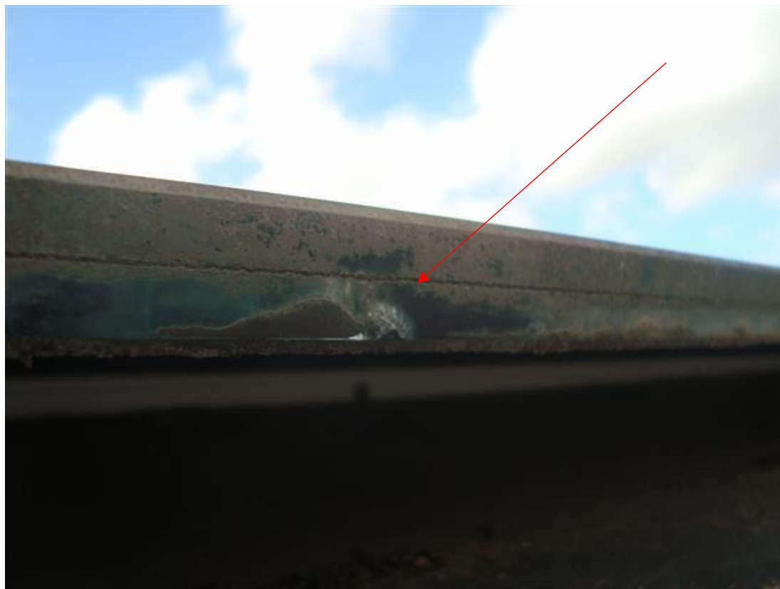
Detalle rotura a en borde inferior con indicación de un golpe de montaje
