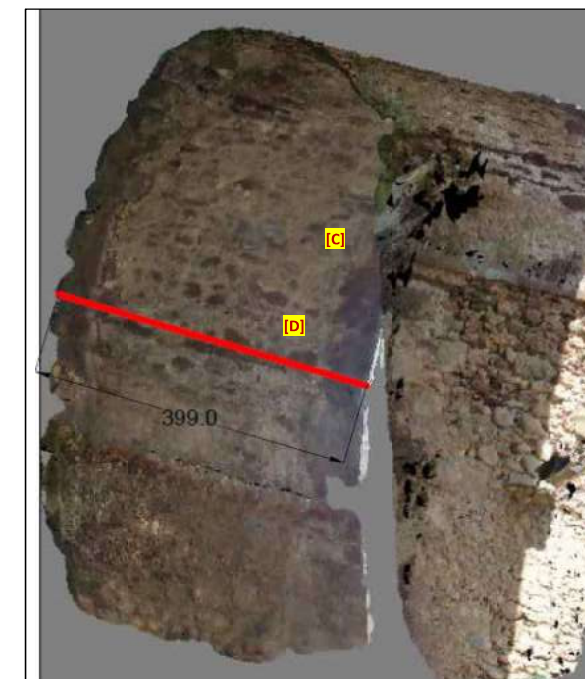
Figura 41 – Imatge del model fotogramètric de l'arc 3 el 2017 amb la fissura i l'amplària en cm.
