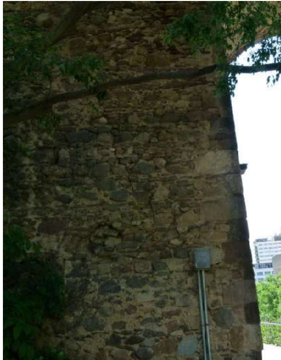
Figura 13: Parament Nord del pilar 3 (10/05/2017).
