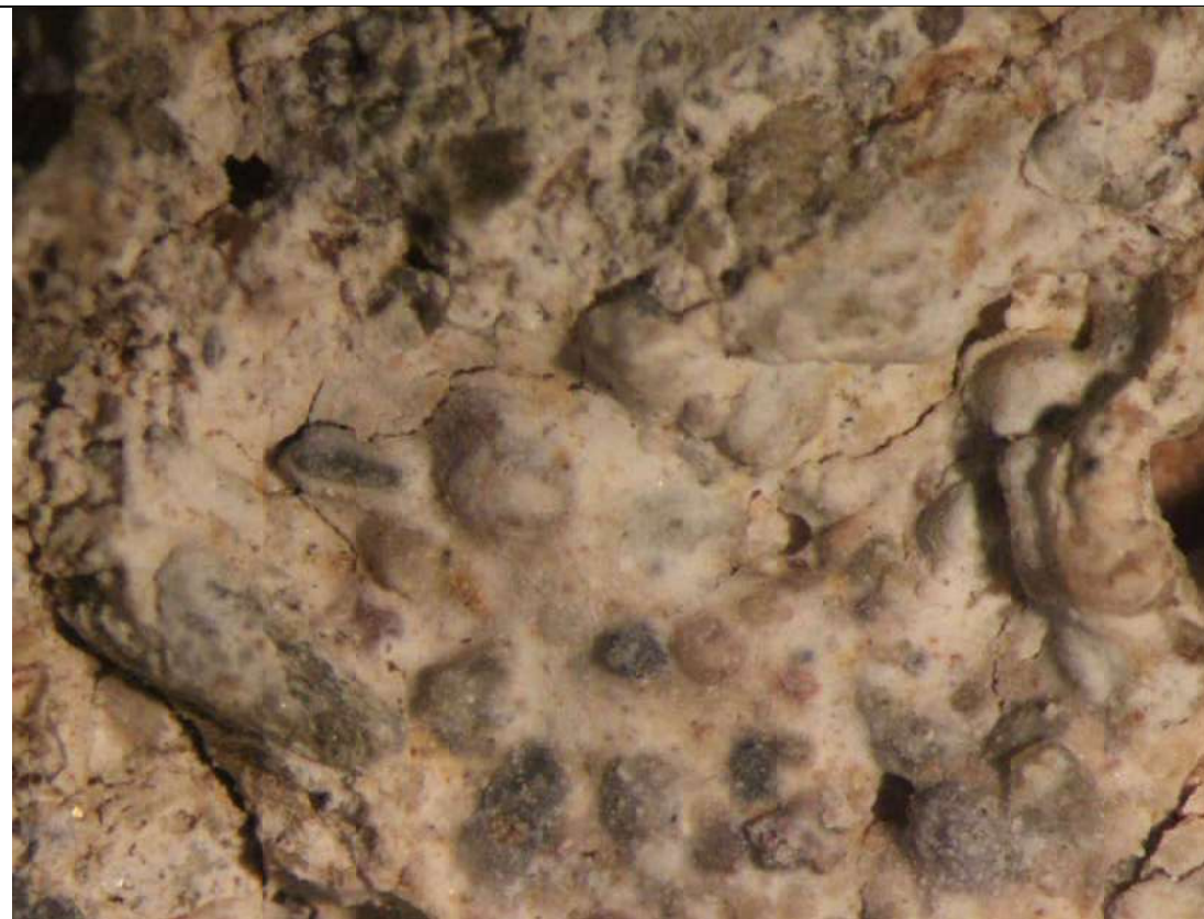
“Lechada” contínua d'aglomerant - probable procés de lixiviació – recristal·lització. Fissures .
