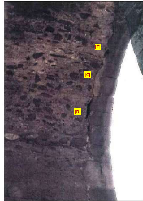
Figura 42 – Vista de detall de la fissura de l'arc 3 presa el 1995.
