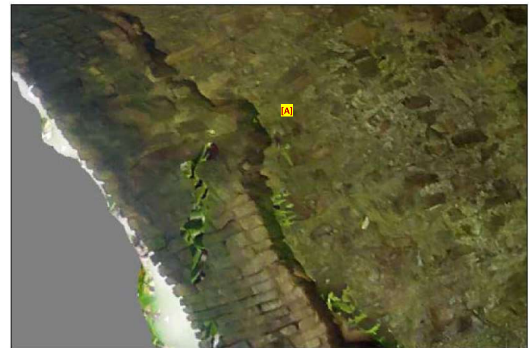
Figura 35-4 - Vista del detall de la fissura de l'arc 1 del model fotogramètric elaborat.
