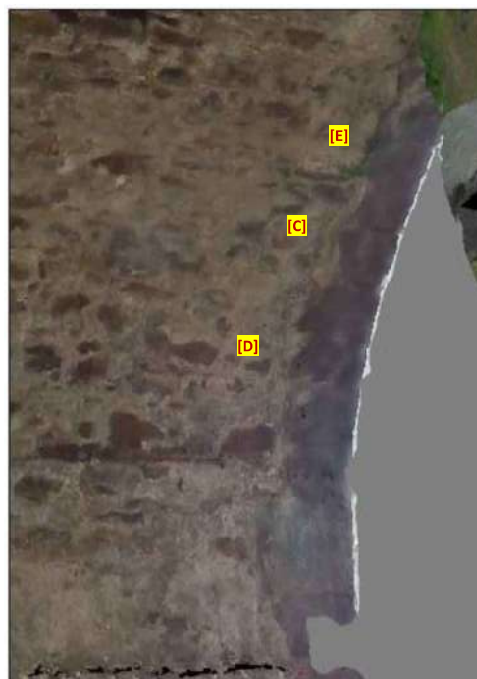
Figure 43 – Vista de detall de la fissura de l'arc 3 en el model fotogramètric del 2017.
