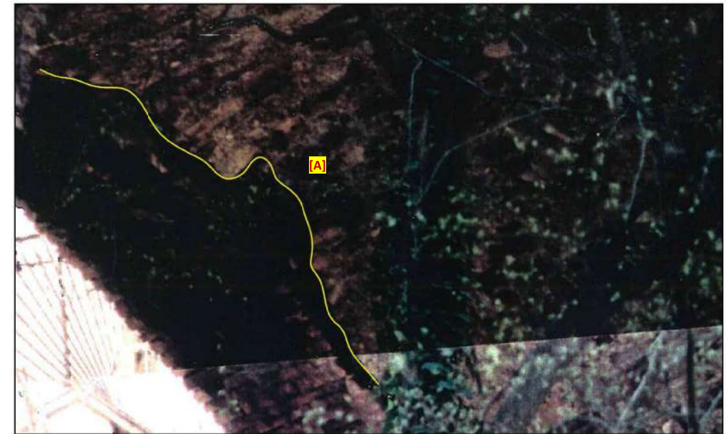
Figura 38-7 – Vista de detall de la fissura de la Figura 36-5, presa el 1995
