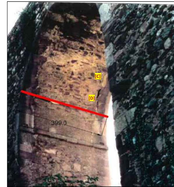
Figura 40 – Fotografia de l'arc 2 del 1995 on es mostra la fissura i la mida de l'amplària de l'arc en cm.
