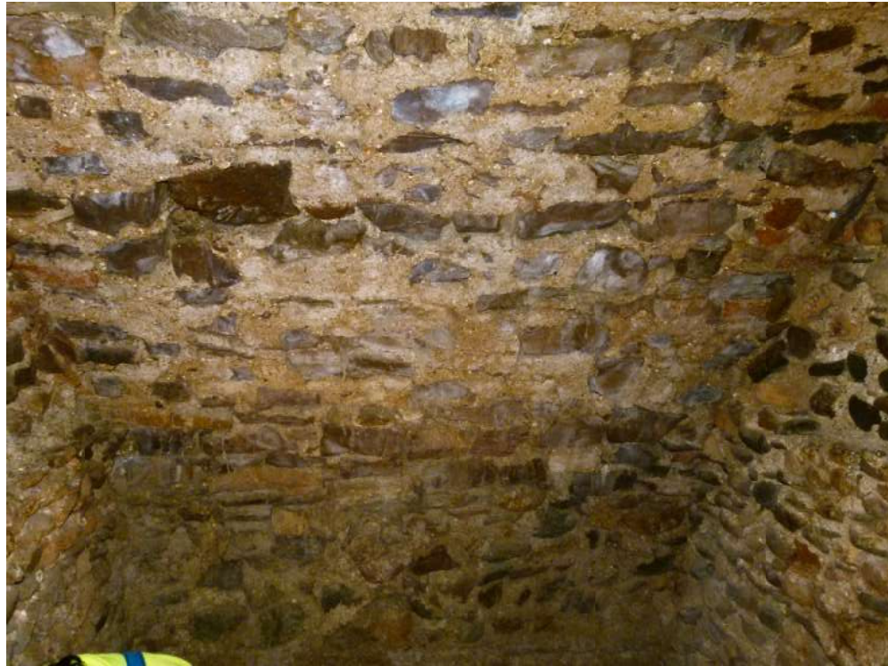
Figura 17: Arrencada de la volta de l'arc 4 a l'estrep Est.
