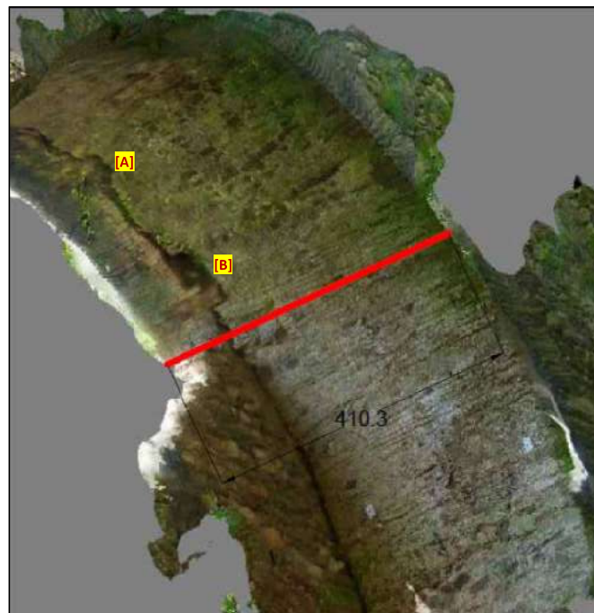
Figura 37-6 - Imatge del model fotogramètric de l'arc 1, amb un punt de vista tan semblant com ha estat possible amb el de la Figura 5, on s'aprecia la fissura i també la mida de l'amplària de l'arc en cm.
