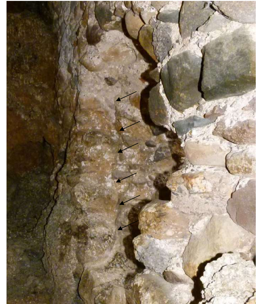
Figura 19: Forat d'accés a l'intradós de la volta de l'arc 4, amb la fissura entre dos fulls.
