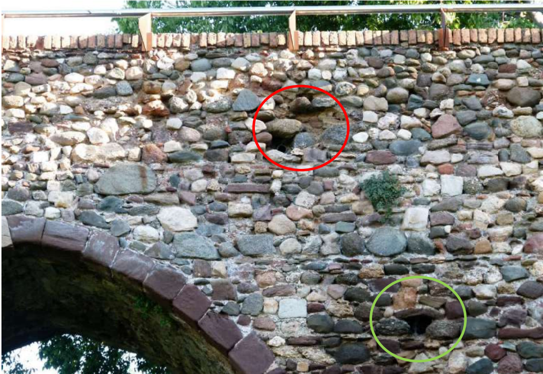
Figura 17: Detall del parament Sud a l'arc 3 i pilar 3 (24/04/2017).
