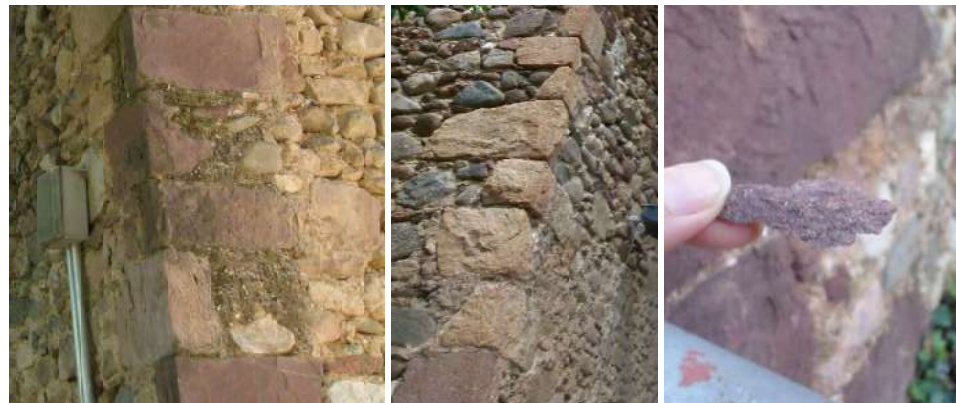
Figura 14: Aresta Nord pilar 3, aresta Sud Est del pilar 2 i fragment de llastra (10/05/2017).
