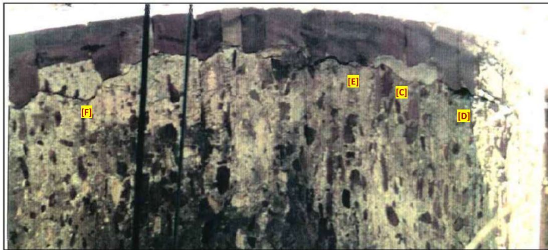
Figura 46 – Vista de detall de la fissura de l'arc 3 presa el 1995.
