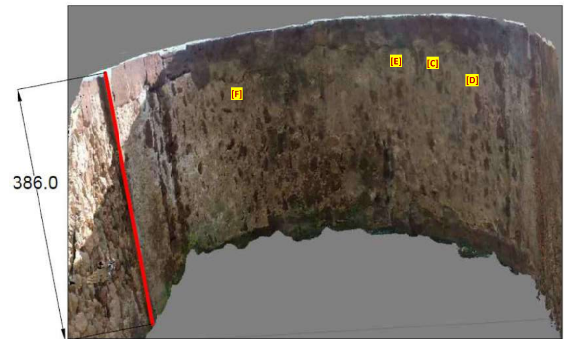
Figura 45 – Imatge del model fotogramètric del 2017 de l'arc 3 que mostra la fissura i l'amplària de l'arc en cm.
