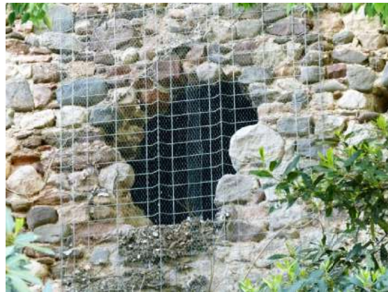
Figura 19: Forat al parament Nord d'accés sota la volta de l'arc 4 (24/04/2017).
