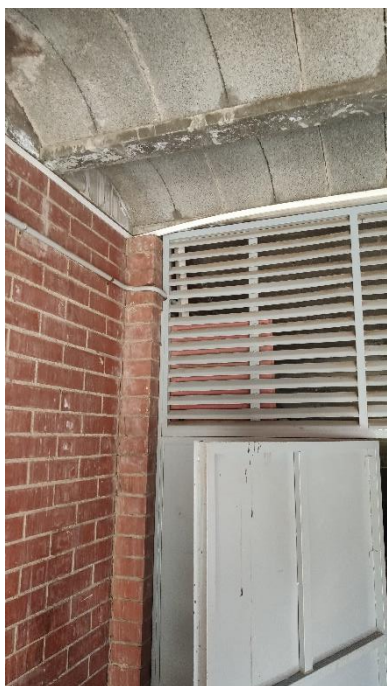
Detall accés a sala d'equips FV (actual magatzem)
