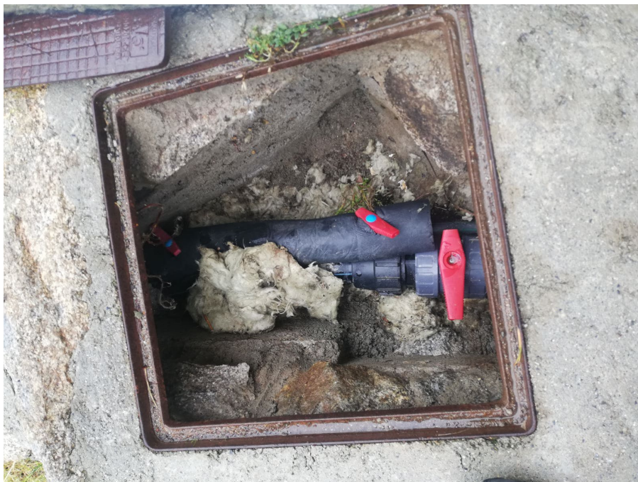
Arquetes actuals exterior. Tubs molt pròxims a la superfície amb perill de gelades.
