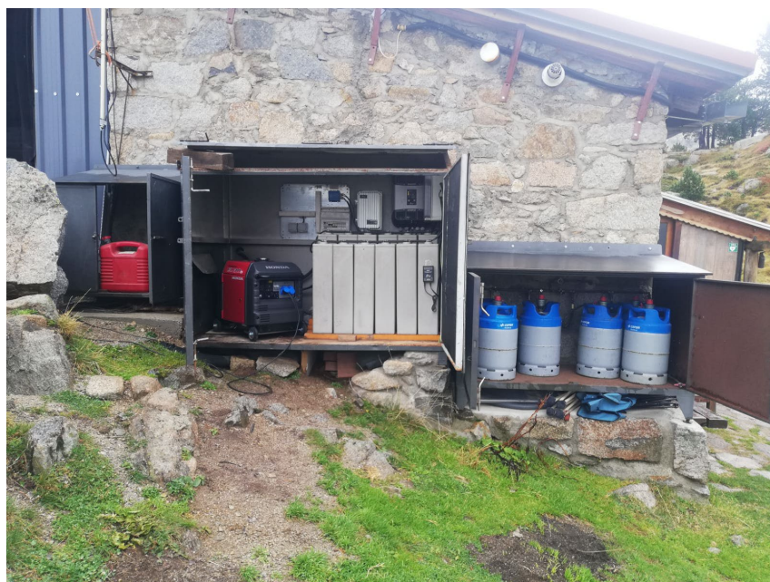
Armaris exteriors instal·lacions
