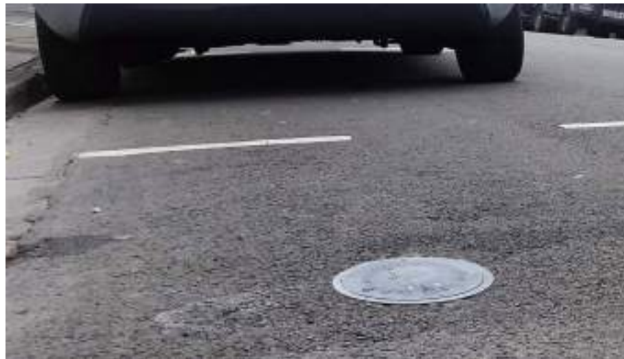
Figura 161 Sensor de pàrquing instal·lat al terra. Font: Smartparking
