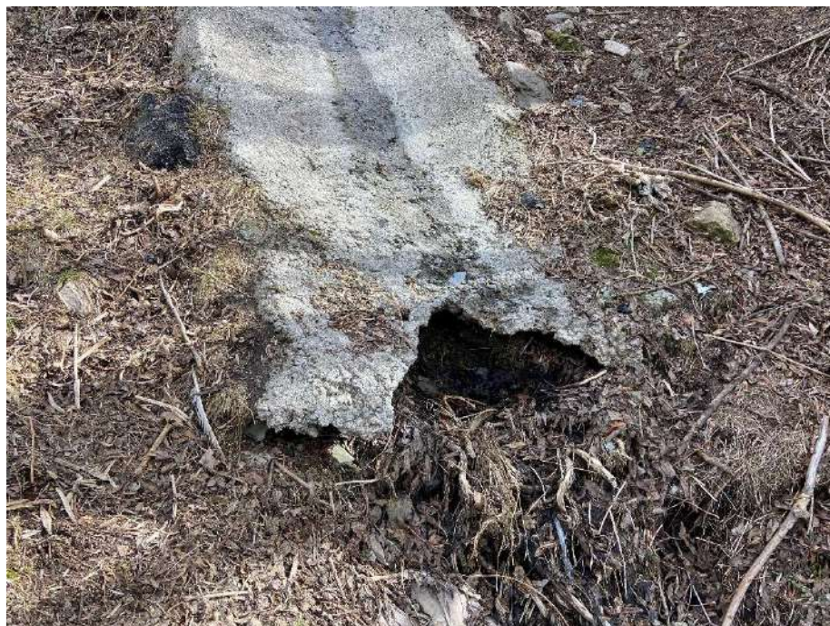
Imatge 5. Final de la cuneta actual. Punt de fort soscavament del terreny.
