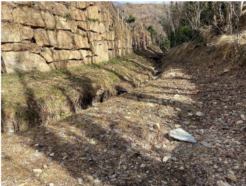
Imatge 6. Tram final del torrent a condicionar. L'escullera està la dreta natural del barranc de Civís.
