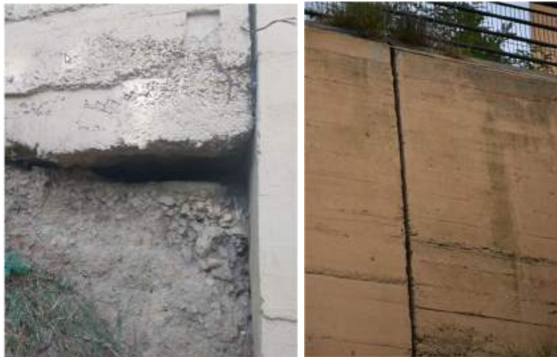
Fotografia núm. 14/15 – Patologies. Soscavació sota estrep oest/deformació aletes laterals del tauler estrep est
