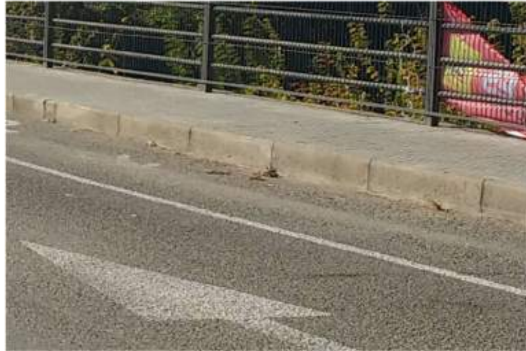
Fotografia núm. 23 – Patologies. Acumulació de materials en embornals que no permeten el desagüe de la plataforma
