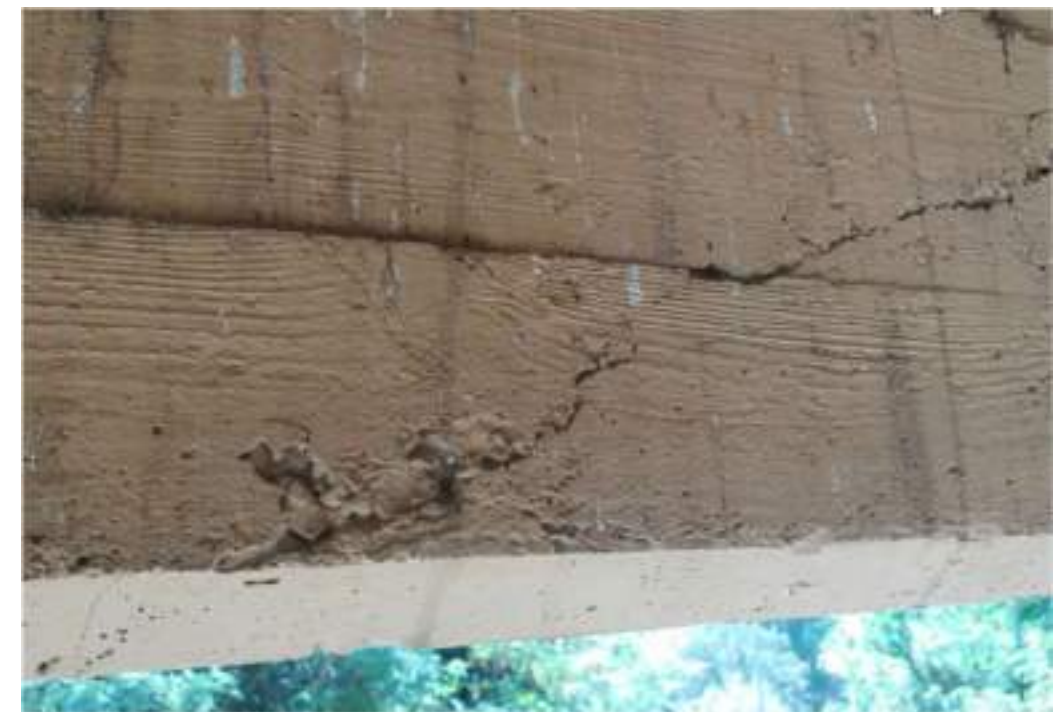
Fotografia núm. 18 – Patologies. Coqueries pel mal formigonat de les bigues
