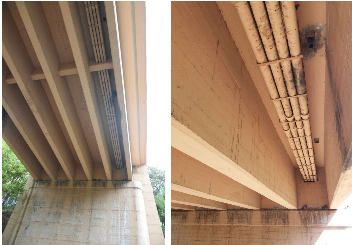
Fotografia núm. 2/3 – Vistes tauler des de sota. Detall canalització i sortida embornals
