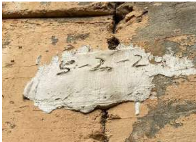
Imatge testimoni amb fissura
