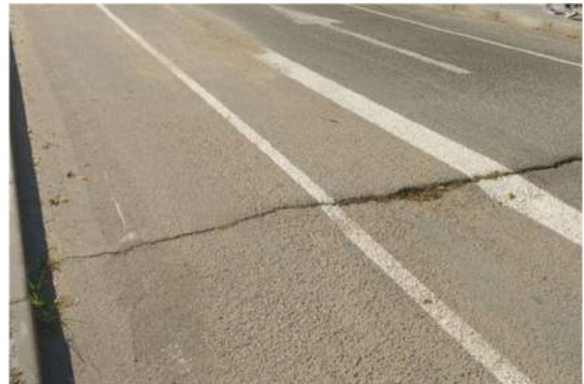
Fotografia núm. 27 – Patologies.
