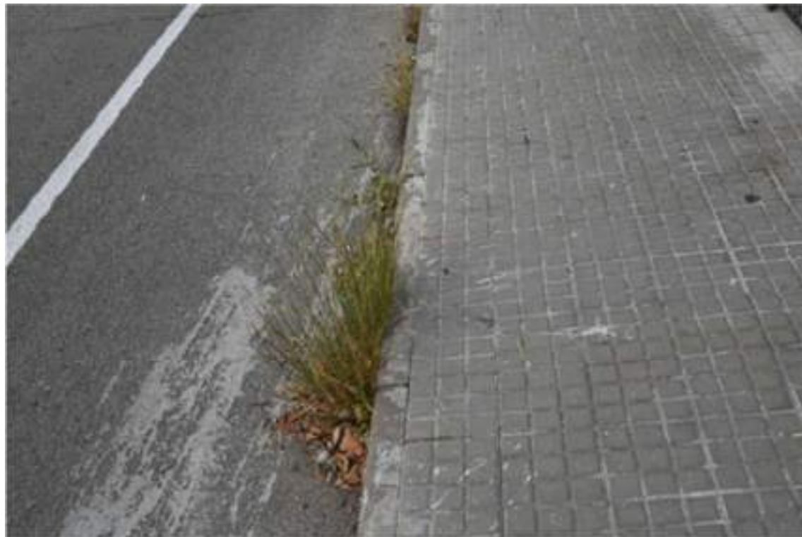
Fotografia núm. 20 – Patologies. Vegetació a les zones de voreres i imposta sobre el tauler
