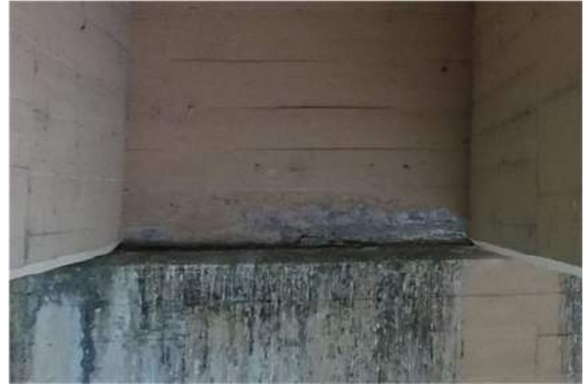
Fotografia núm. 21 – Patologies. Corrosió d'elements
