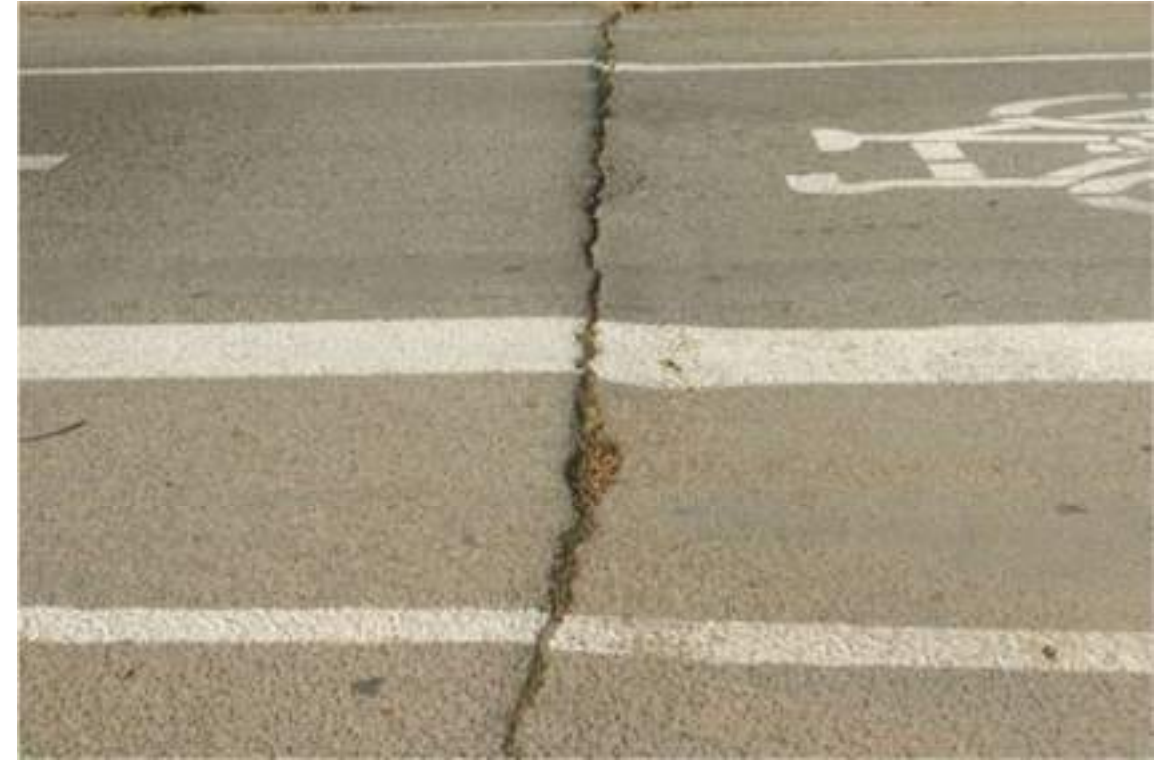
Fotografia núm. 26 – Patologies.
