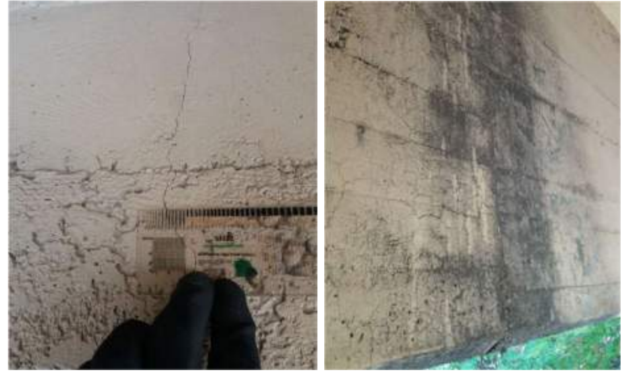
Fotografia núm. 16/17 – Patologies. Fissures transversals a l'eix de la biga (01-0.4mm)/Degradació superficial
