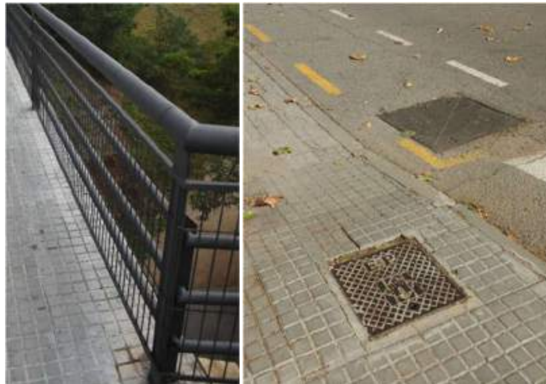
Fotografia núm. 24/25 – Patologies. Barana amb alçada insuficient, manca de sistemes de contenció. Degradació superficial de paviments amb esquerdes.
