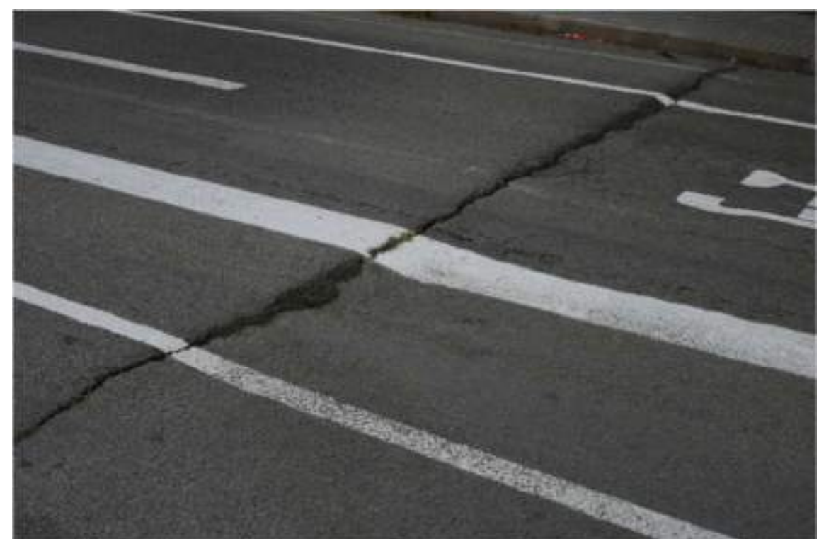
Fotografia núm. 22– Patologies. No existeixen juntes de dilatació en el tauler del pont
