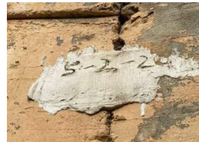
Imatge testimoni amb fissura
