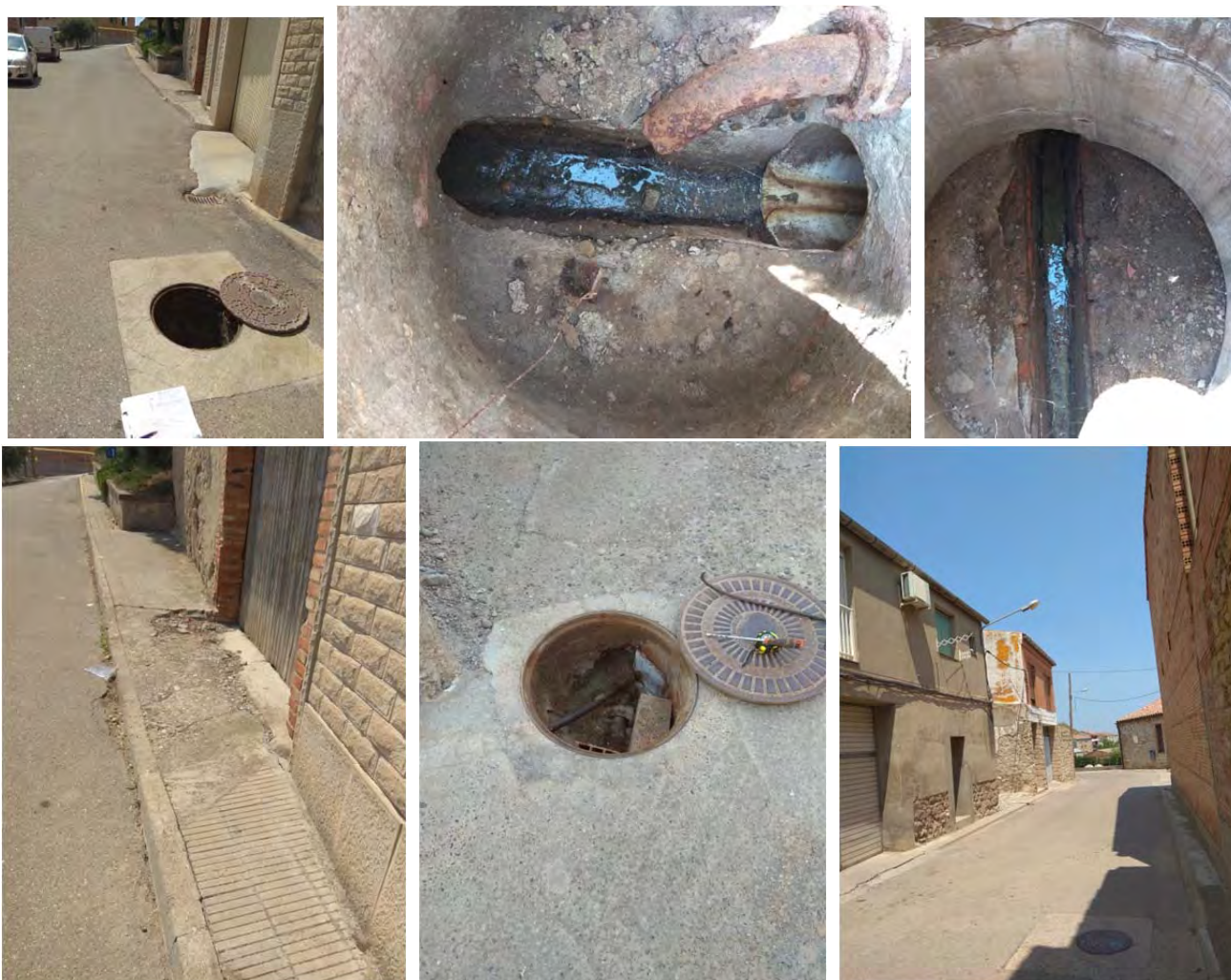
Vistes instal·lacions C. Empit
