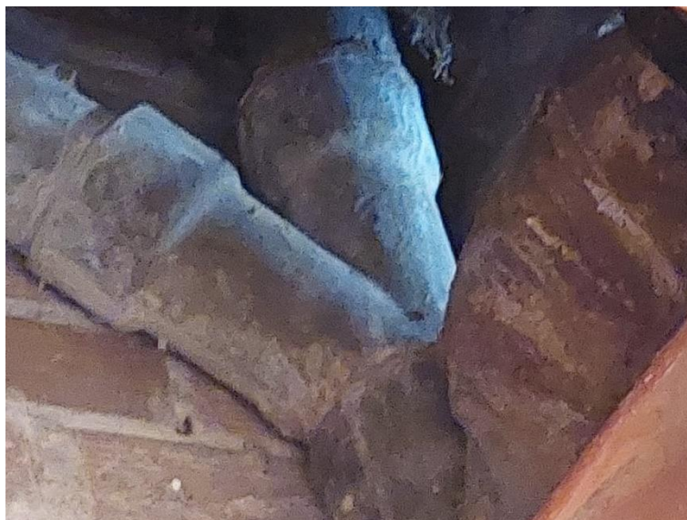
Fotografia de detall del colze de connexió de fibrociment
