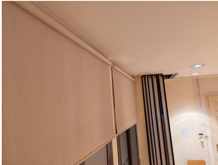
Fotografia de les humitats del fals sostre entorn a la ubicació del colze de connexió
