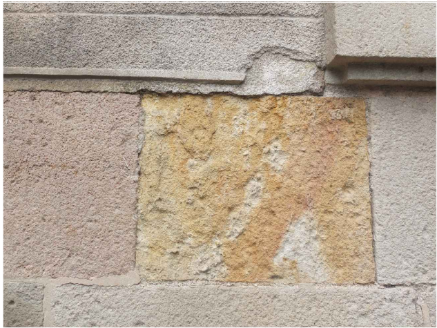
Despeniment del revestiment de ciment pòrtland. A sota es pot observar l'arrebossat original de morter de calç. Font: GAA 04/08/2021
