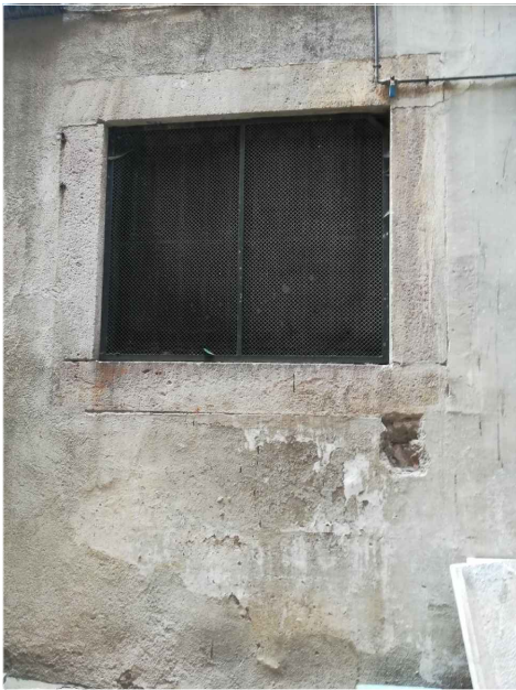
Obertura de planta baixa amb reixa de protecció. Font: GAA 30/08/2021
