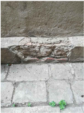
Pèrdua del revestiment de la socolada. Font: GAA 04/08/2021
