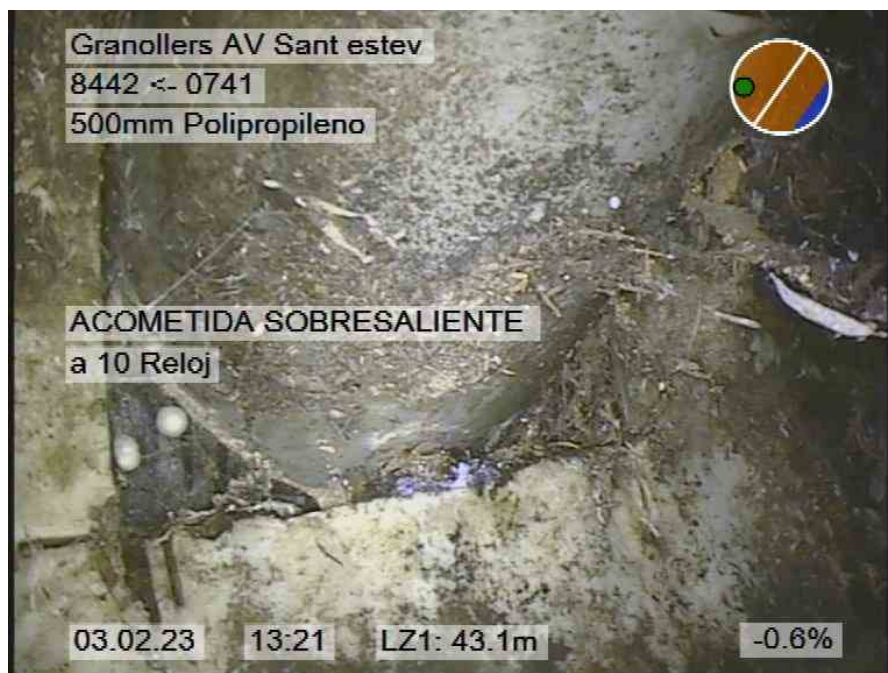
70.jpg, 00:05:29, 43.10m ACOMETIDA SOBRESALIENTE a 10 Reloj
