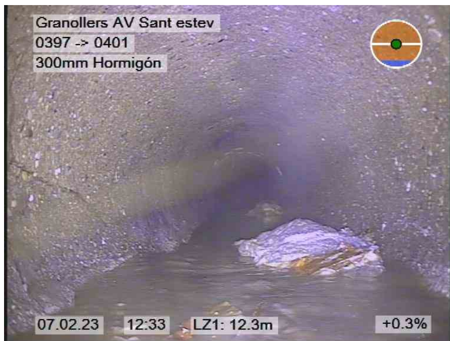
148.jpg, 00:06:49, 12.30m INTERRUPCION POR SUCIEDAD/OBSTRUCCION
