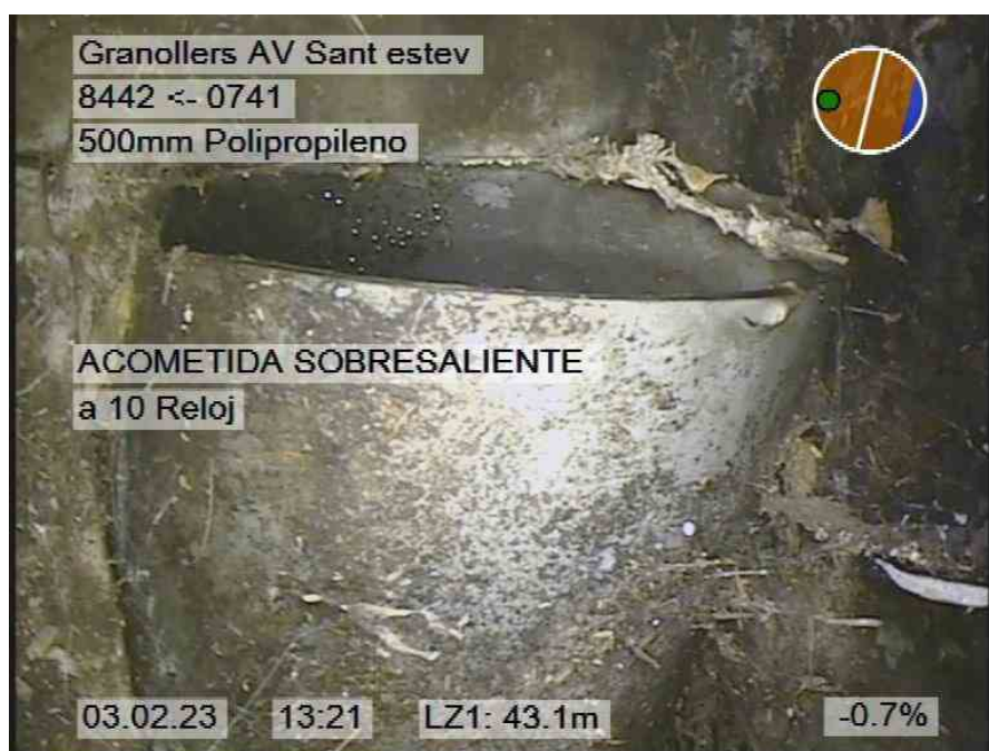
69.jpg, 00:05:29, 43.10m ACOMETIDA SOBRESALIENTE a 10 Reloj
