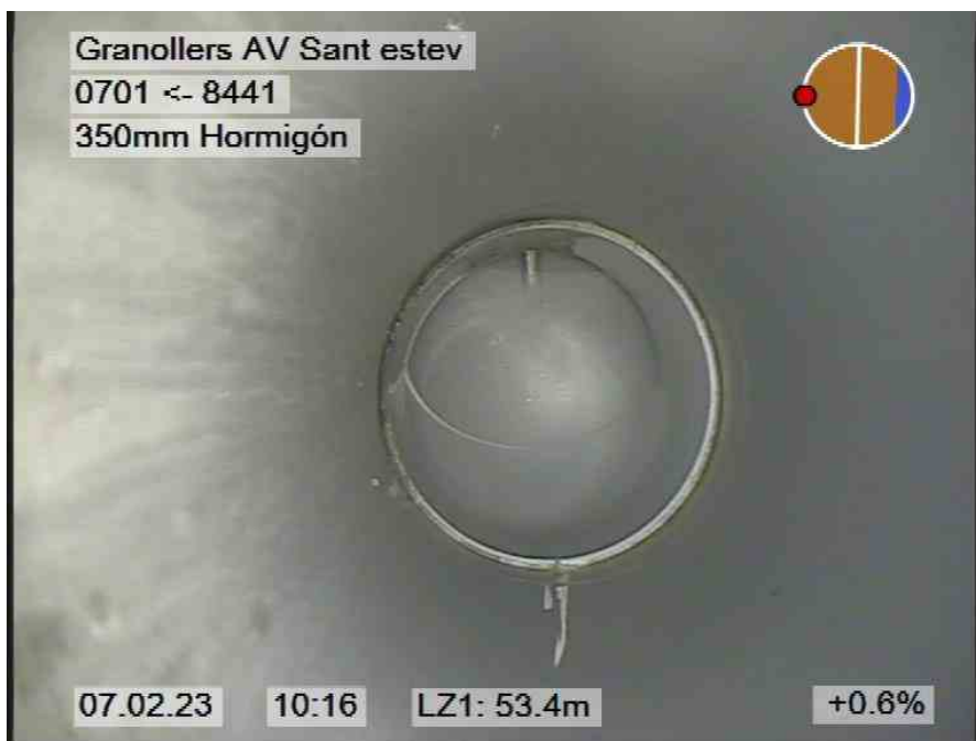
121.jpg, 00:10:46, 53.20m ACOMETIDA SOBRESALIENTE a 12 Reloj
