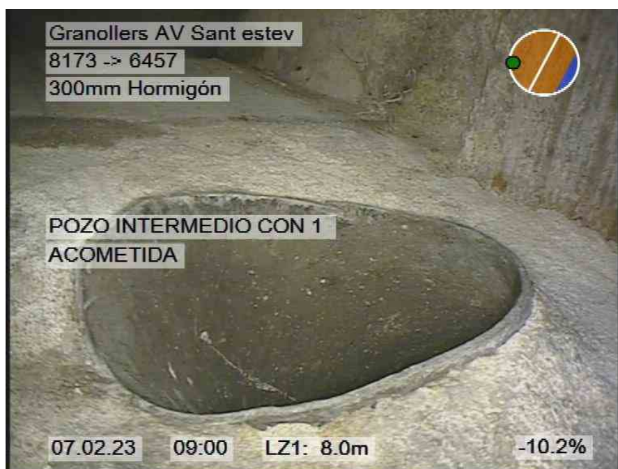
110.jpg, 00:00:54, 8.00m POZO INTERMEDIO CON 1 ACOMETIDA
