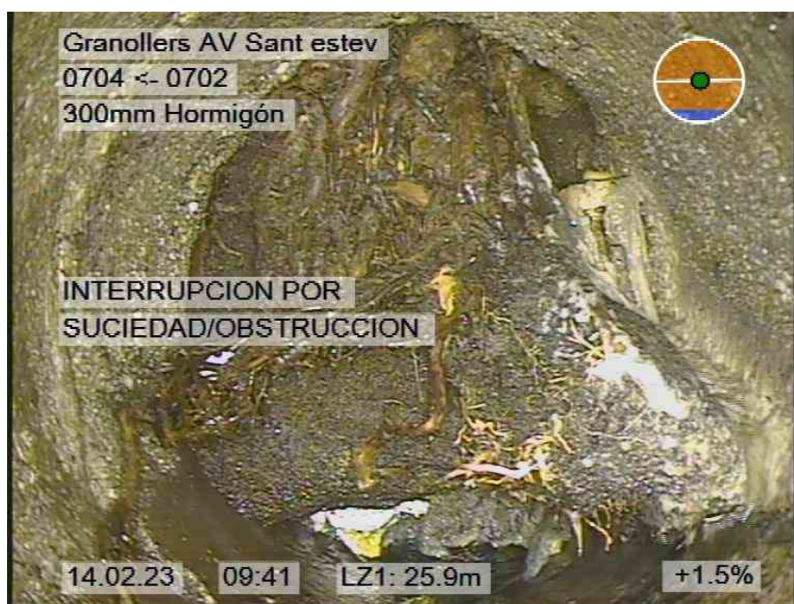
163.jpg, 00:02:11, 25.90m INTERRUPCION POR SUCIEDAD/OBSTRUCCION
