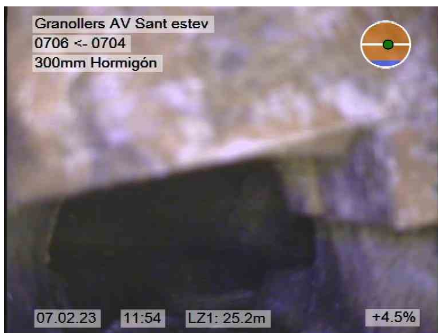
134.jpg, 00:03:40, 25.20m INTERRUPCION POR SUCIEDAD/OBSTRUCCION
