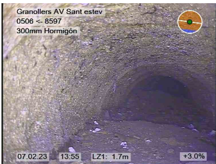
151.jpg, 00:00:28, 1.70m INTERRUPCION POR
