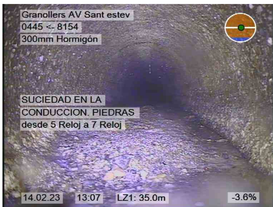
192.jpg, 00:02:45, 35.00m SUCIEDAD EN LA CONDUCCION. PIEDRAS desde 5 Reloj a 7 Reloj
