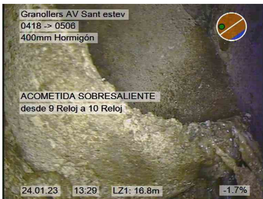
42.jpg, 00:01:35, 16.80m ACOMETIDA SOBRESALIENTE desde 9 Reloj a 10 Reloj
