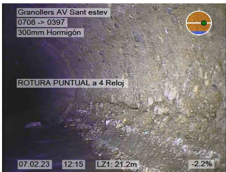
138.jpg, 00:01:52, 21.20m ROTURA PUNTUAL a 4 Reloj
