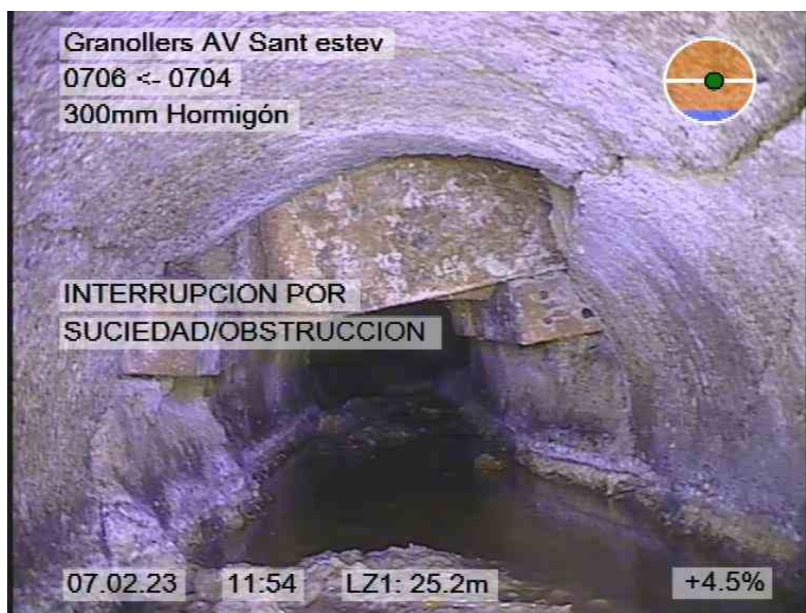
133.jpg, 00:03:40, 25.20m INTERRUPCION POR SUCIEDAD/OBSTRUCCION
