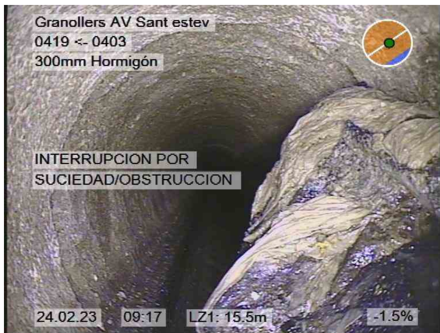
207.jpg, 00:02:41, 15.50m INTERRUPCION POR SUCIEDAD/OBSTRUCCION
