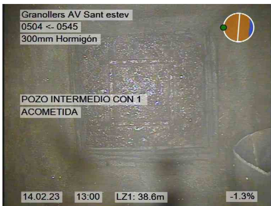
185.jpg, 00:04:43, 38.60m POZO INTERMEDIO CON 1 ACOMETIDA
