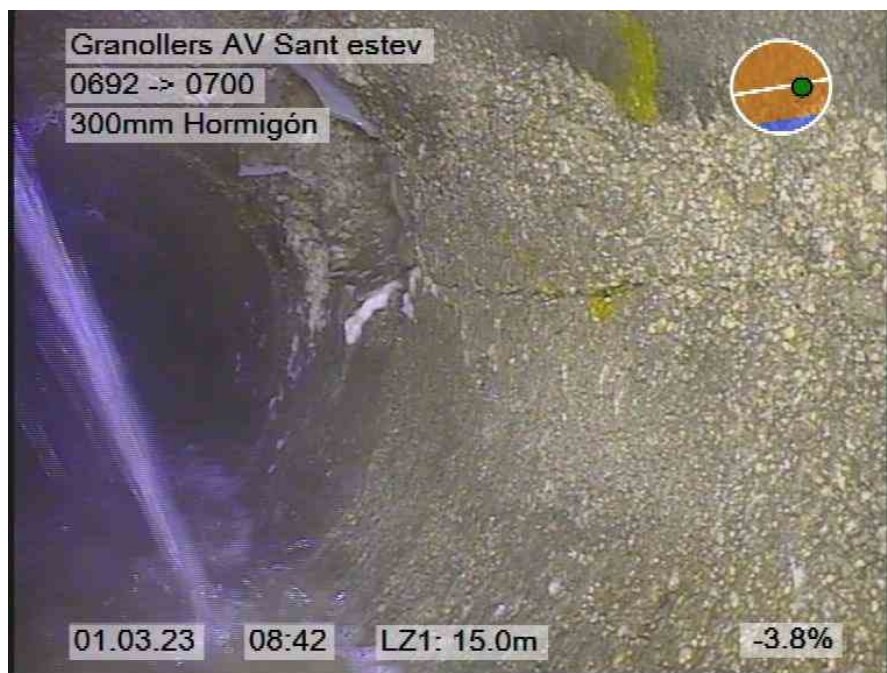
210.jpg, 00:06:49, 15.00m FISURA PUNTUAL LONGITUDINAL a 4 Reloj
