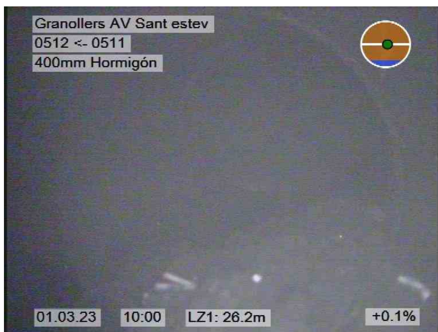
226.jpg, 00:05:24, 26.20m INTERRUPCION POR SUCIEDAD/OBSTRUCCION
