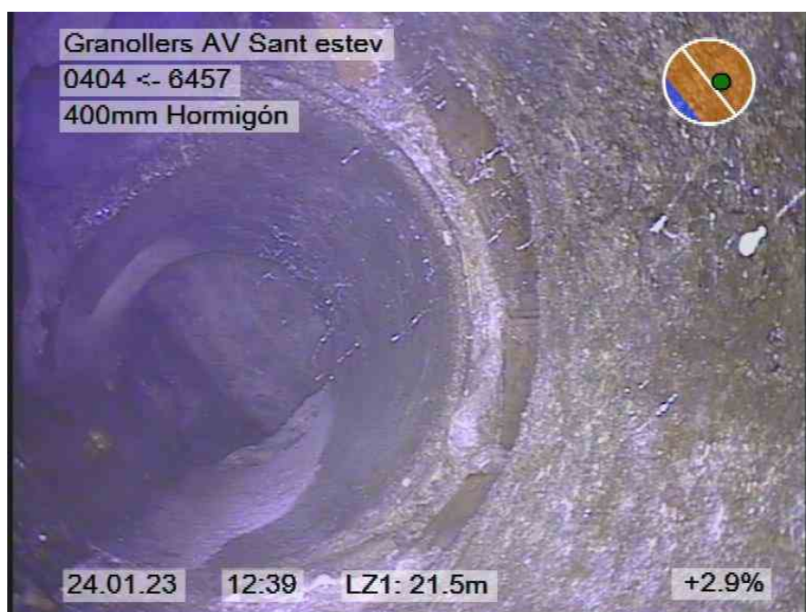
5.jpg, 00:02:00, 22.20m REPARACIÓN CON FABRICA LADRILLO MAL EFECTUADO desde 12 Reloj a 12 Reloj
