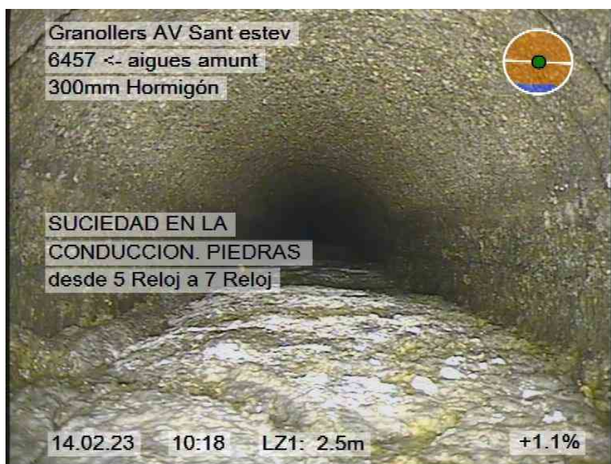
165.jpg, 00:00:12, 2.50m SUCIEDAD EN LA CONDUCCION. PIEDRAS desde 5 Reloj a 7 Reloj
