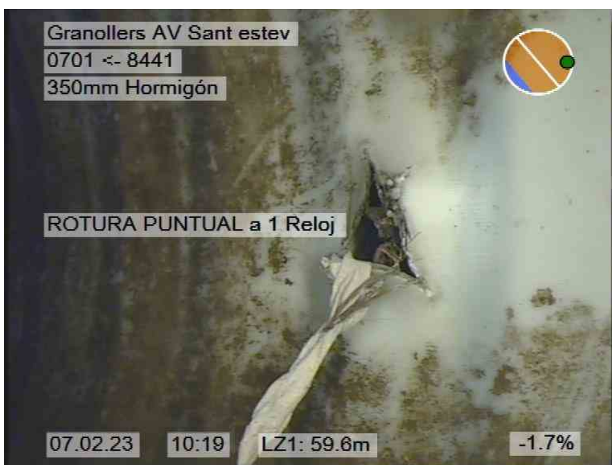
122.jpg, 00:14:13, 59.60m ROTURA PUNTUAL a 1 Reloj
