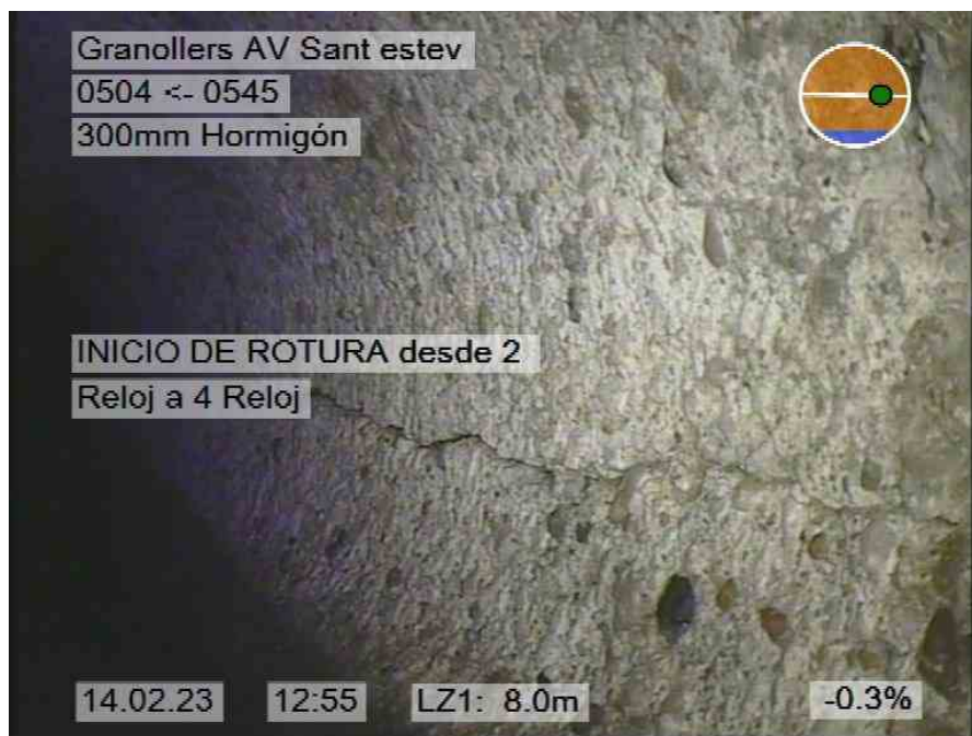
176.jpg, 00:01:10, 8.00m INICIO DE ROTURA desde 2 Reloj a 4 Reloj
