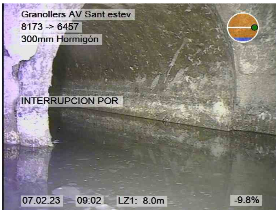
112.jpg, 00:01:14, 8.00m INTERRUPCION POR
