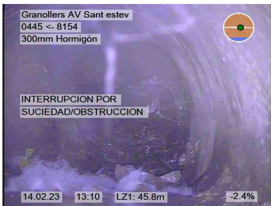
196.jpg, 00:05:13, 45.80m INTERRUPTICION POR SUCIEDAD/OBSTRUCCION
