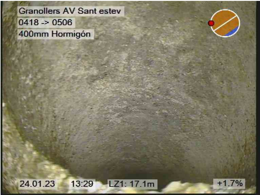
43.jpg, 00:01:35, 16.80m ACOMETIDA SOBRESALIENTE desde 9 Reloj a 10 Reloj
