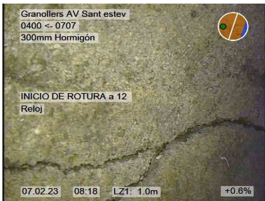
91.jpg, 00:00:35, 1.00m INICIO DE ROTURA a 12 Reloj
