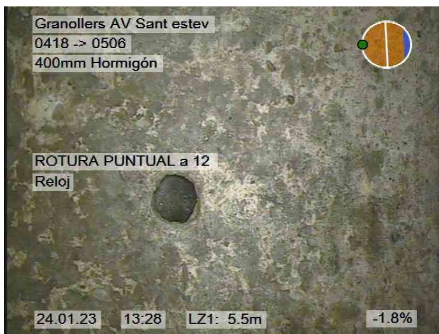
40.jpg, 00:00:28, 5.50m ROTURA PUNTUAL a 12 Reloj
