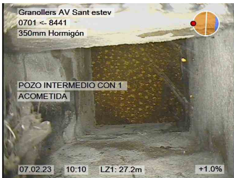
117.jpg, 00:05:33, 27.20m POZO INTERMEDIO CON 1 ACOMETIDA
