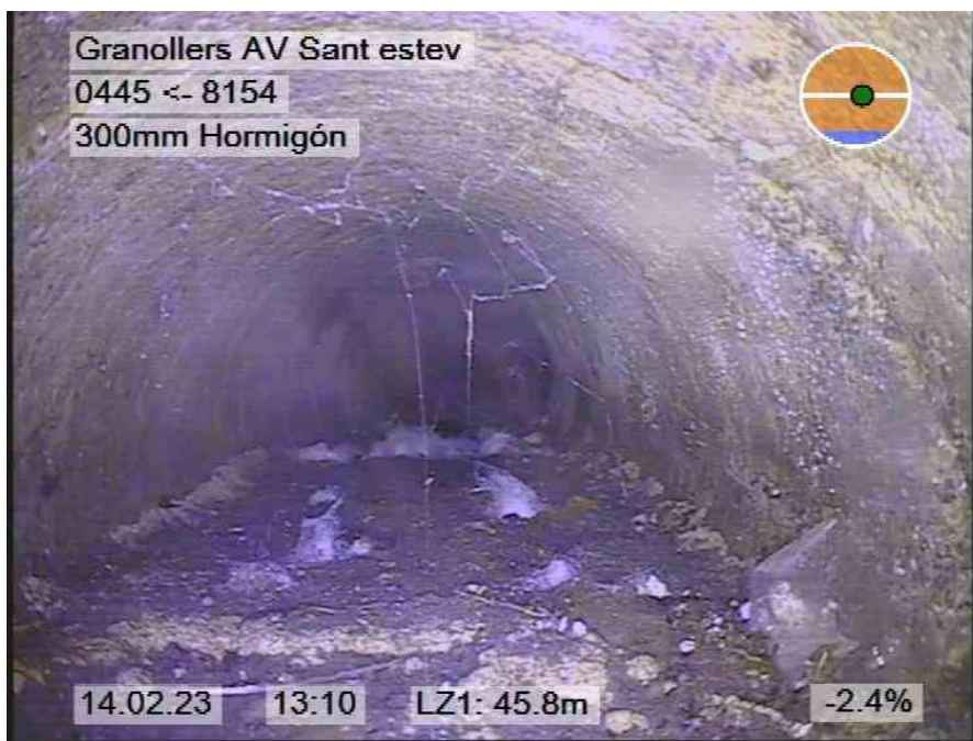
197.jpg, 00:05:13, 45.80m INTERRUPCION POR SUCIEDAD/OBSTRUCCION
