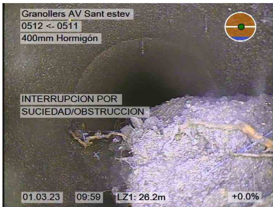
225.jpg, 00:05:24, 26.20m INTERRUPCION POR SUCIEDAD/OBSTRUCCION
