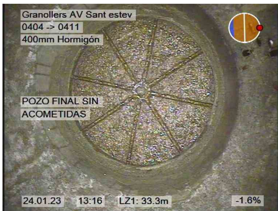
26.jpg, 00:02:40, 33.30m POZO FINAL SIN ACOMETIDAS
