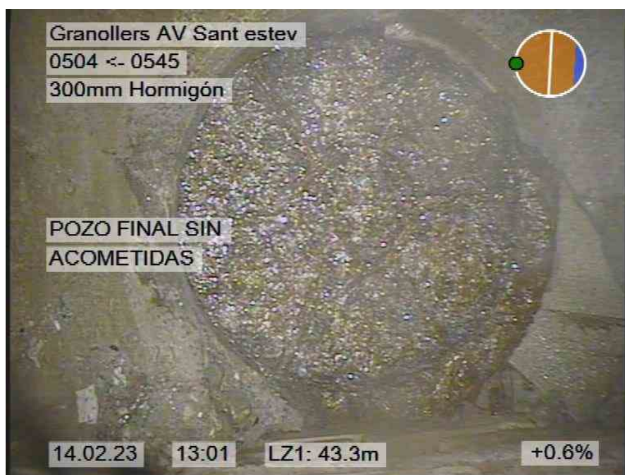
187.jpg, 00:05:33, 43.30m POZO FINAL SIN ACOMETIDAS
