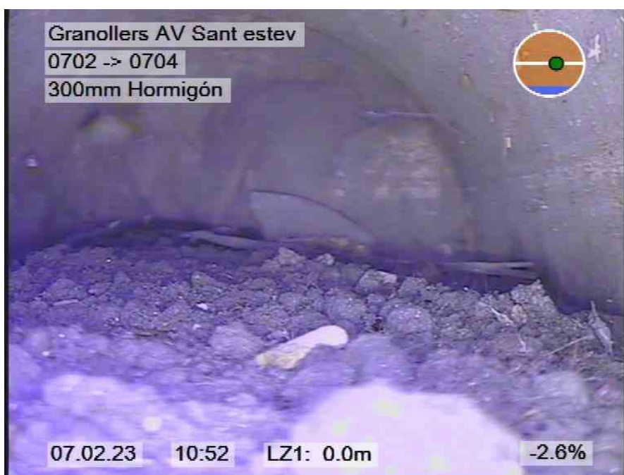
127.jpg, 00:00:31, 0.00m INTERRUPCION POR SUCIEDAD/OBSTRUCCION
