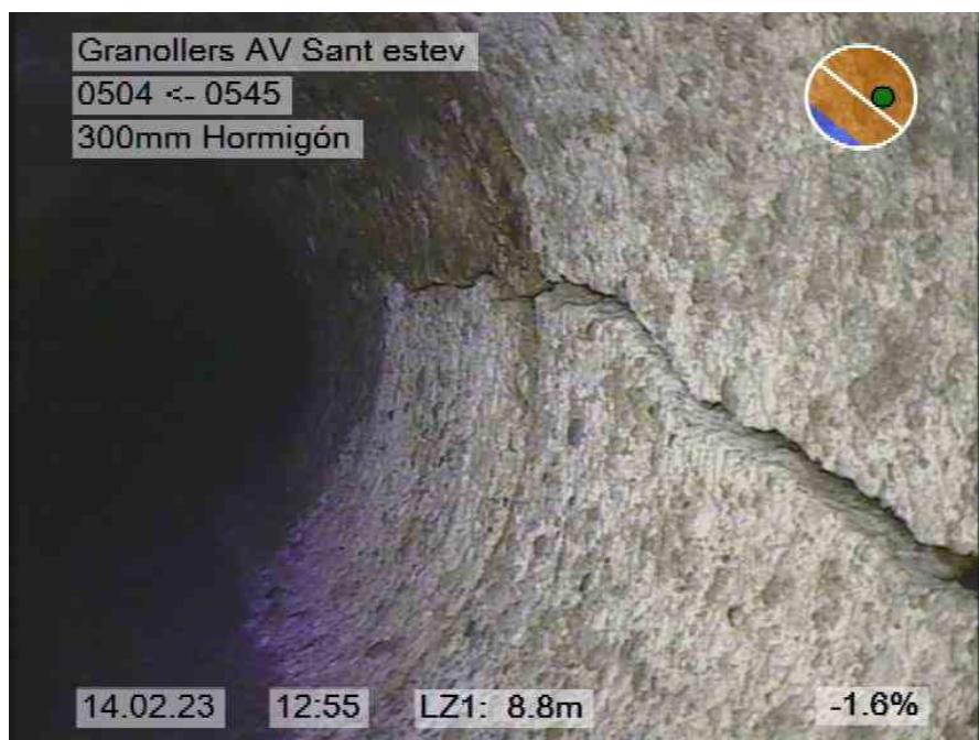
177.jpg, 00:01:10, 8.00m INICIO DE ROTURA desde 2 Reloj a 4 Reloj
