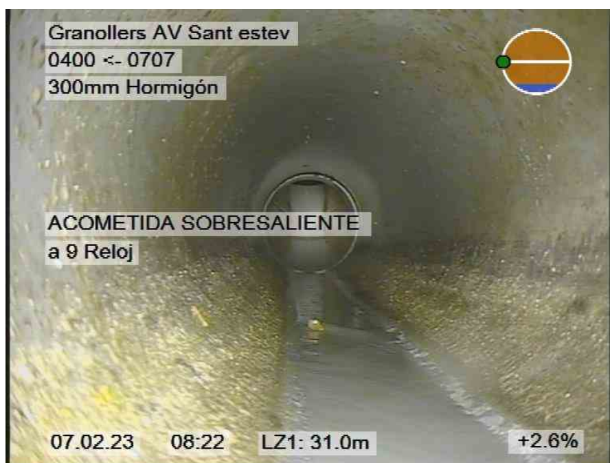
96.jpg, 00:04:15, 31.00m ACOMETIDA SOBRESALIENTE a 9 Reloj
