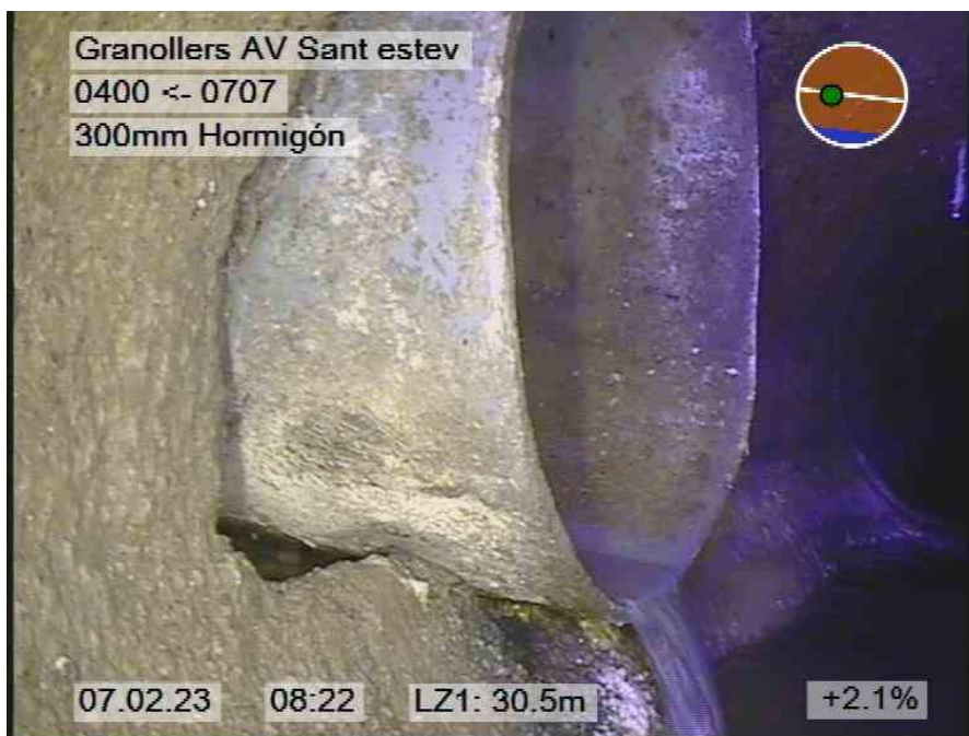
97.jpg, 00:04:15, 31.00m ACOMETIDA SOBRESALIENTE a 9 Reloj
