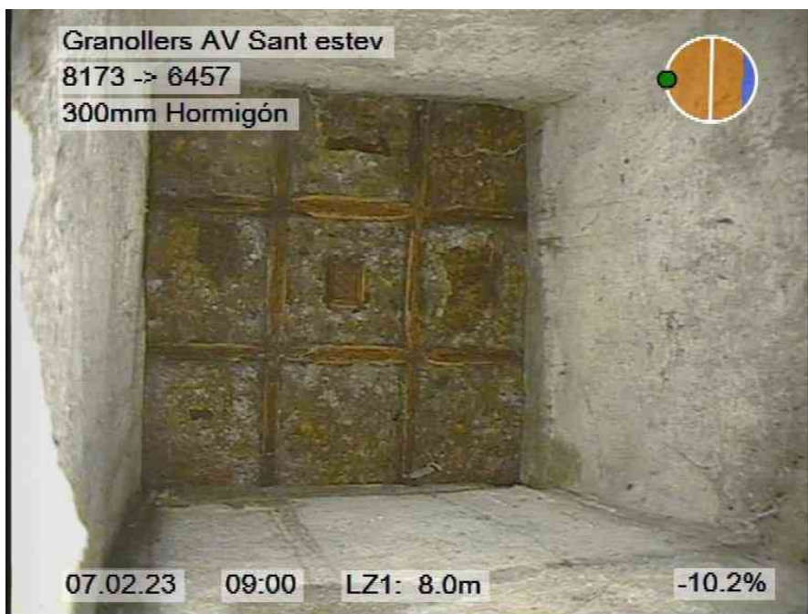
111.jpg, 00:00:54, 8.00m POZO INTERMEDIO CON 1 ACOMETIDA
