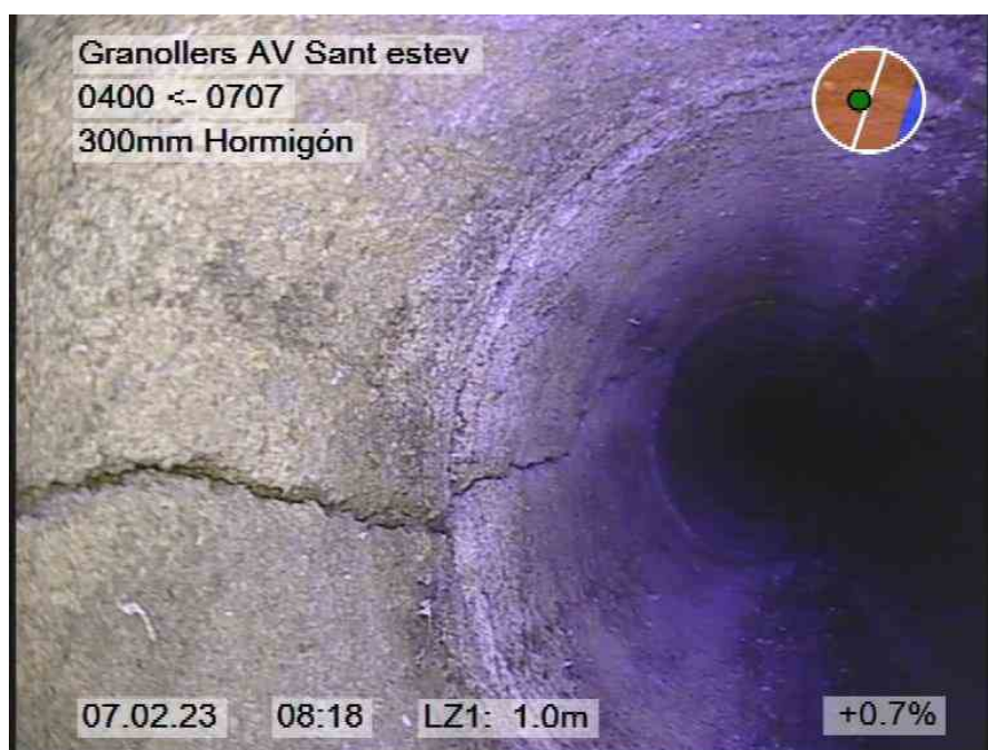
92.jpg, 00:00:35, 1.00m INICIO DE ROTURA a 12 Reloj
