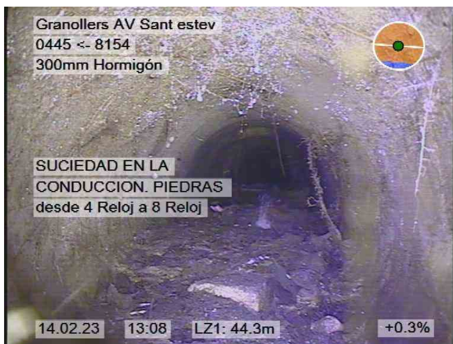
194.jpg, 00:03:34, 44.30m SUCIEDAD EN LA CONDUCCION. PIEDRAS desde 4 Reloj a 8 Reloj
