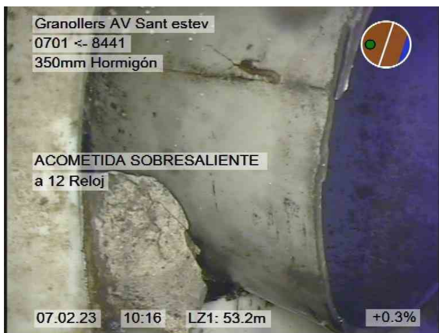
120.jpg, 00:10:46, 53.20m ACOMETIDA SOBRESALIENTE a 12 Reloj
