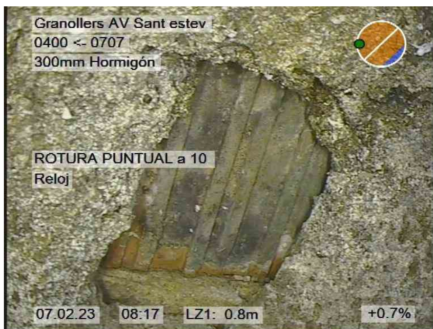
90.jpg, 00:00:22, 0.80m ROTURA PUNTUAL a 10 Reloj
