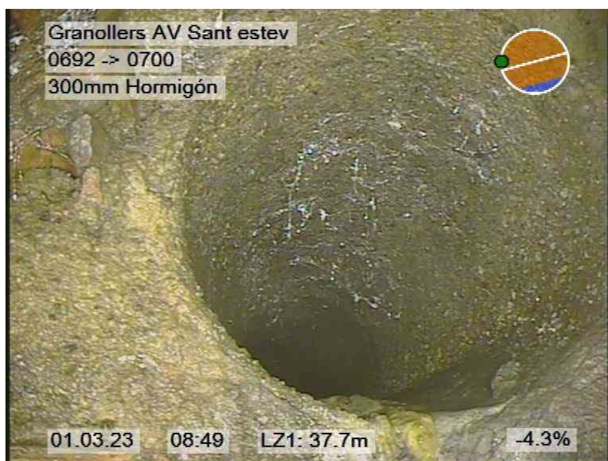
215.jpg, 00:10:06, 37.70m POZO INTERMEDIO CON 1 ACOMETIDA
