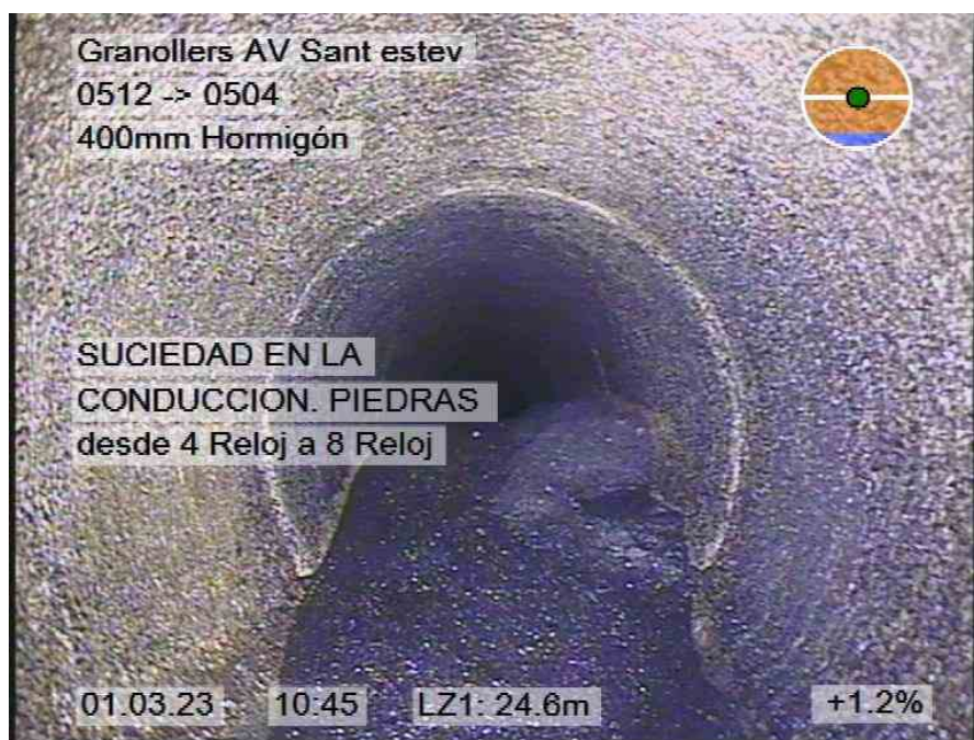
229.jpg, 00:02:21, 24.60m SUCIEDAD EN LA CONDUCCION. PIEDRAS desde 4 Reloj a 8 Reloj
