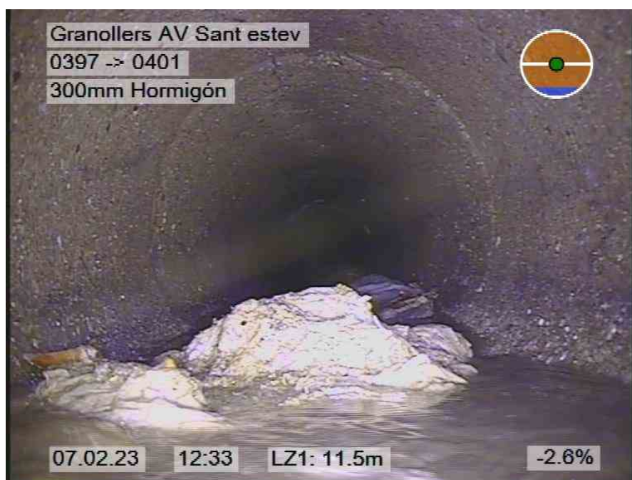
149.jpg, 00:06:49, 12.30m INTERRUPCION POR SUCIEDAD/OBSTRUCCION
