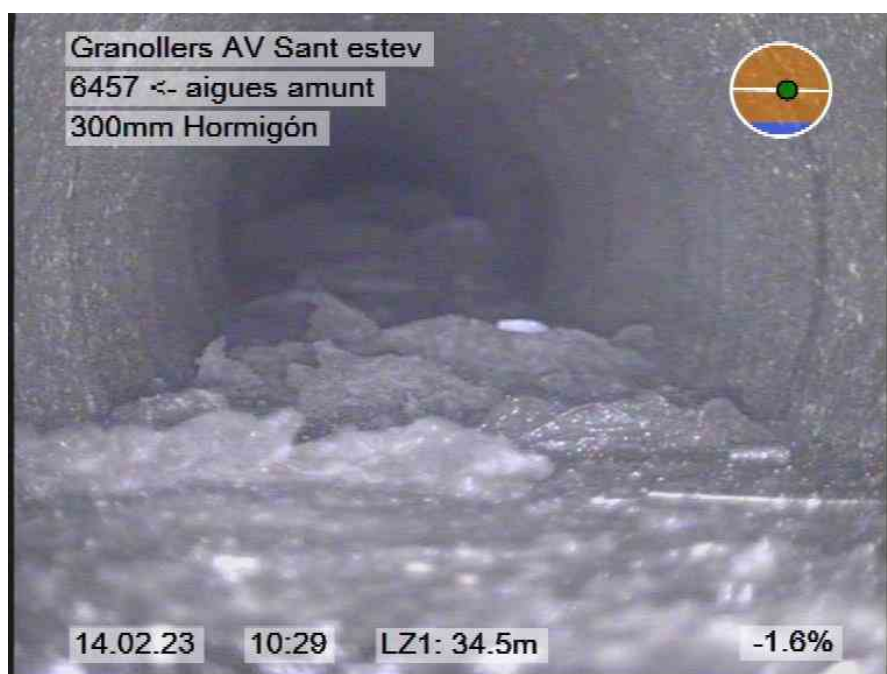
167.jpg, 00:10:50, 34.50m INTERRUPCION POR SUCIEDAD/OBSTRUCCION
