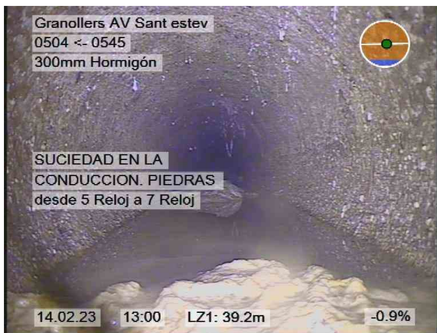
186.jpg, 00:04:57, 39.20m SUCIEDAD EN LA CONDUCCION. PIEDRAS desde 5 Reloj a 7 Reloj
