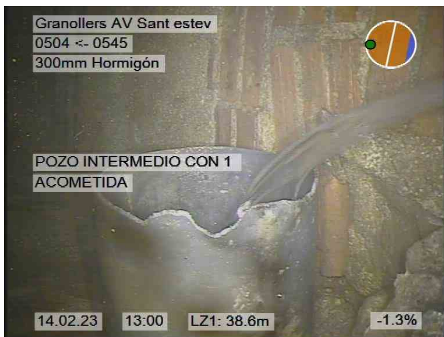
184.jpg, 00:04:43, 38.60m POZO INTERMEDIO CON 1 ACOMETIDA
