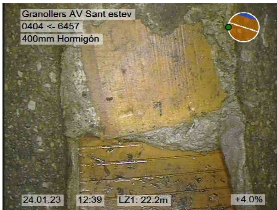
4.jpg, 00:02:00, 22.20m REPARACIÓN CON FABRICA LADRILLO MAL EFECTUADO desde 12 Reloj a 12 Reloj
