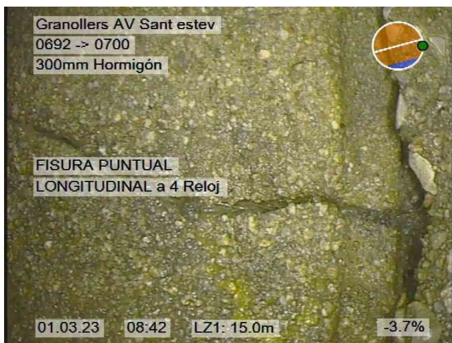
209.jpg, 00:06:49, 15.00m FISURA PUNTUAL LONGITUDINAL a 4 Reloj
