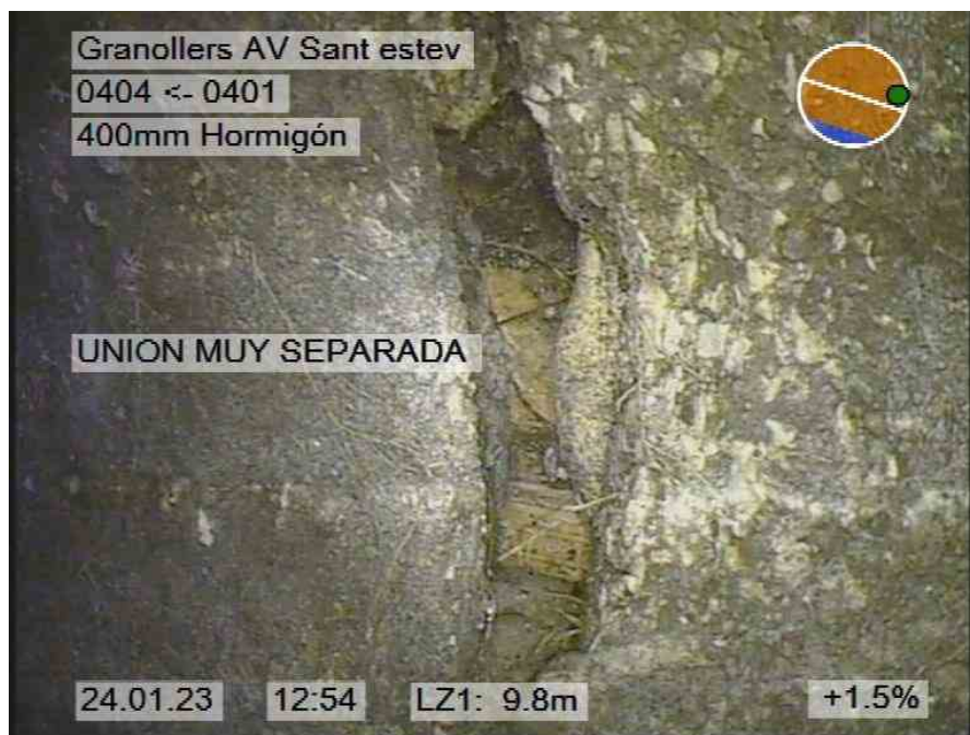
14.jpg, 00:01:27, 9.80m UNION MUY SEPARADA
