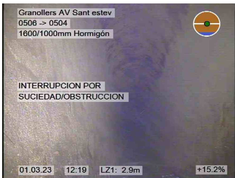
234.jpg, 00:01:27, 2.90m INTERRUPCION POR SUCIEDAD/OBSTRUCCION
