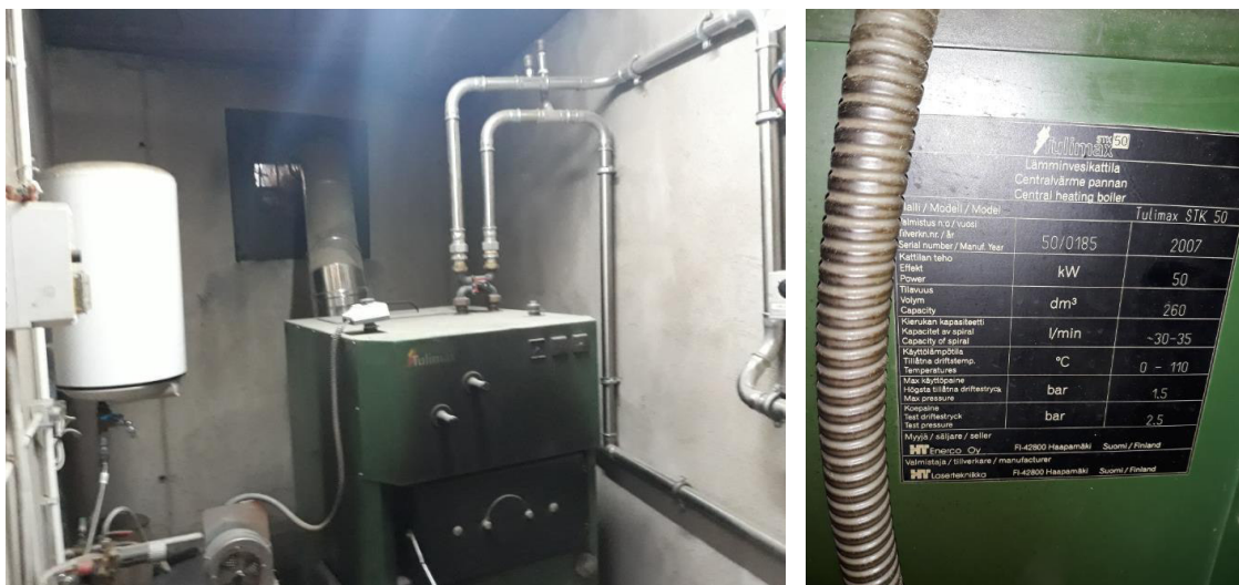
Imatge 9: Caldera de biomassa de 50kW existent a l'edifici d'Agents Rurals.
