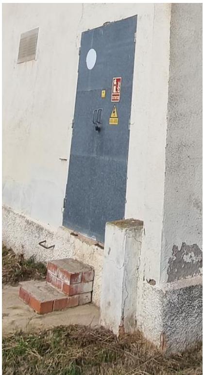
Porta accés centre BT a substituir
