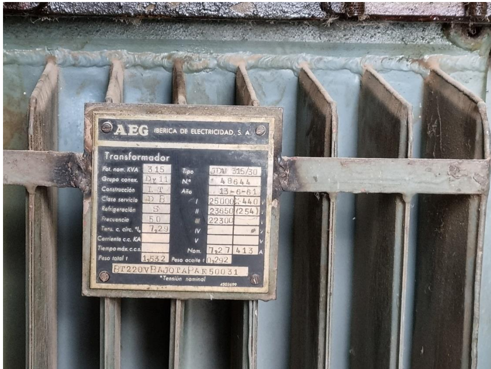
Placa del trasnformador a retirar
