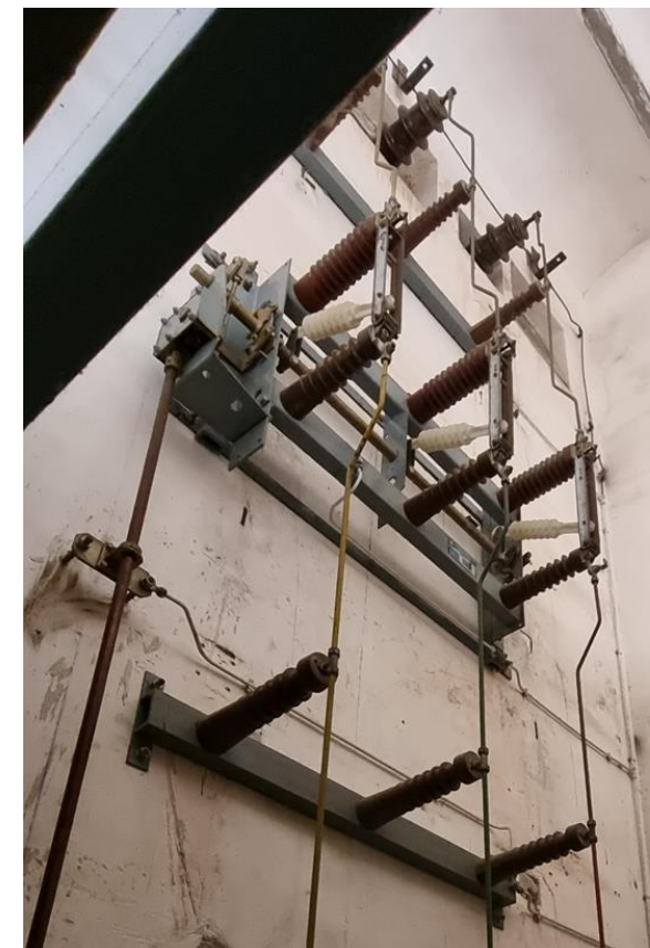
Aparellatge alta tensió existent
