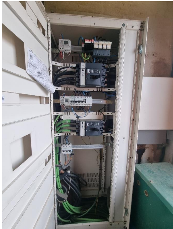
Quadre de Baixa tensió existent
