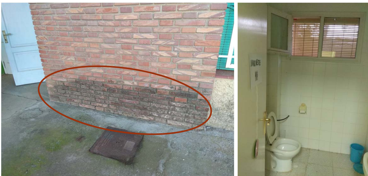
Vista de les humitats en sòl causades per la manca de canal de recollida d'aigües en coberta i bany
