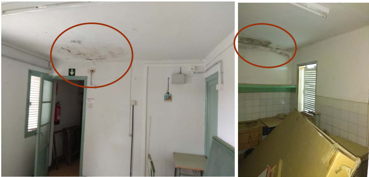
Vista de les humitats en sostre de planta primera provocades pel mal estat de la coberta
