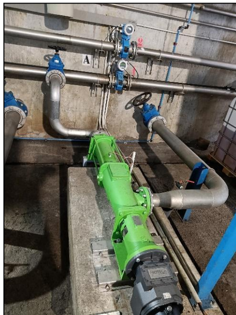
Imatge 3.- Bomba A de fangs a centrífuga.
