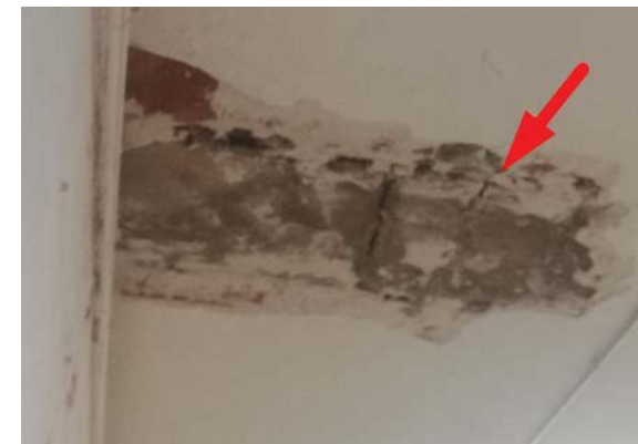
In 23: Armadures amb corrosió i recobriment escàs
