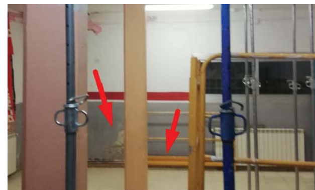
In 18: Humitats en la base del mur.
