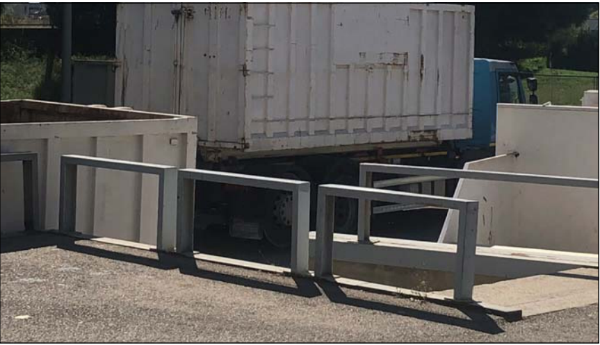
Protecció tipus caiguda a diferent desnivell
