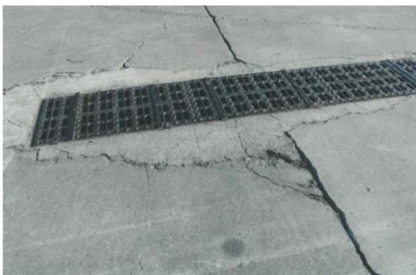
Fotografia zona paviment mal estat
