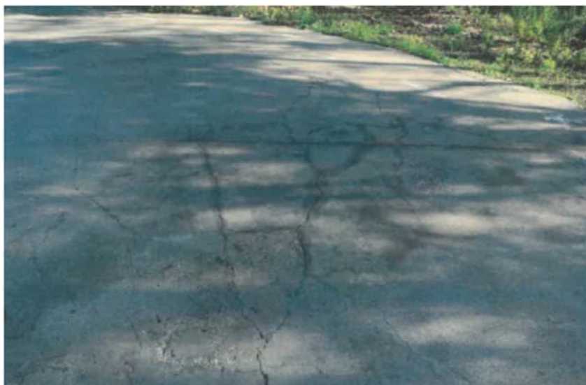
Fotografia zona paviment mal estat
