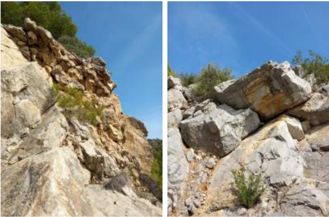
Figura 12. Detall de masses rocoses (multiblocs) potencialment inestables identificats al talús
