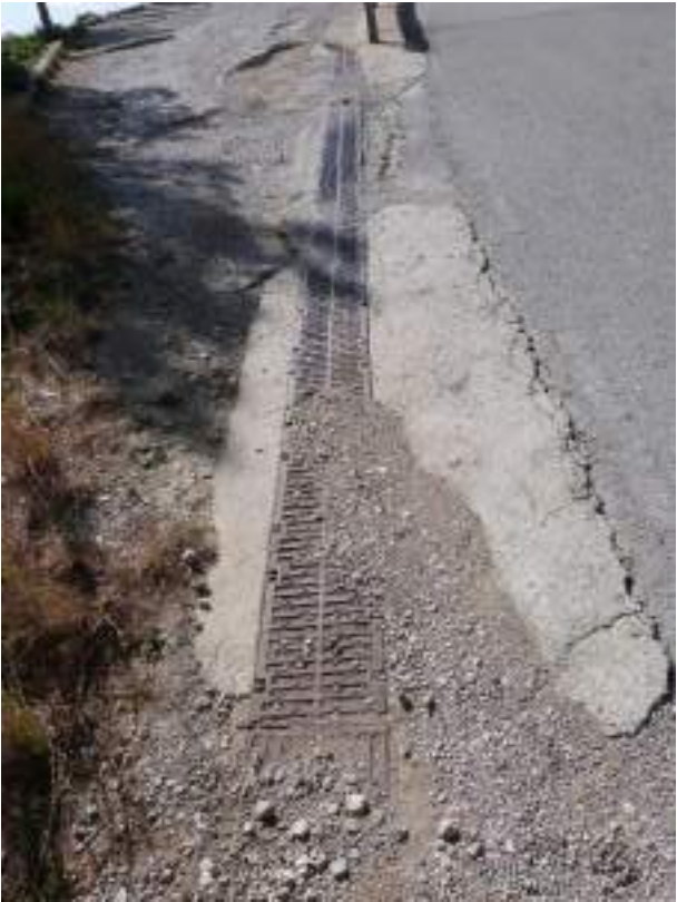
Figura 5. Estat actual de la reixa del drenatge longitudinal (PK 1+774 al 1+782)
