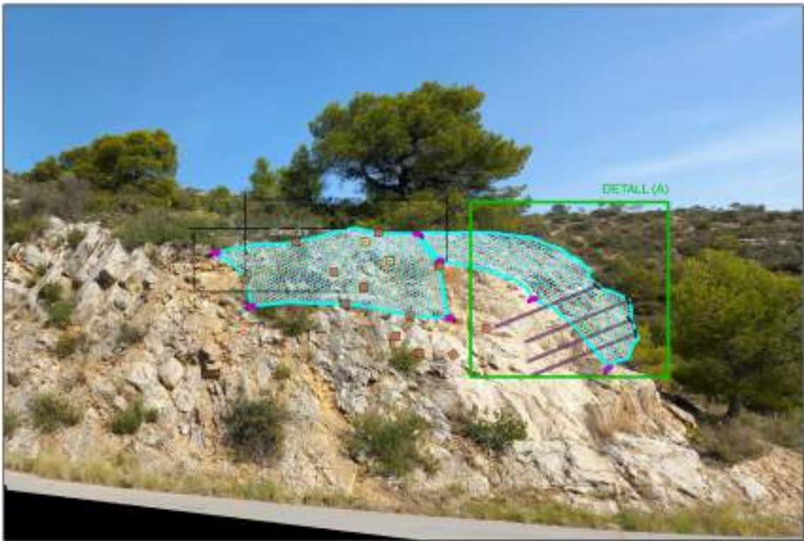
Figura 3. detall del talús PG01TA13D en tram final en recta. ICGC 2022
