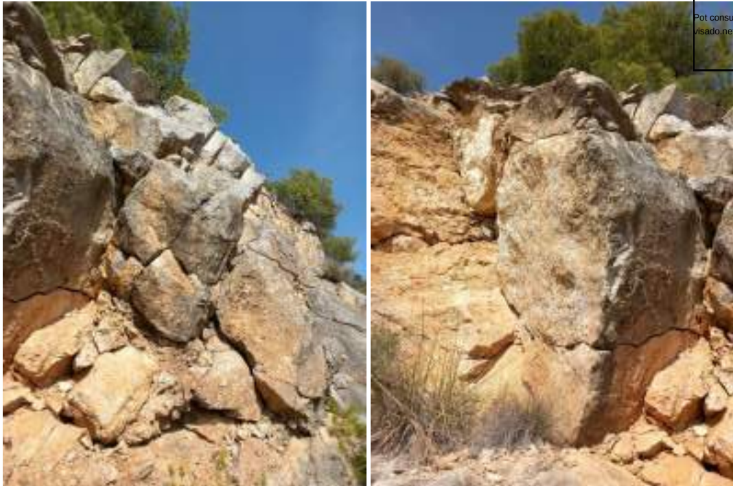
Figura 11. Detall de masses rocoses (multiblocs) d'ordre mètric potencialment inestables identificats al talús
