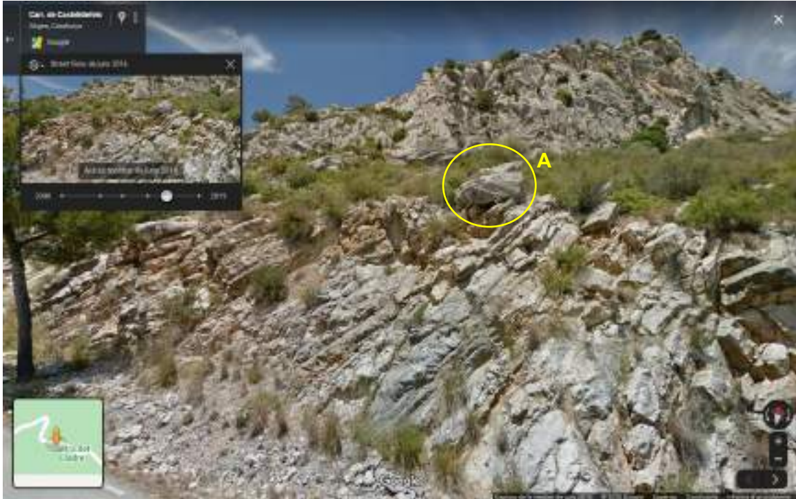
Figura 4. Despreniment < 1t datat entre l'any 2016 i el 2019. Foto comparativa del 2016.
