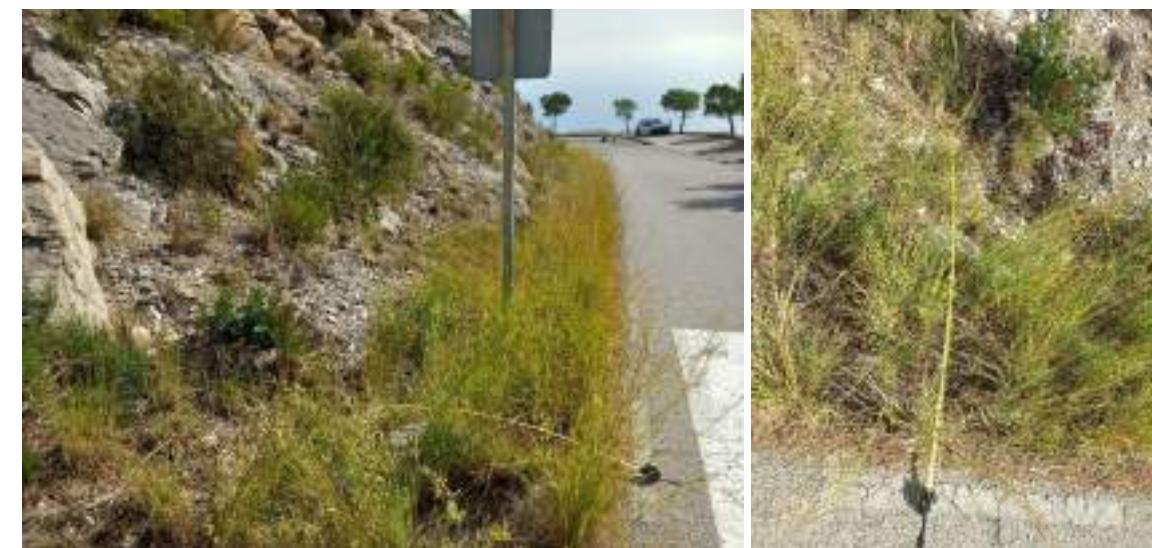
Figura 8. Aspecte de la cuneta al peu del talús PG01TA13D a diferents punts del traçat
