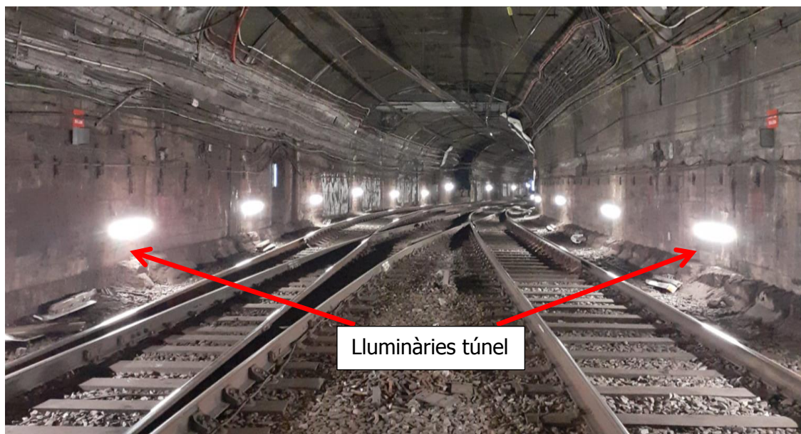
Fig.A1.2.- Ubicació lluminàries túnel
