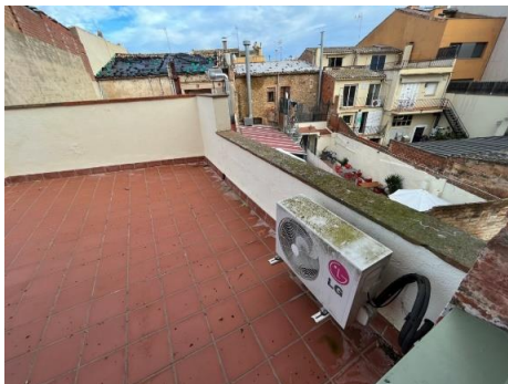
*Unitats exteriors i interior de sistemes de bomba calor per aire.
