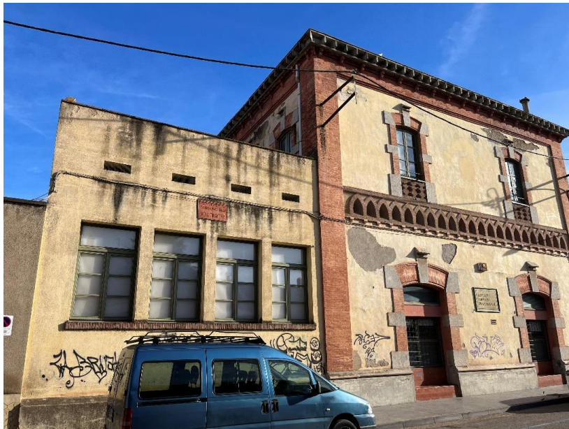
*Façana principal bloc Nord amb presència d'escorrenties i despeniments d'estuc.
