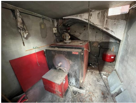
*Habitacle amb caldera i radiadors de ferro colat a planta baixa edifici Nord.
