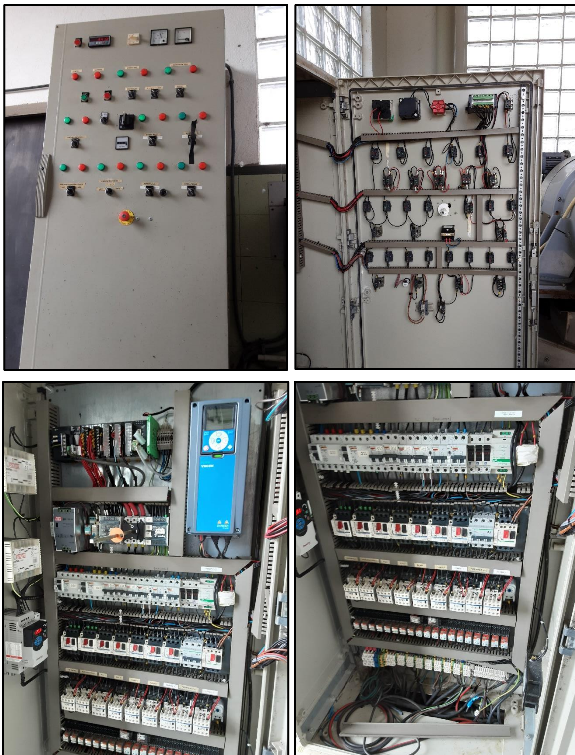
Imatge 3:- Estat actual del quadre elèctric
