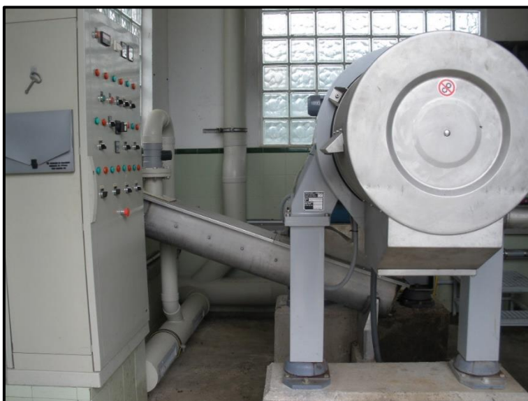
Imatge 2 – Ubicació actual del quadre elèctric dins la sala de deshidratació
