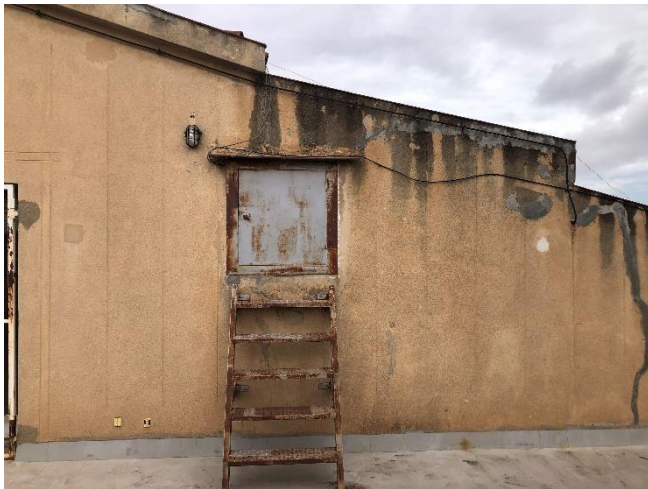
Accés a sala tècnica ascensors
