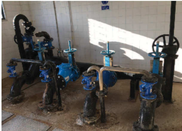
Interior Estació de bombament (grup electrogen i quadre elèctric)
