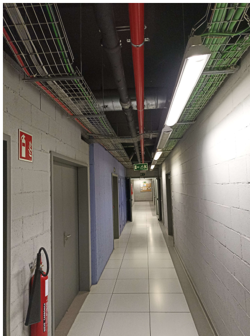
Imatge 27. Safata cap a la sala de transformació
