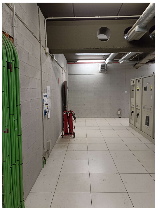
Imatge 28. Entrada a la sala de transformació
