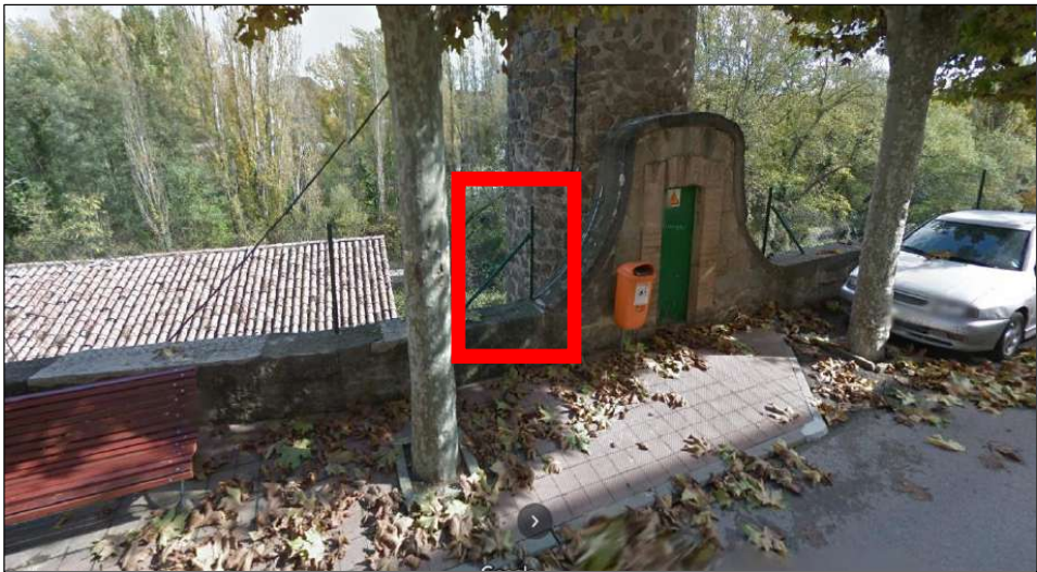
Imatge 6.- Nova ubicació del quadre Q04.
