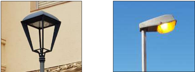
Imatge 4.- Enllumenat viari ambiental (esquerra) i funcional (dreta).
