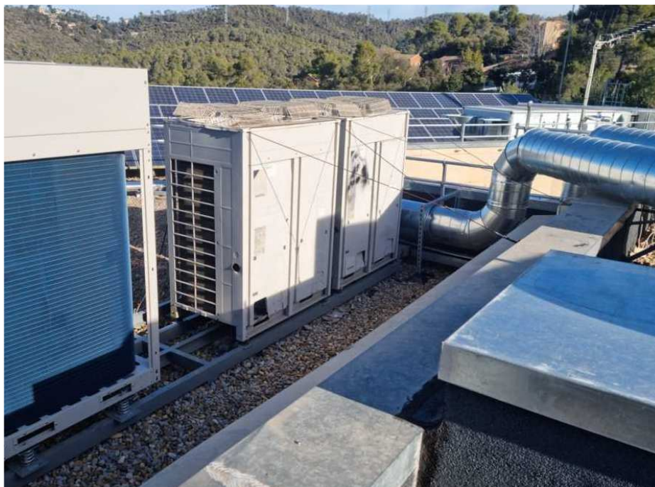
Unitat exterior Àmbit A
