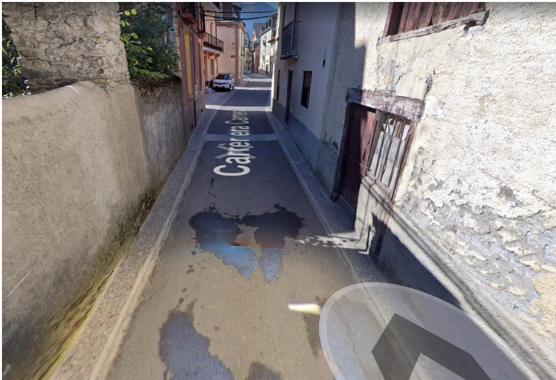
Imatge 2. Tram de carrer amb visibles esquerdes al ferm asfàltic.
