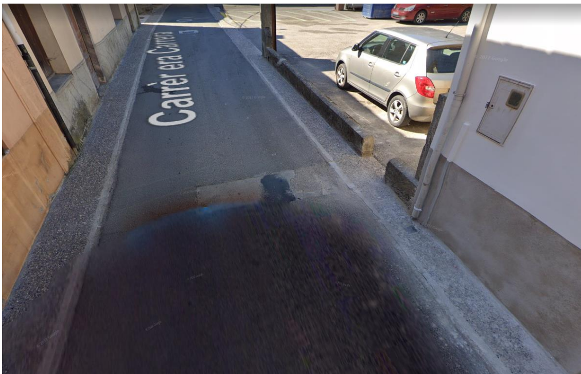
Imatge 3. Secció de ferm apedaçat per una reparació o actuació de manteniment al carrer Carrera.
