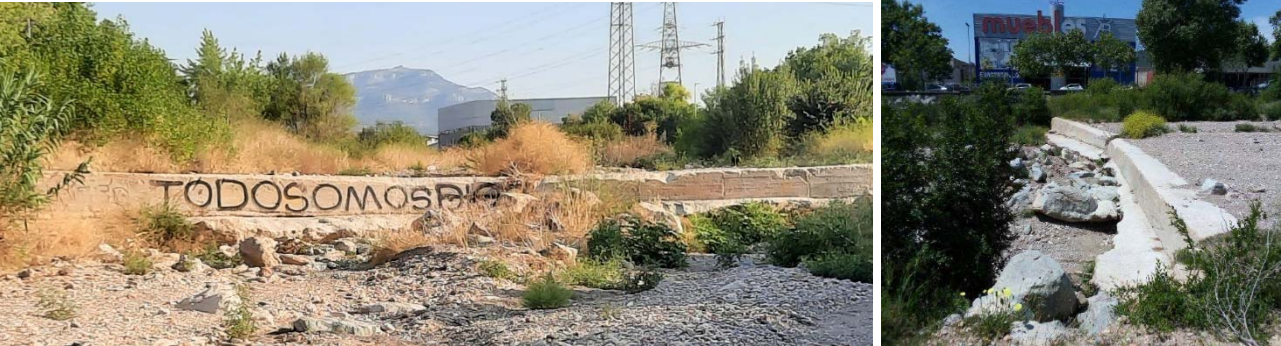
Figura 4. Erosions al peu de la travessa de la zona dels Bellots
