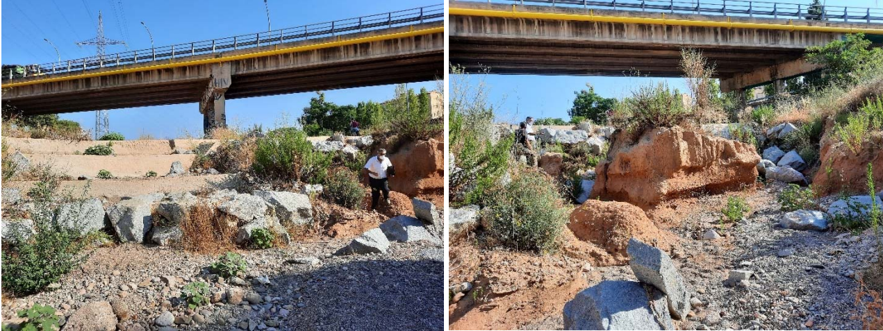
Figura 3. Erosions aigües avall del Pont Montserrat
