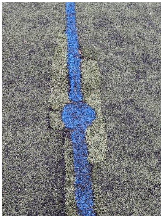
Imatge 9. Detall defectes existents
