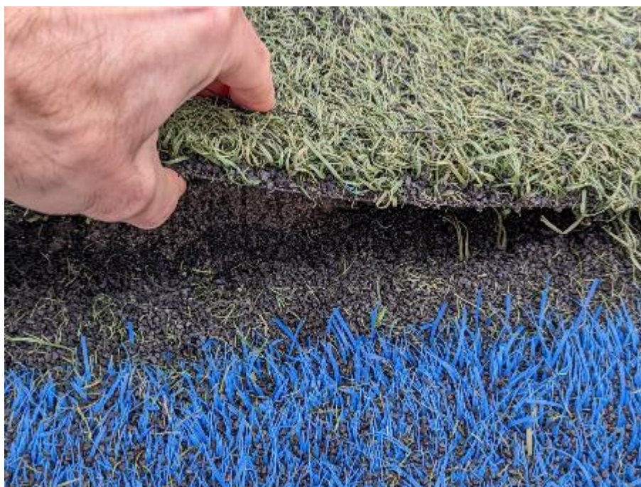
Imatge 10. Detall defectes existents
