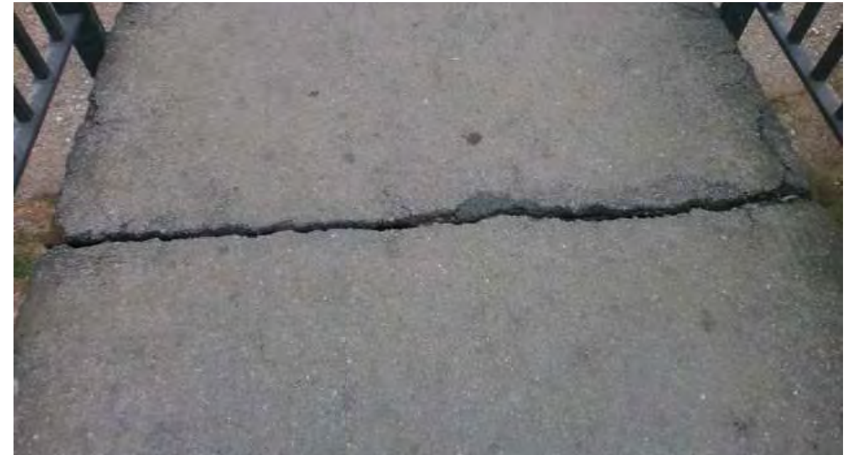
F6: Detall de la junta de dilatació just a sobre del capitel·l, sense tractament. Es formalitzarà amb una junta de dilatació per a absorbir aquests moviments.
