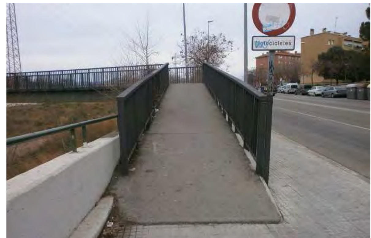
F2: Detall de la rampa, amb la senyalització existent. Aquesta rampa d'enderroca sencera i es fa nova ajustada als requeriments de l'actual normativa d'accessibilitat.
