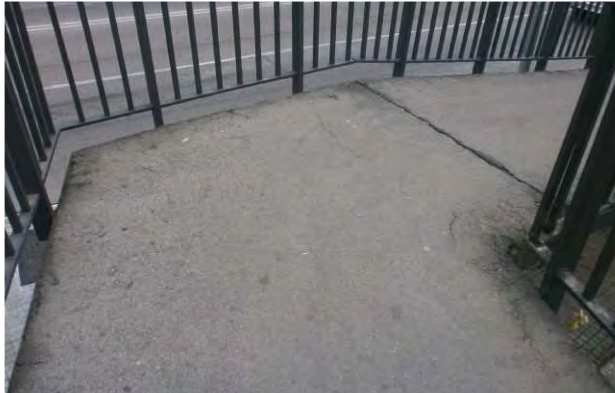
F3: Vista de la junta marcada sobre el paviment asfàltic de la passarel·la. Marca la junta entre l'estructura de la passarel·la metàl·lica i l'inici de l'estructura metàl·lica de la rampa. Aquesta junta no està formalitzada en el paviment existent. S'ha fissurat en el paviment pels moviments tèrmics de les diferents estructures.
