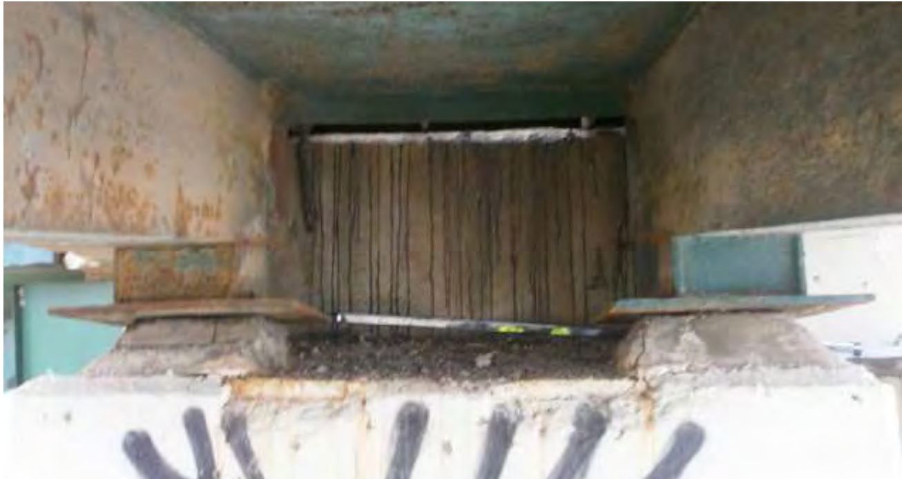
F5: Detall dels recolzaments de les rampes. No hi ha aparell de recolzament de neoprè. Directament sobre les messetes d'anivellació hi ha una prolongació metàl·lica de l'estructura. Evidentment, per la falta de l'aparell de neoprè que sí estava previst al projecte executiu, les messetes es troben en un estat molt deplorable.
