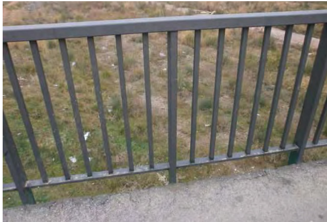
F2: Detall de la barana. La separació entre brèndoles és superior a 10cm, pel què el la memòria valorada es respecten els muntants verticals, el passamà superior i travesser, i es treuen les brèndoles entre muntants. En el seu lloc, es col.locarà una xapa metàl.lica perforada.
