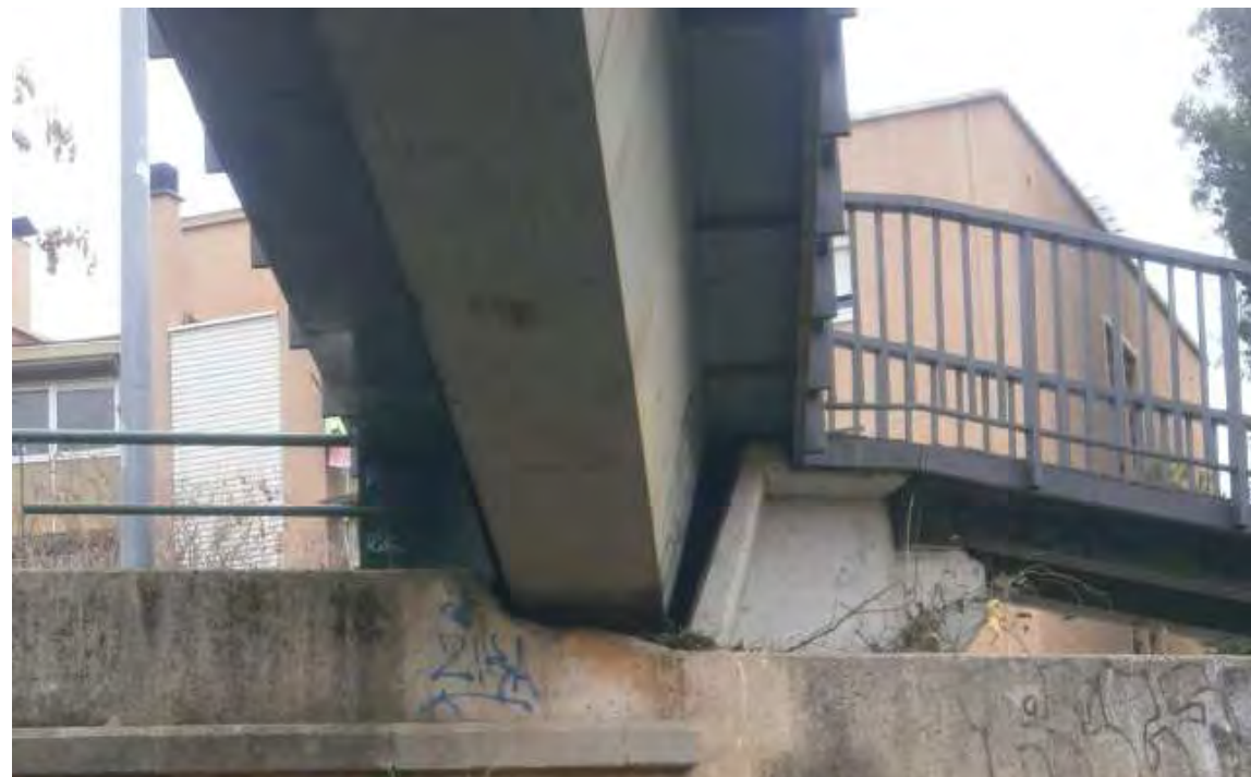
F4: Vista inferior de la passarel·la. Es pot veure la safata de serveis pel costat nord (esquerre de la foto) i les costelles de rigització de la xapa pel costat sud (dreta de la foto).
