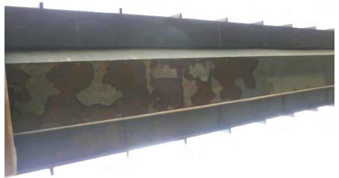
F3: Vista inferior de la passarel.la. Es pot apreciar el grau d'oxidació de la xapa inferior. Es farà un xorreig amb aigua en tota la superfície de xapa de la passarel.la i s'aplicaran pintures específiques per a garantir un nivell mínim de protecció C4.
