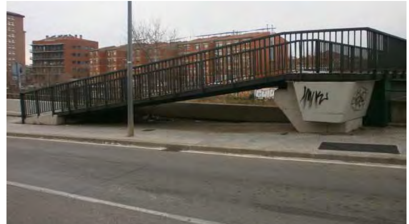
F1: Vista de la rampa d'accés a la passarel·la des del costat del barri de Sant Llorenç. La pendent actual de la rampa supera el màxim establert actualment per la normativa d'accessibilitat.
