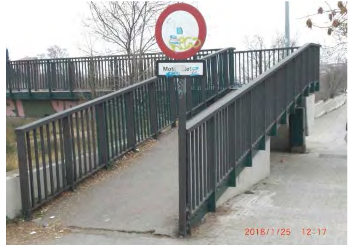
F3: Detall de la rampa, amb la senyalització existent. Aquesta rampa d'enderroca sencera i es fa nova ajustada als requeriments de l'actual normativa d'accessibilitat.
