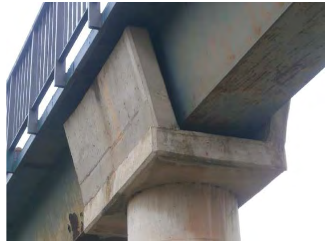
F4: Detall del capitell de formigó armat de la pila central. Hi descansen els dos trams de la passarel.la. Aquest capitell presenta eflorescències per les filtracions d'aigua provinents de la falta de tractament de la junta de dilatació central de l'estructura.
