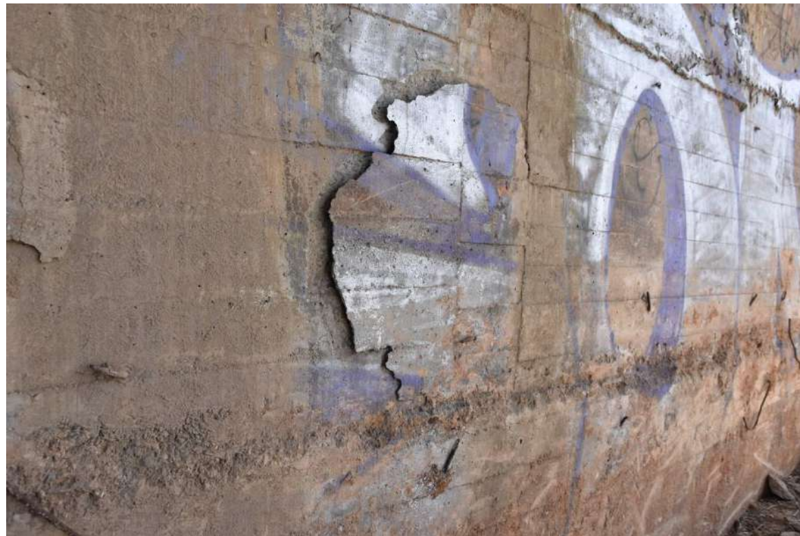
Figura 5. Detall de l'estat del parament de l'estrep 2
