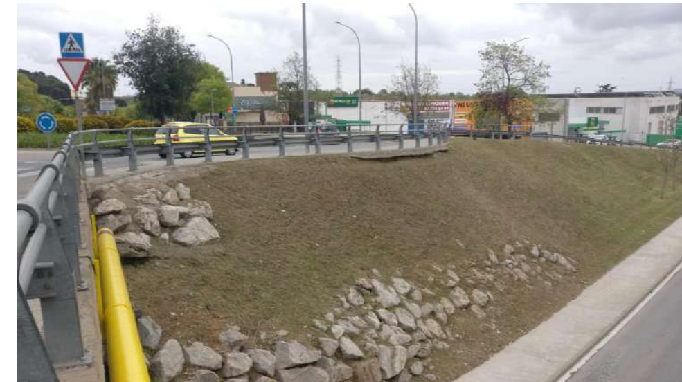
Figura 8. Vista de la vorera descalçada de la rotonda.
