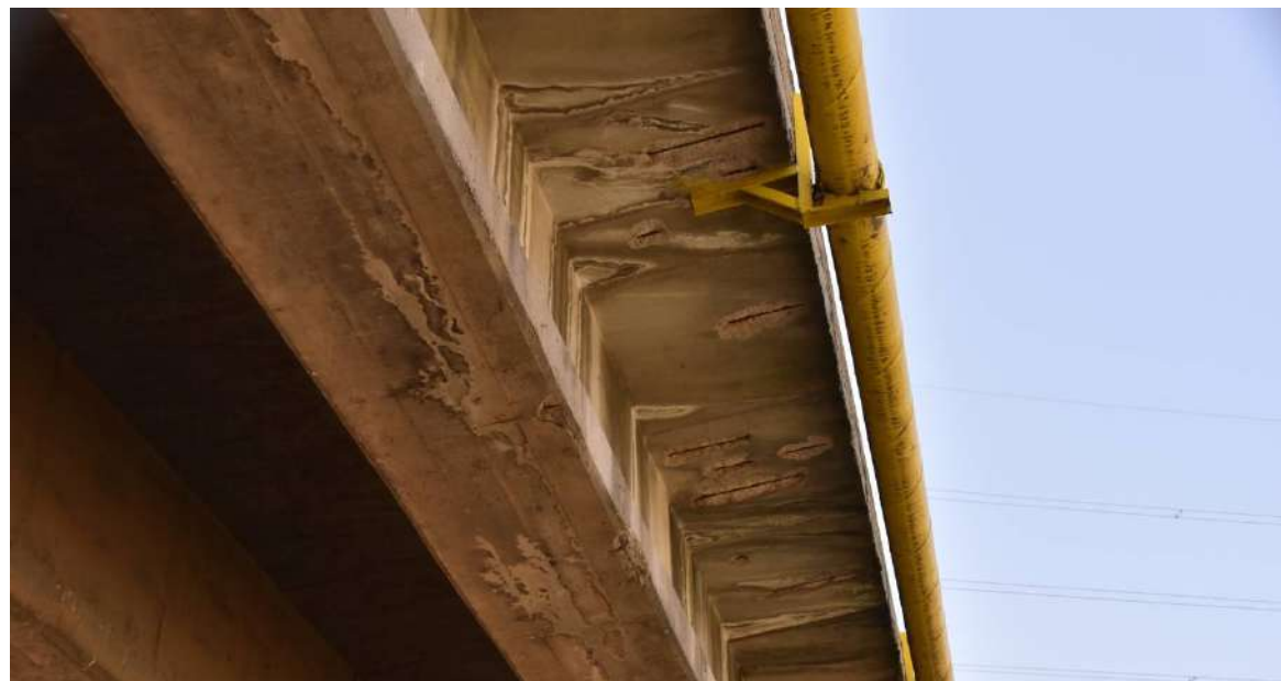
Figura 3. Detall de l'estat del voladís dels trams de bigues
