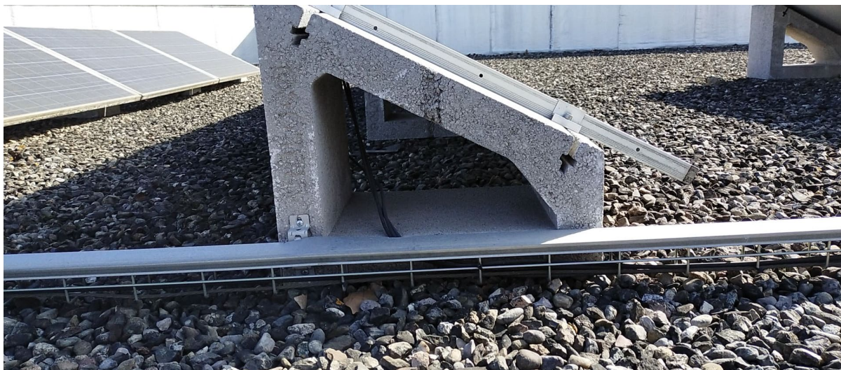
Il·lustració 25 Cablejat de contínua sobre safata metàl·lica
