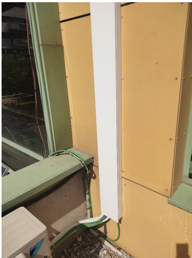
Il·lustració 27 Cablejat DC a la coberta de xapa inclinada
