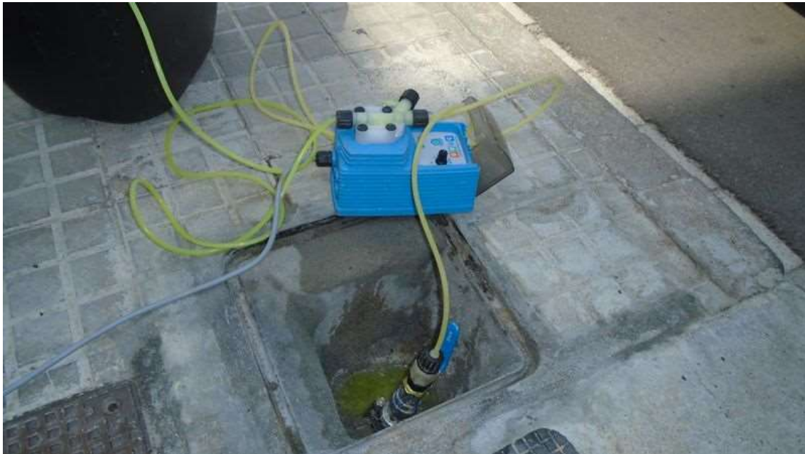
Imatge de presa de desinfecció existent, i procés de desinfecció de xarxa de reg
