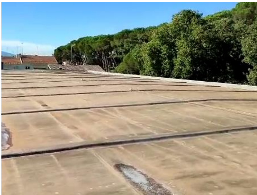
Imatge 3. Estat de la coberta de l'edifici principal
