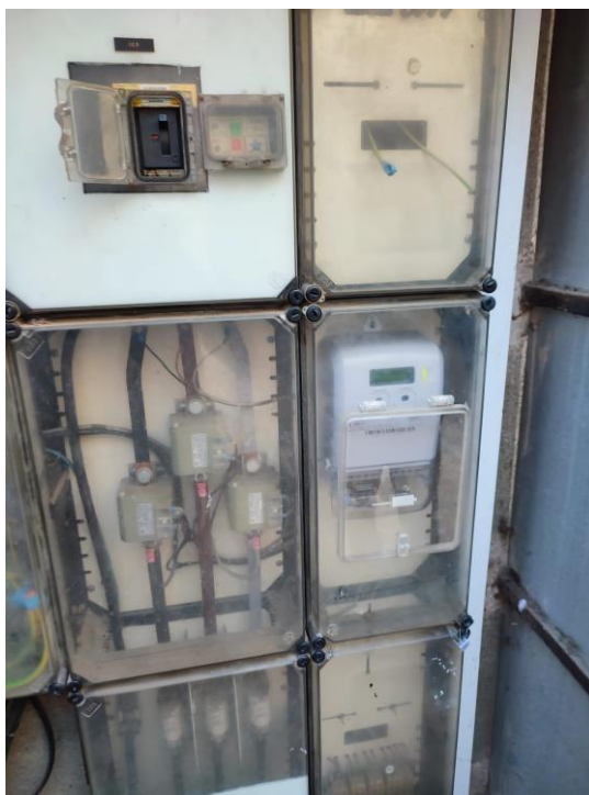
Imatge 17. Embarrat i punt de connexió de la instal·lació fotovoltaica
