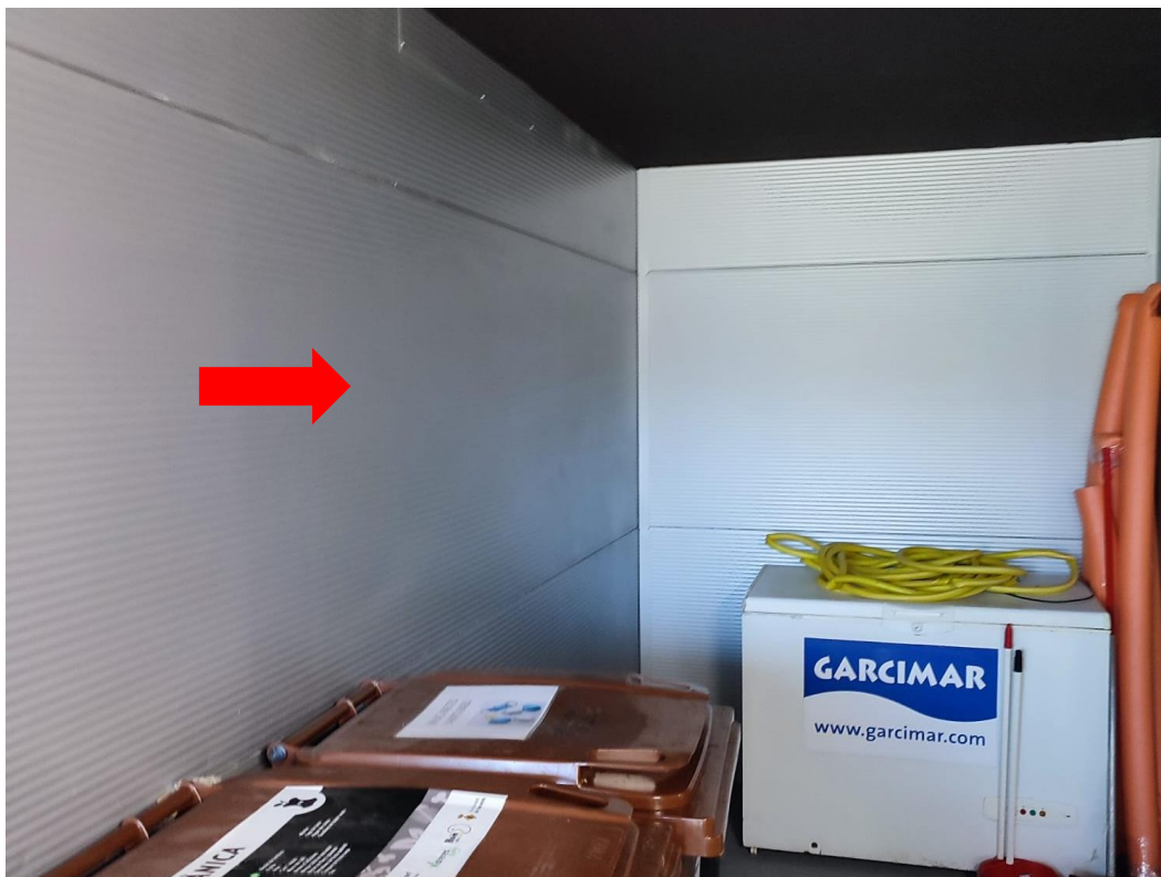
Imatge 4. Ubicació de l'inversor
