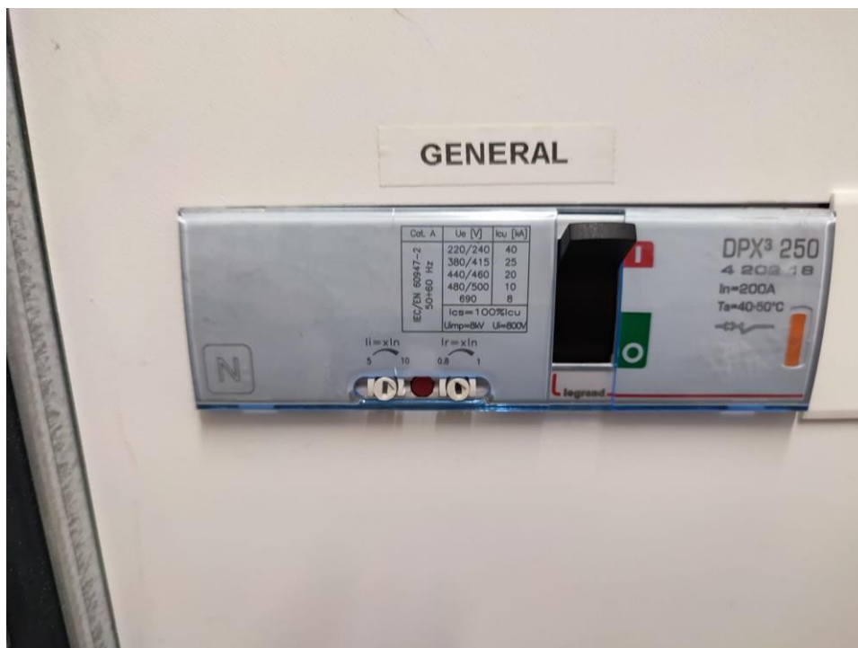
Imatge 18. Interruptor general
