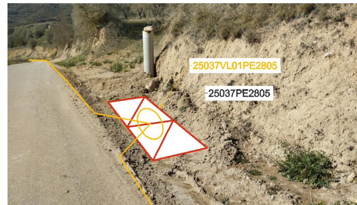
Fig 30. Instal·lació valona 25037VL01PE2805.
